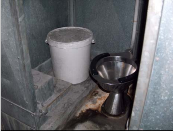
Photo 19: Spültoiletten auf diversen Sohlen (hier 553-m-Sohle), Proben A29 bis A33
