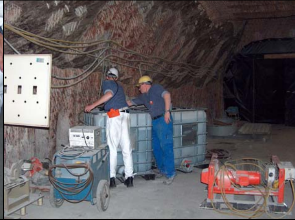
Photo 08: 490-m-Sohle, E-Werkstatt, 1-m 3 -TB Handwaschwasser; Proben A10&A11
