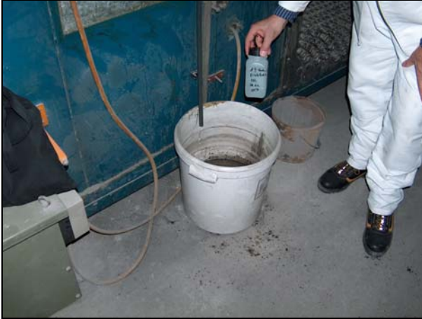
Photo 07: 490-m-Sohle, E-Werkstatt, Eimer mit Kondensat Klimaanlage; Probe A9
