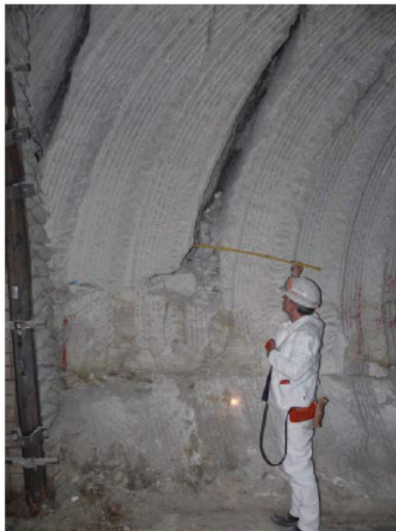
Abb. 2.5-6 Querschlägige (Nord-Süd) Risse im Pfeiler zwischen den Abbauen 3 und 4 auf der 725-m-Sohle (Bild 16 aus /12/)
