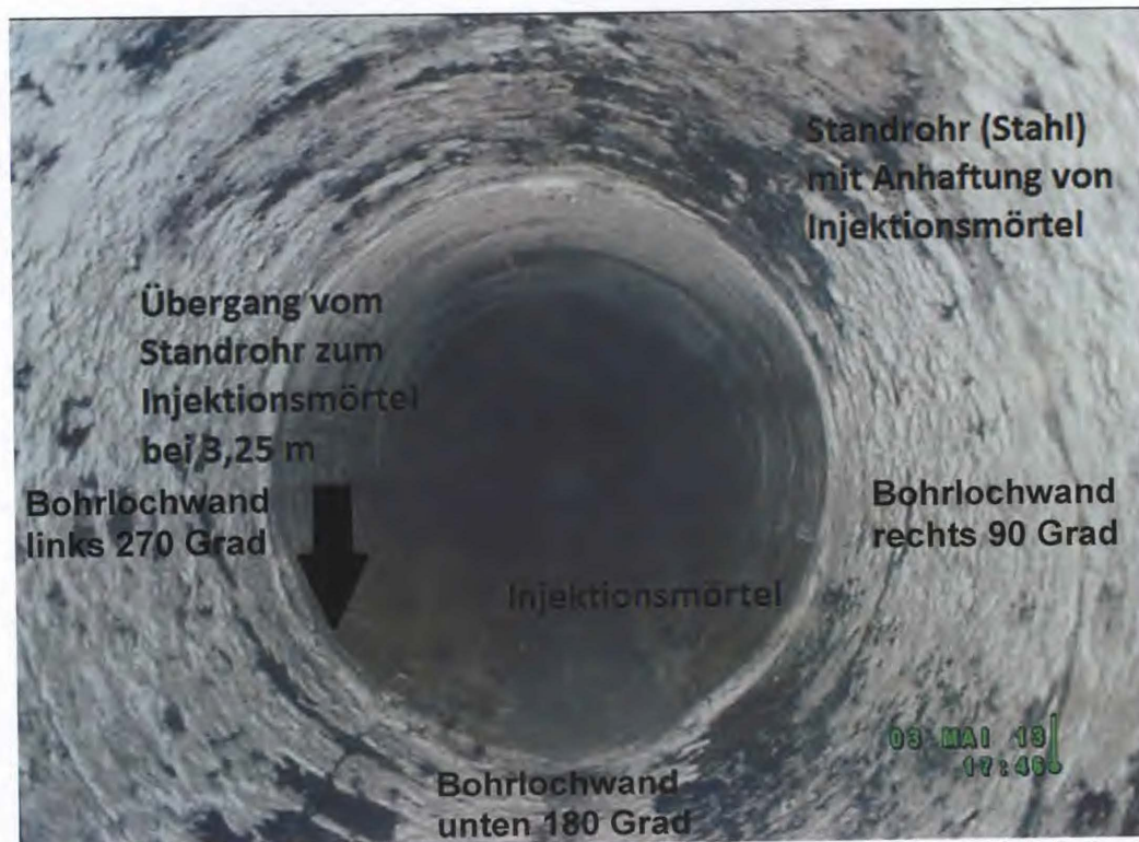
Abbildung 3: Das Bohrlochbild der Messfahrt vom 03.05.2013 zeigt die trockene Bohrlochsohle bei dem Übergang vom Standrohr zum Injektionsmörtel in einer Bohrteufe von 3,25 m
