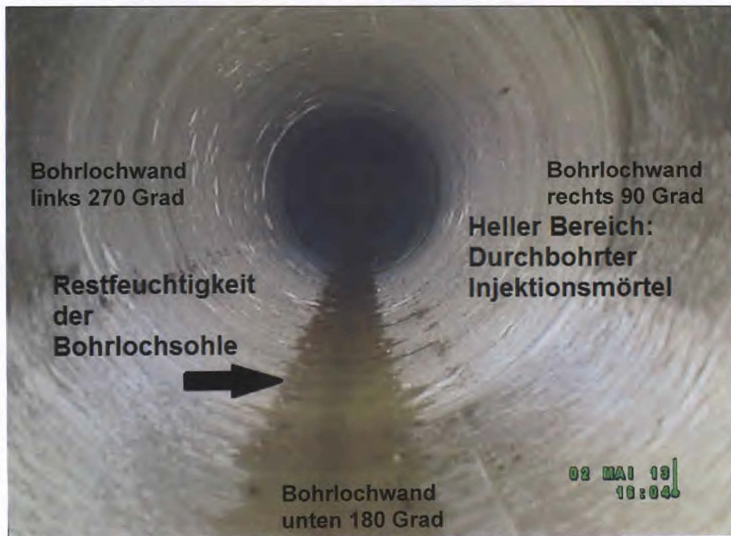
Abbildung 2: Das Bohrlochbild der Messfahrt vom 02.05.2013 zeigt Restfeuchtigkeit auf der Bohrlochsohle in einer Bohrteufe von 3,00 m (Kamerakopf)
