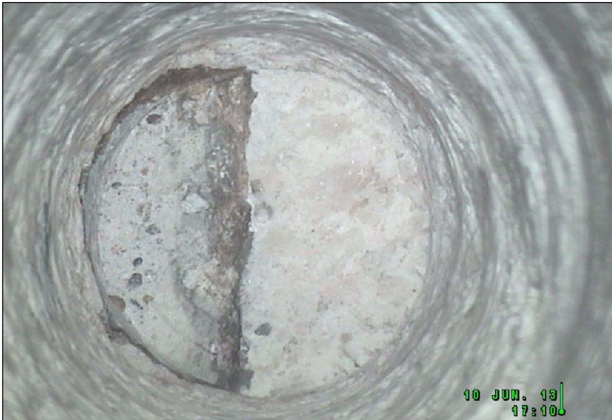
Abbildung 7: B 7/750-A3, Bohrteufe 23,2 m, Aufnahme vom 10.06.2013, rechte Seite Versatzmaterial, linke Seite Betonstruktur
