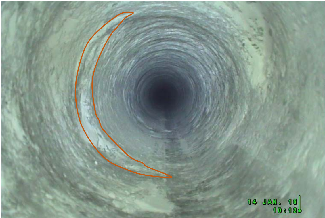
Abbildung 18: Position des Kamerakopfs bei 35,00m, offene Kluft bei 35,18 m erkennbar (brauner Umriss)
