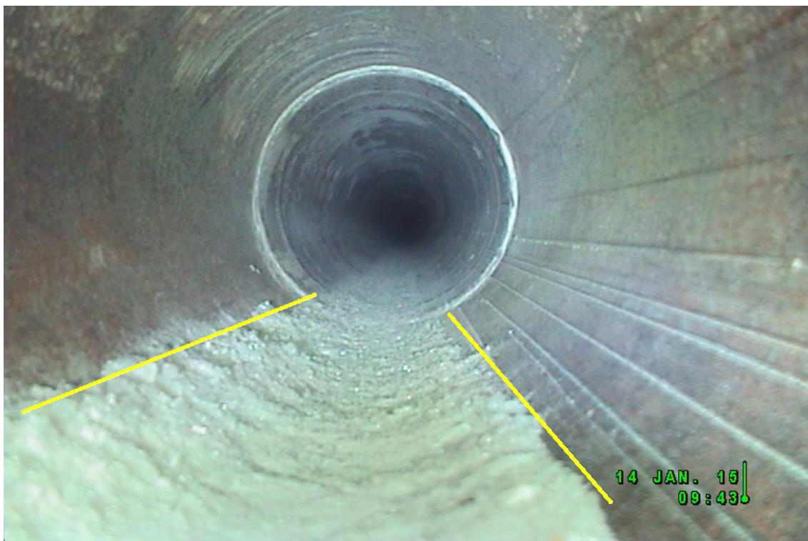
Abbildung 2: Position des Kamerakopfs bei 0,00 m, Verunreinigung des Standrohrs durch Salzgrus im Bereich von 170° bis 210° (gelbe Linien)
