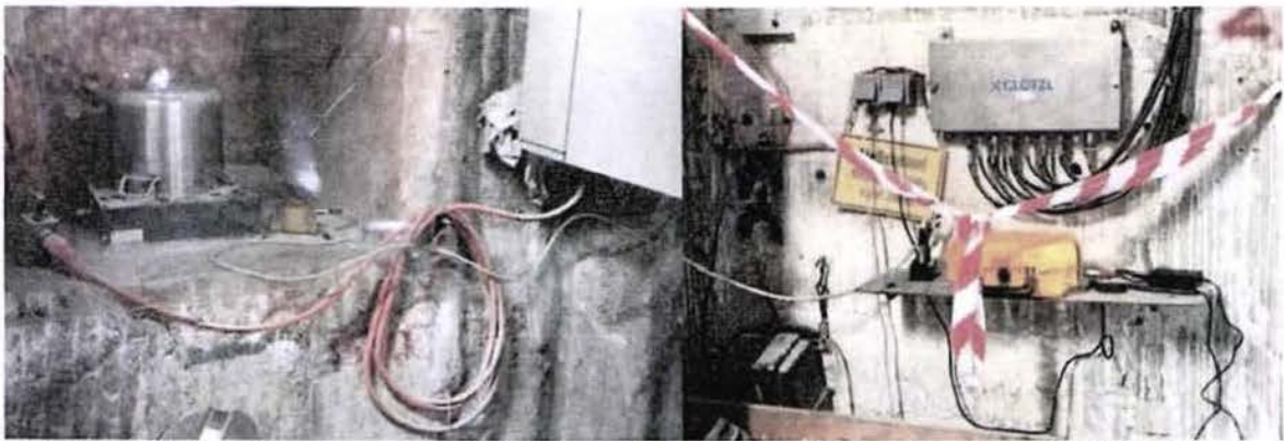
Abbildung 10: Installation von Sensor (links) und Messequipment (rechts) am Standort "S4900"
