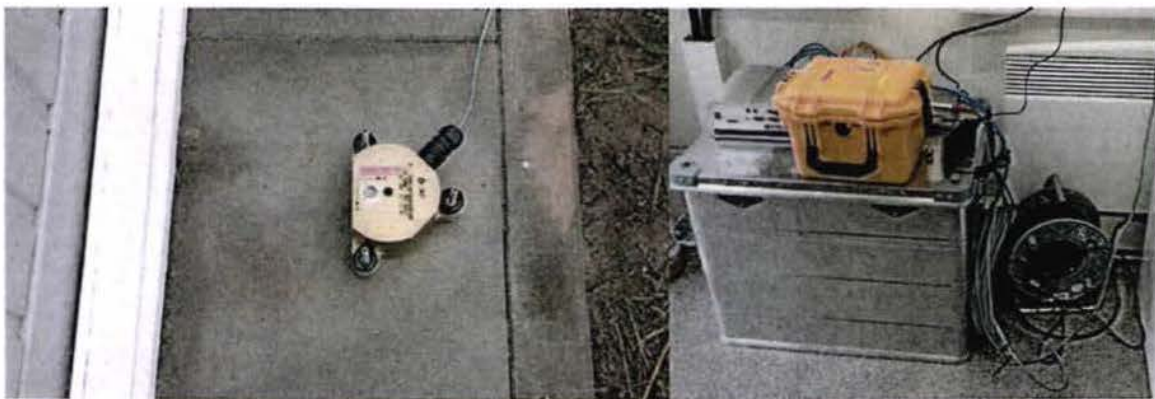
Abbildung 4: Installation von Sensor (links) und Messequipment (rechts) am Standort "IM-MI2"
