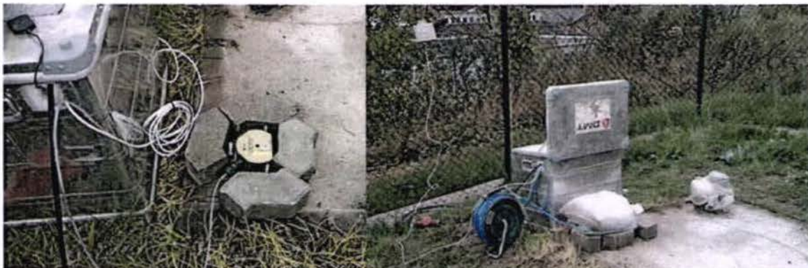
Abbildung 9: Installation von Sensor (links) und Messequipment (rechts) am Standort "RTP"
