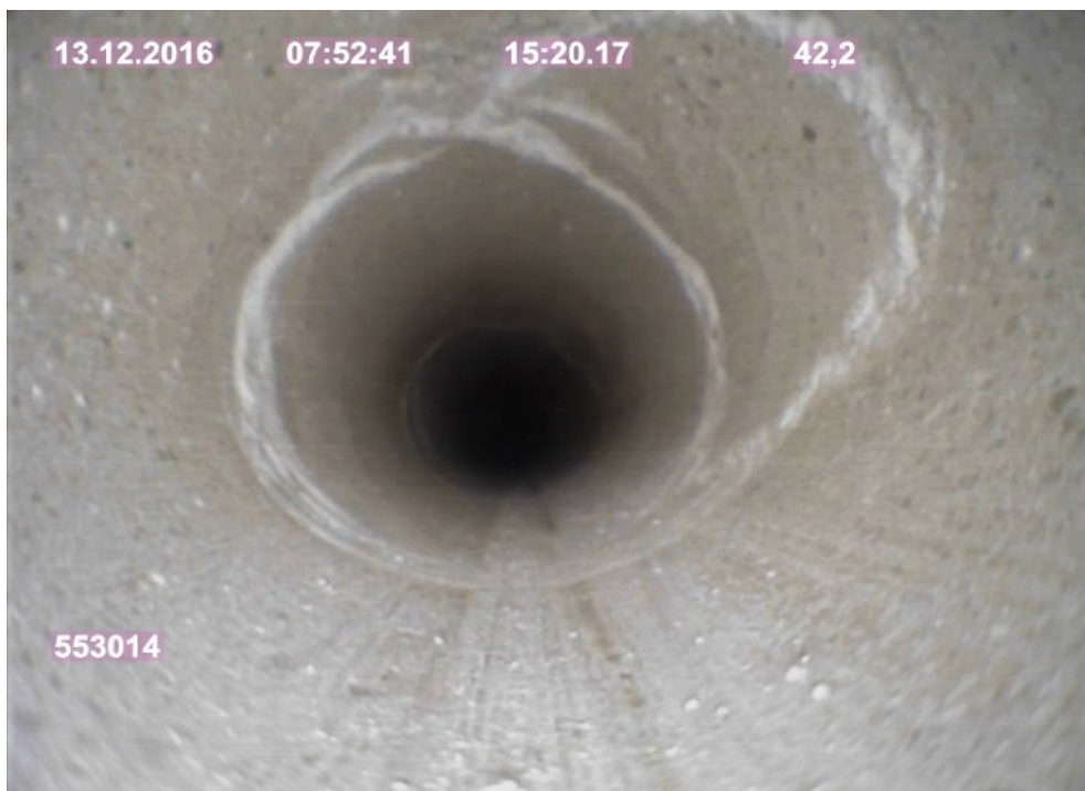
Foto 3h: Ausbruch/Riss bei 41,85 m
