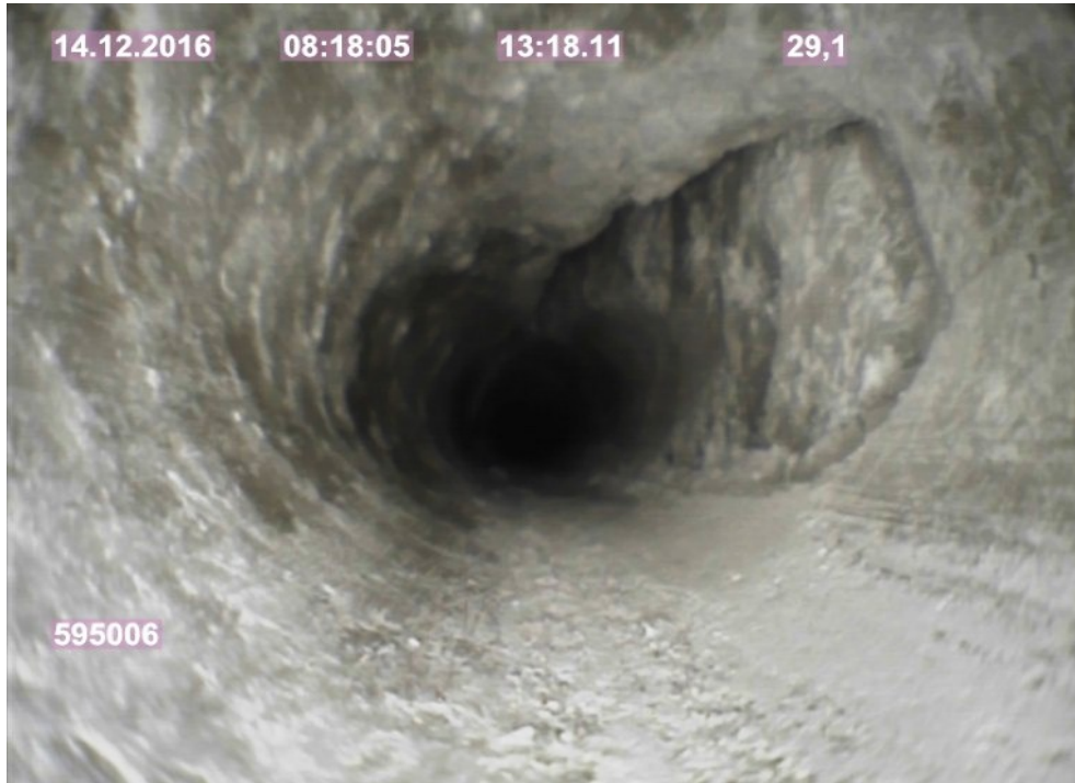
Foto 6g: Riss von Westen nach Osten bei 29,00 m
