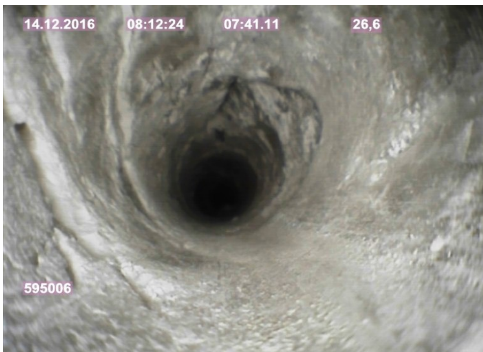
Foto 6b: Ausbrüche und Risse bei 26,45 m
