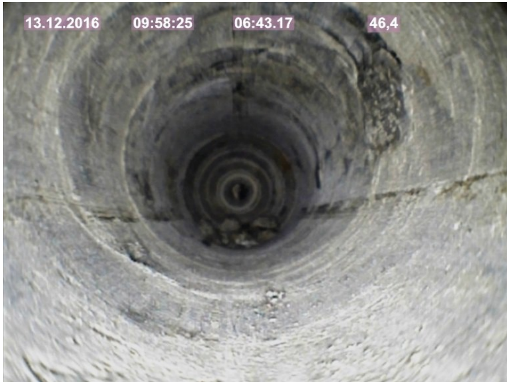
Foto 40: Ausbrüche bei 48,40 m und Bohrlochende bei 48,47 m
