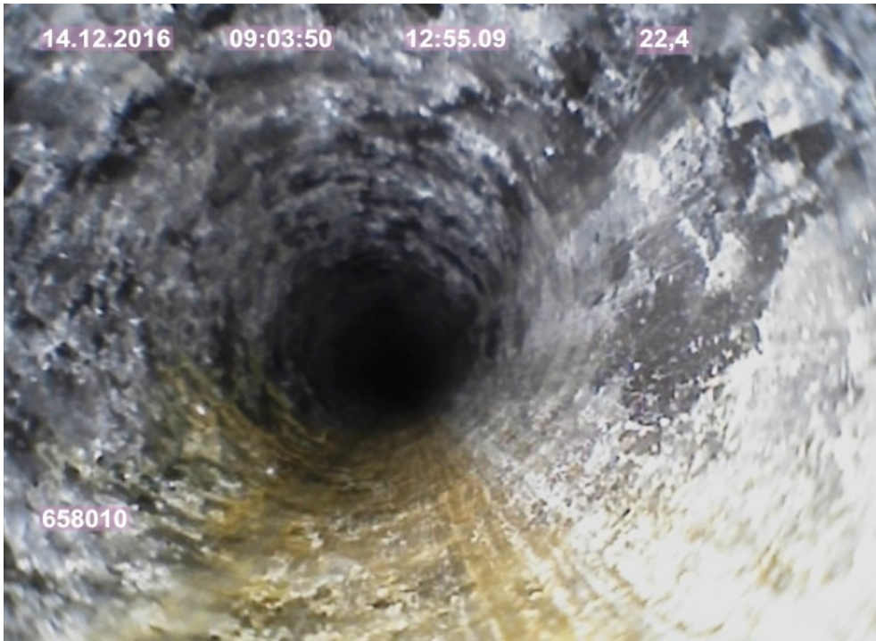
Foto 11i: Bohrloch feucht und braune Stellen bei 22,40 m
