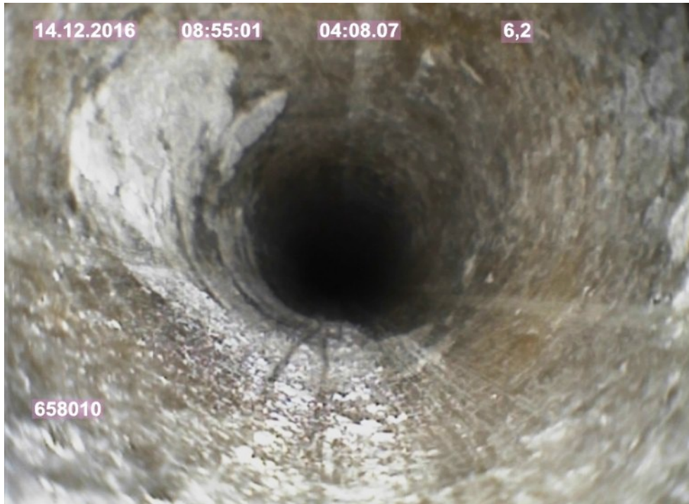
Foto 11c: Ausblühungen bei 6,20 m
