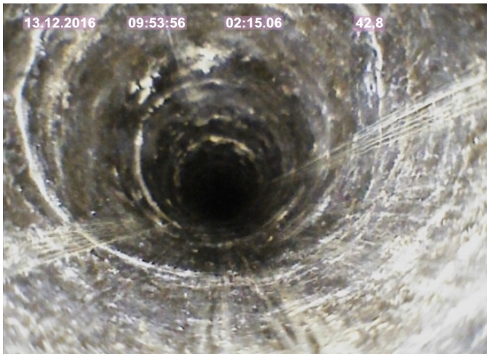
Foto 4l: Ausblühungen in der Firste bei 44,00 m, feucht
