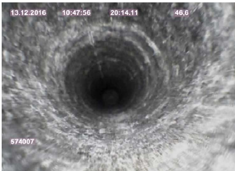
Foto 5i: Riss in der Firste bei 46,60 m
