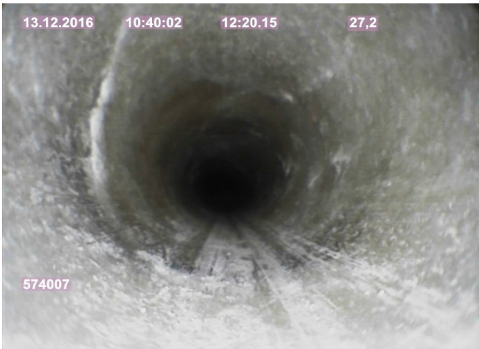
Foto 5h: Riss in der Bohrlochwand bei 27,20 m
