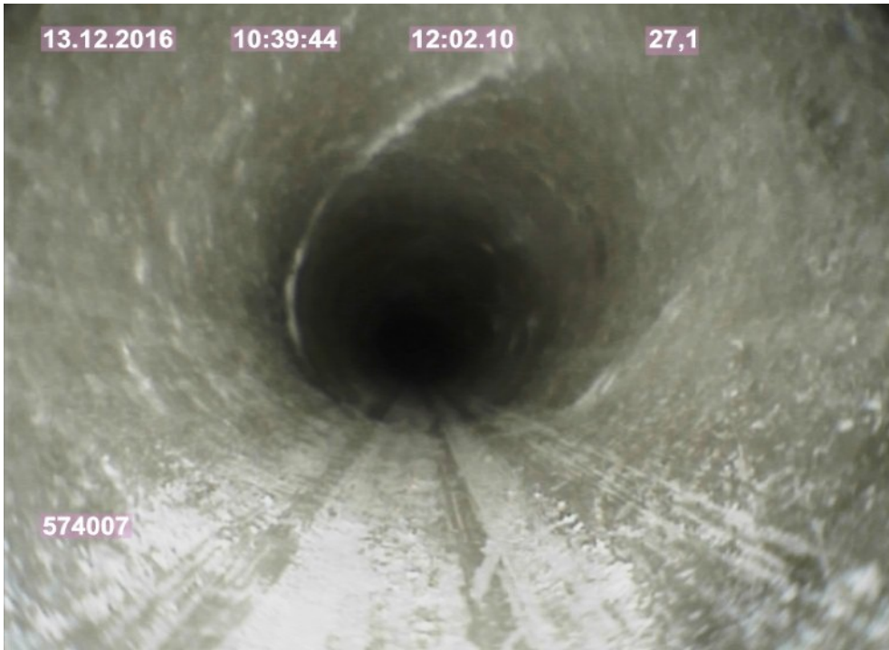
Foto 5g: Riss in der Firste und Bohrlochwand bei 27,10 m
