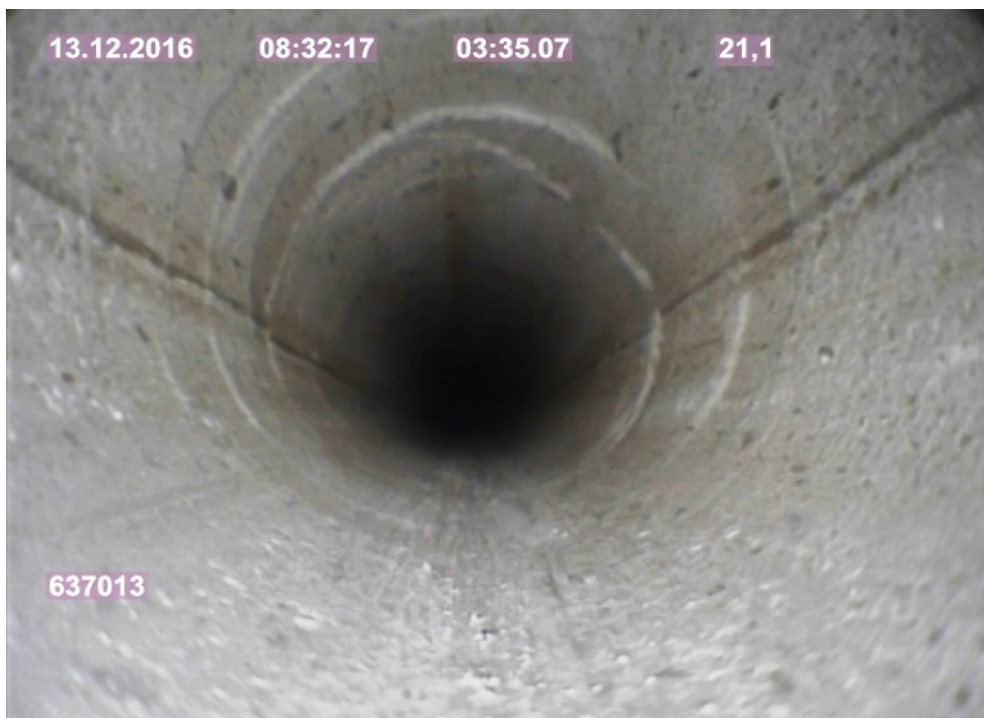
Foto 9b: Leichter Riss/Ausbruch bei 21,27 m
