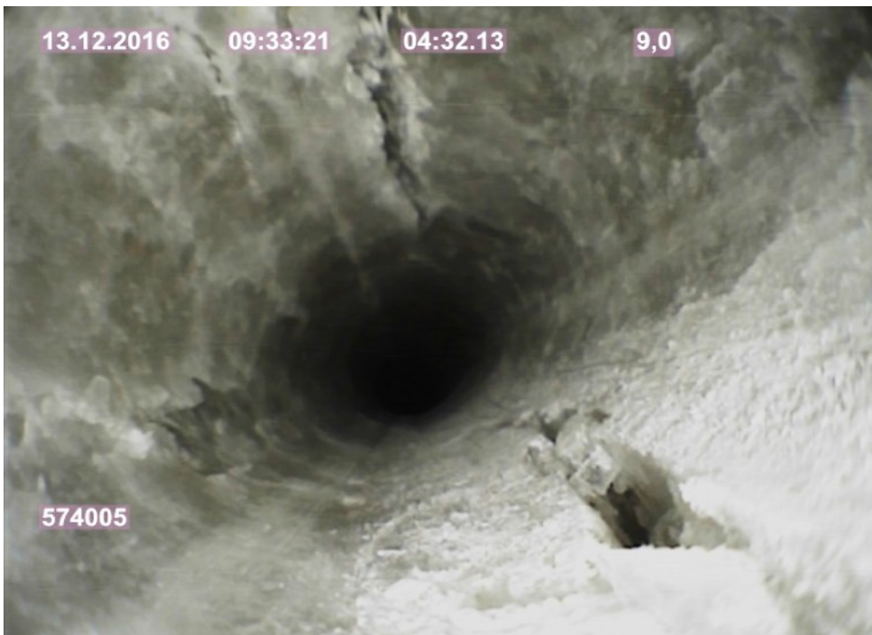
Foto 4d: Riss in der Sohle und Firste bei 10,20 m
