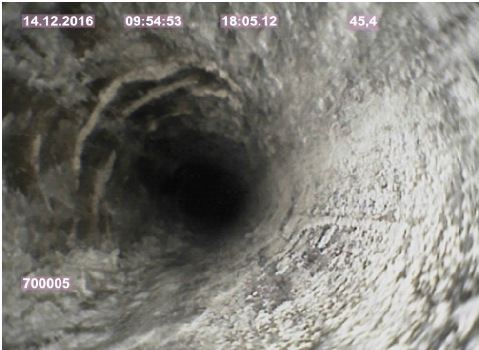
Foto 12e: Ausbruch Firste bei 45,00 m
