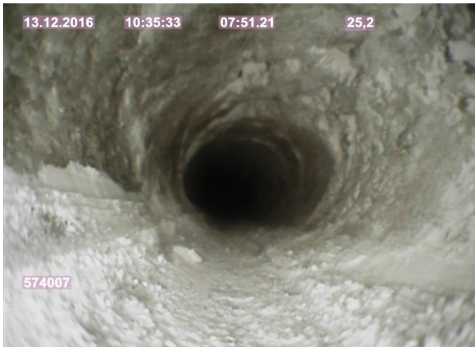
Foto 5d: Ausbrüche bei 25,25 m
