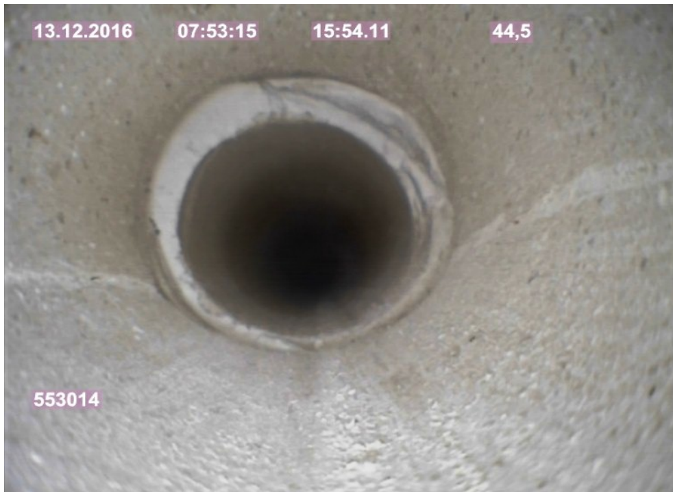
Foto 3i: Riss östliche und westliche Bohrlochwand bei 44,10m, kaum erkennbar
