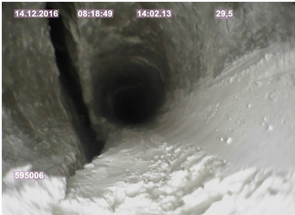
Foto 6h: Riss/Kluft im Osten bei 29,40 m
