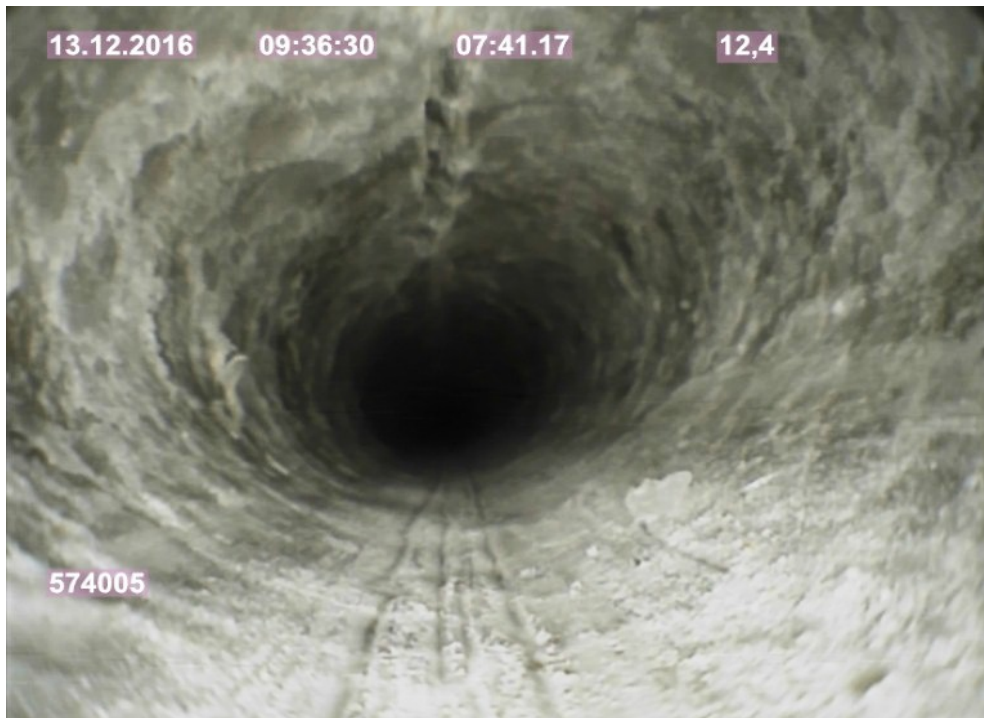
Foto 4g: Riss in der Firste bei 13,60 m
