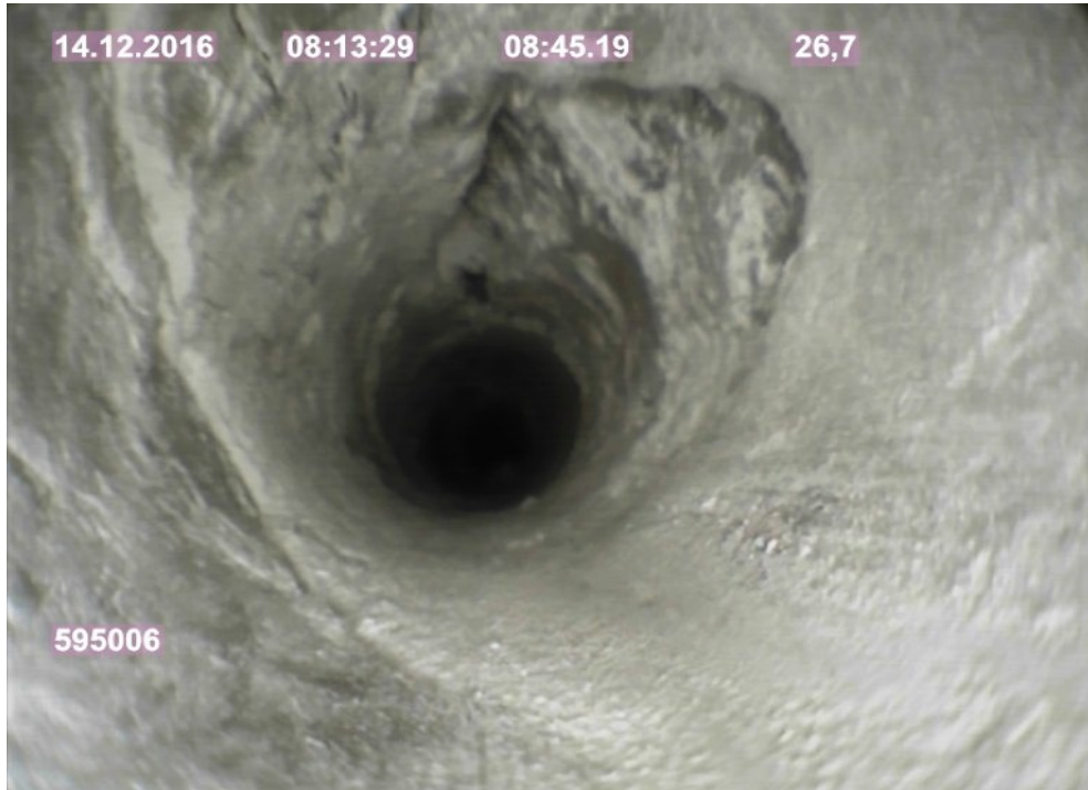
Foto 6c: Ausbruch/Risse bei 26,55 m
