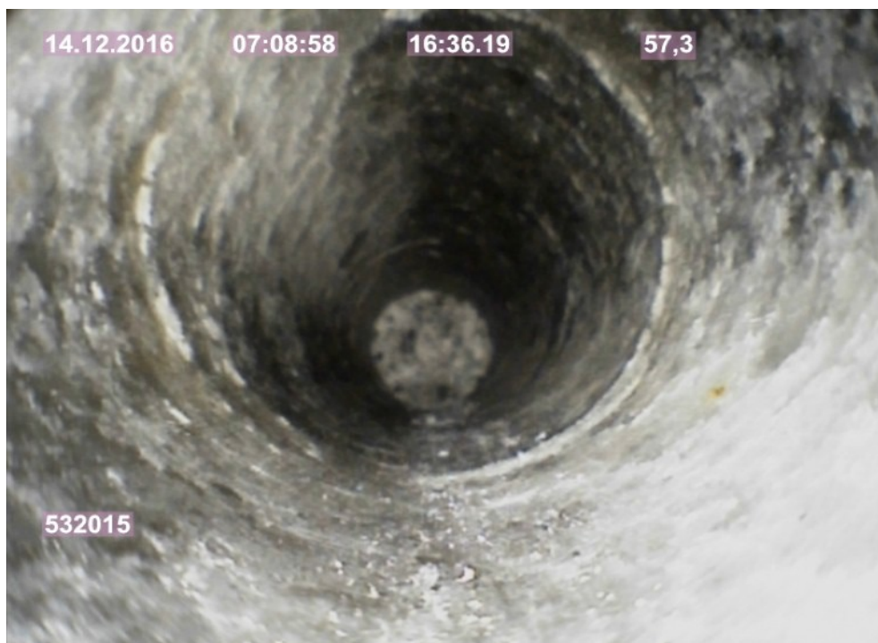
Foto 1e: Ausblühungen, kleiner brauner Fleck im Westen 57,85 m
