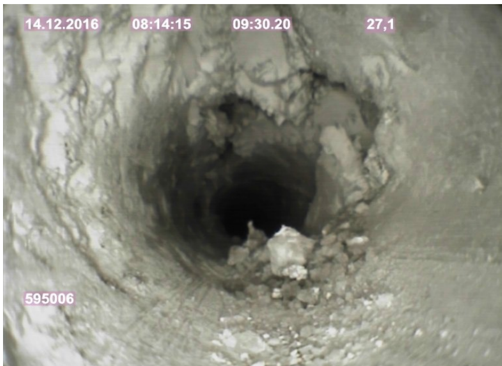
Foto 6d: Ausbruch bei 26,90 m
