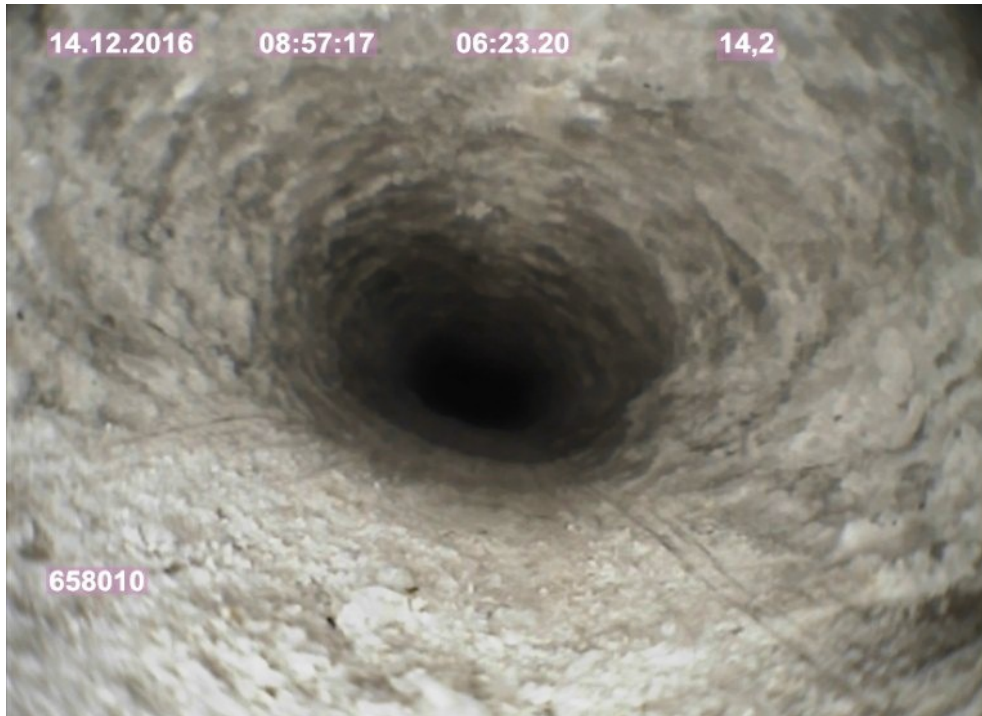
Foto 11e: Bohrloch konvergiert ab 14,00 m auf < 70 mm, Bohrlochwand porös und elliptisch
