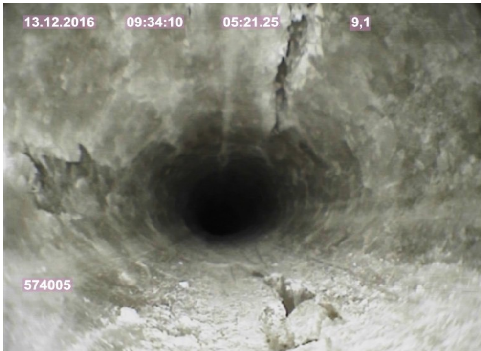
Foto 4e: Riss in der Sohle und Firste bei 10,30 m
