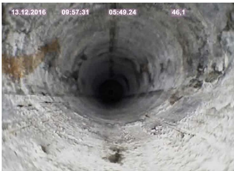
Foto 4n: Ausbrüche und Spuren von Carnallit bei 48,20 m
