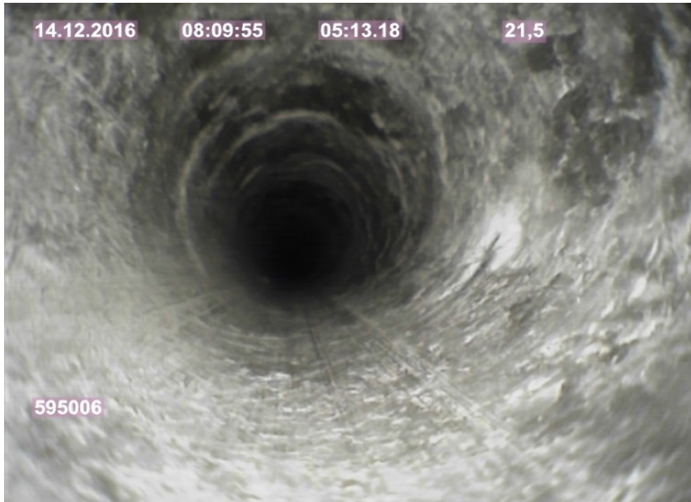
Foto 6a: Kleiner Ausbruch im Westen bei 21,40 m
