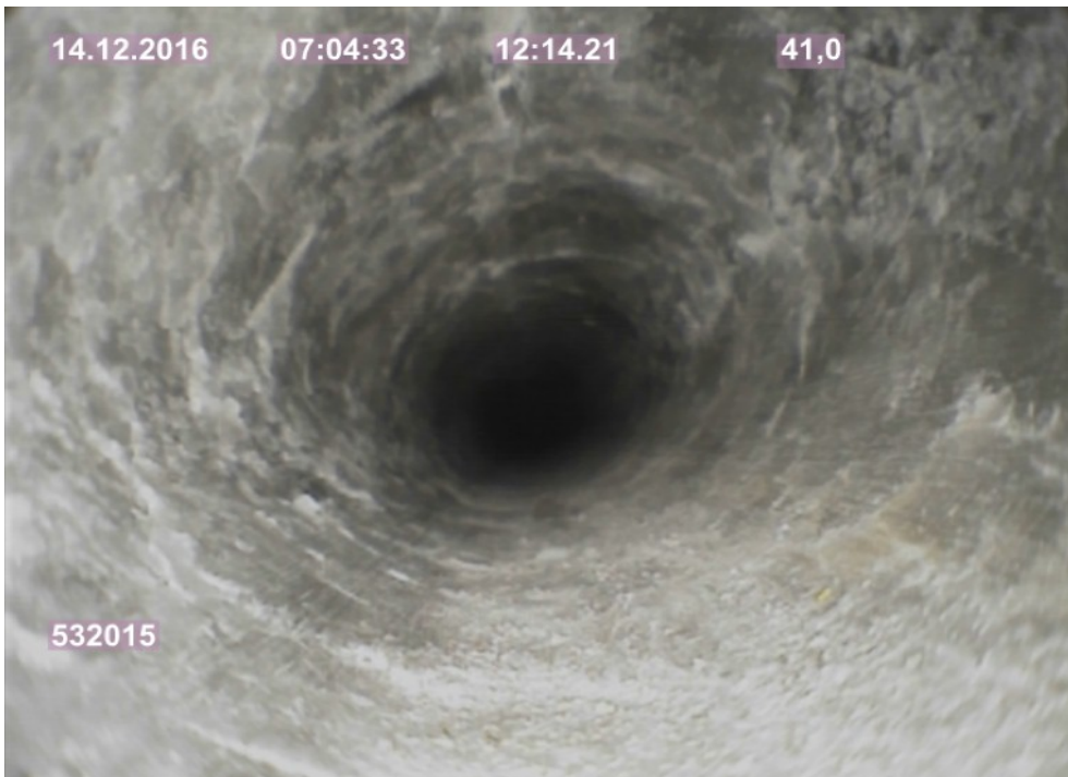
Foto 1d: Bohrloch bei 41 m, elliptisch beansprucht, kleine Ausbrüche
