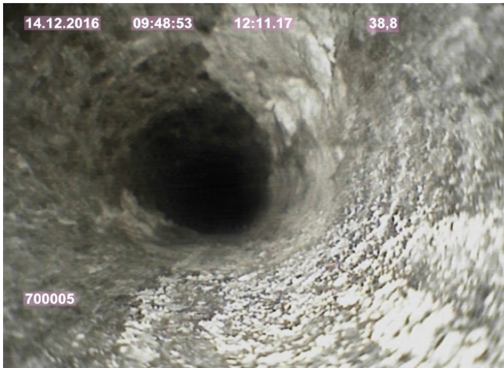
Foto 12c: Ausbruch bei 38,55 m
