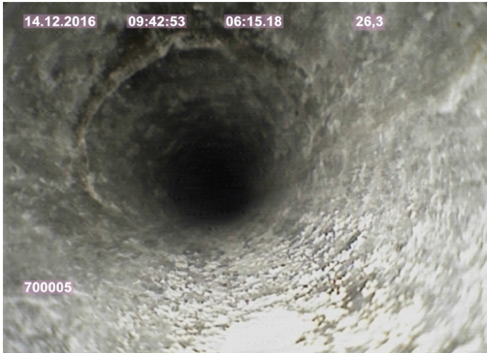
Foto 12a: Ausblühungen bei 26,30 m
