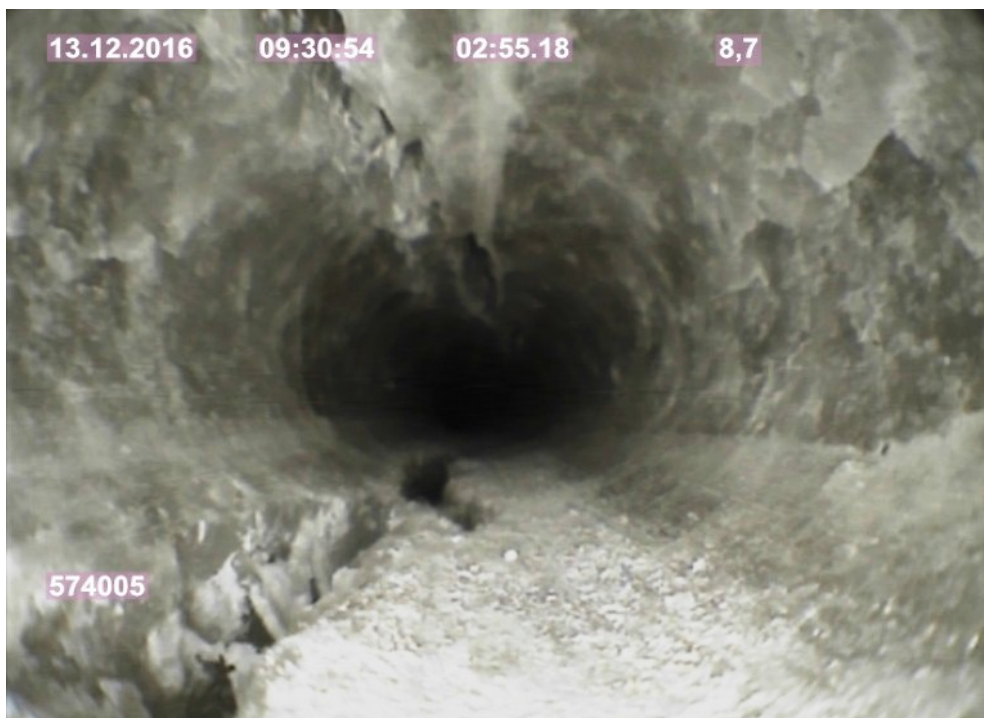
Foto 4b: Riss im Osten bei 9,90 m
