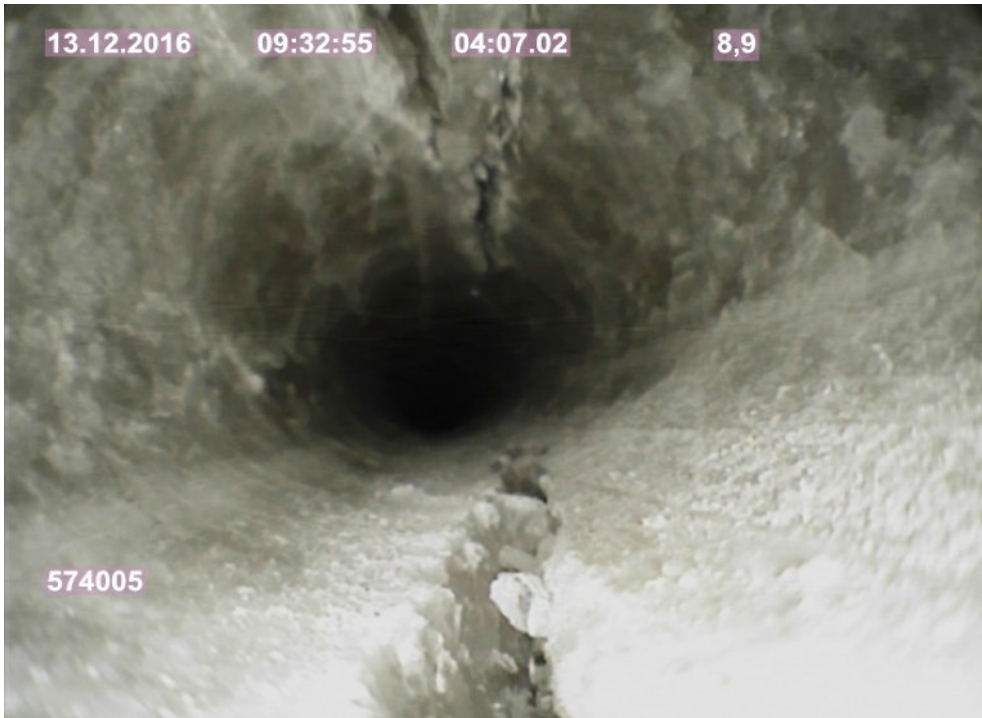
Foto 4c: Riss in der Sohle und Firste bei 10,10 m
