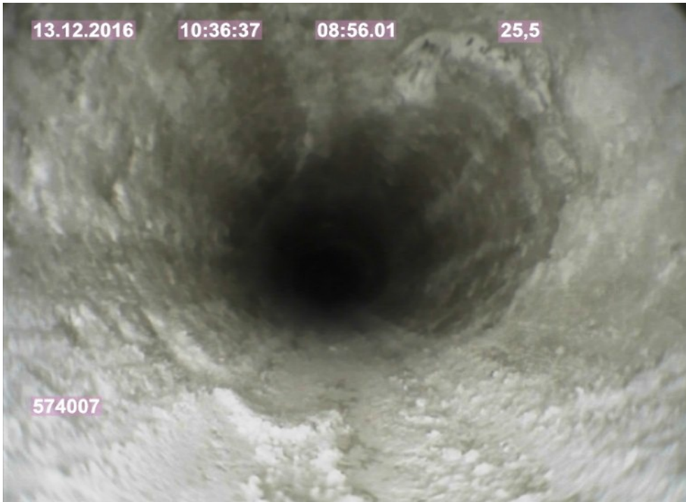
Foto 5e: Ausbrüche bei 25,50 m
