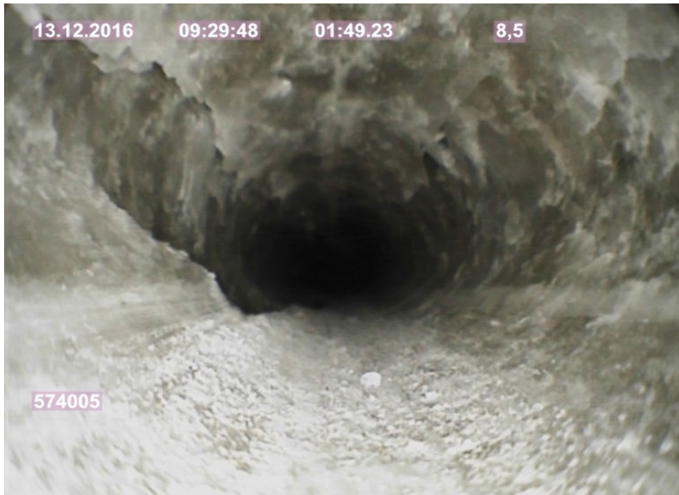
Foto 4a: Riss, Ausbruch bei 9,70 m
