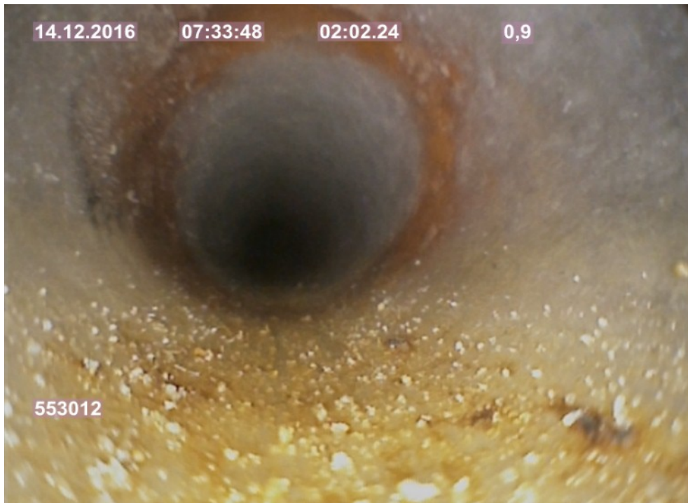
Foto 2c: Grenze K2C/Na 3 bei 1,00 m, Bohrloch feucht
