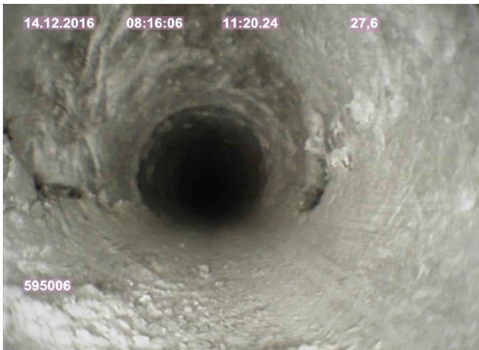
Foto 6f: Riss im Westen und Osten bei 27,45 m
