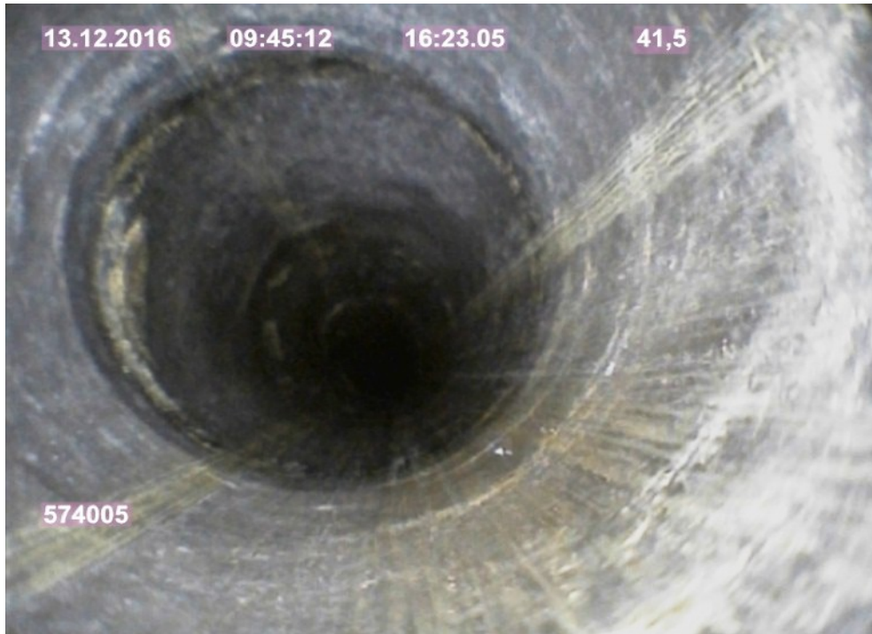
Foto 4k: Ausblühungen in der Bohrlochwand bei 42,70 m, feucht
