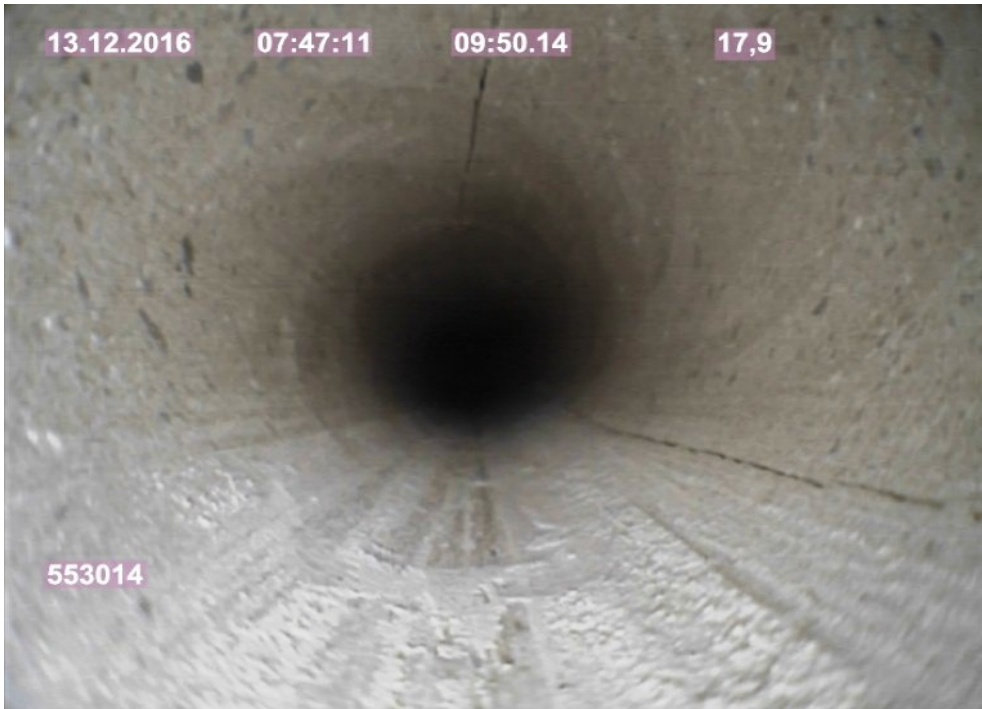
Foto 3e: Riss im Westen und in der Firste bei 17,60 m, neu
