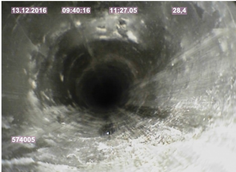
Foto 4j: Ausblühungen und Ausbrüche bei 29,55 m
