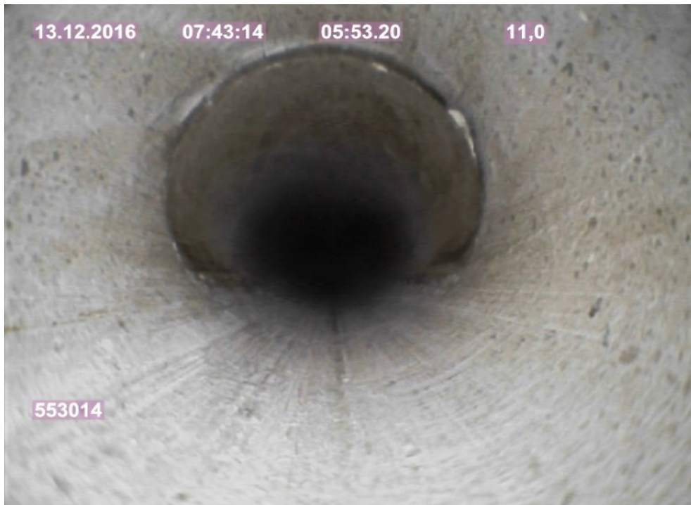
Foto 3c: Anfang Mauer bei 10,75 m
