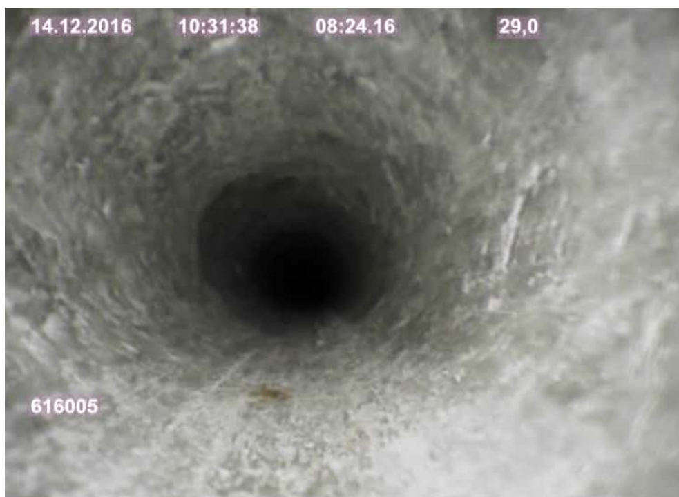
Foto 8b: Bohrloch bei 29,00 m, brauner Fleck in der Sohle
