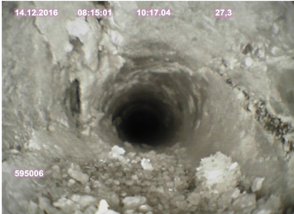
Foto 6e: Ausbruch und Risse bei 27,25 m
