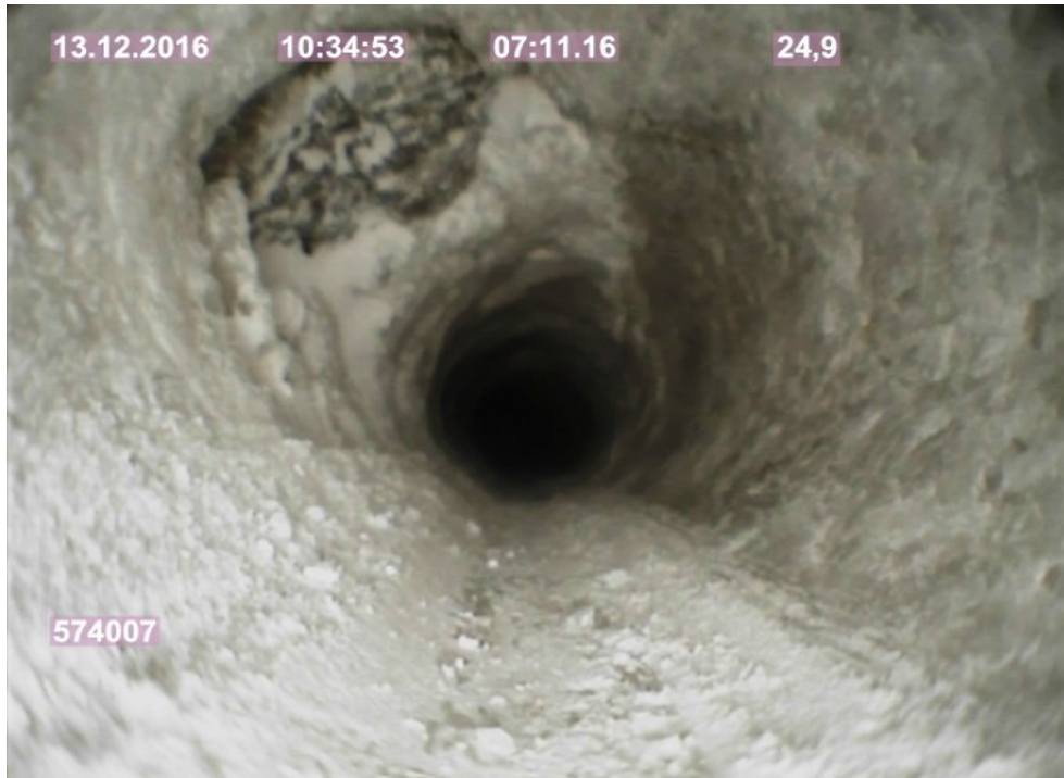
Foto 5c: Ausbruch östliche Bohrlochwand bei 25,00 m
