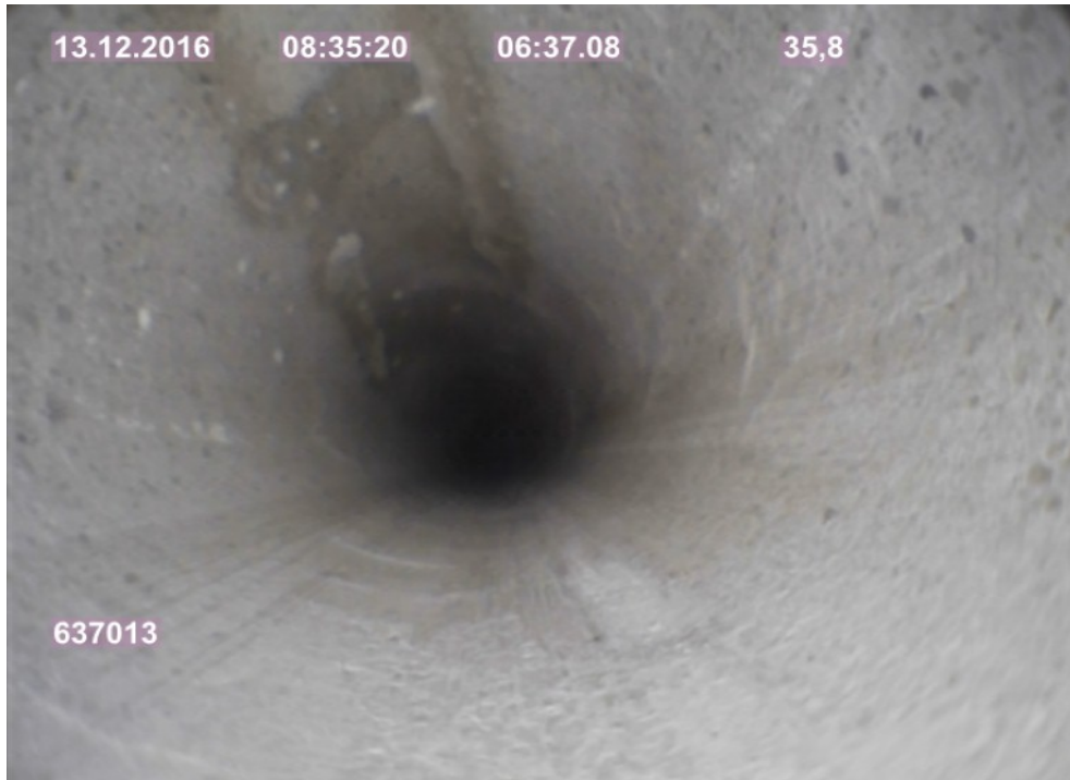
Foto 9c: Ausblühungen östl. Bohrlochwand und Firste bei 35,80 m
