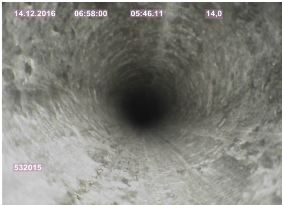
Foto 1b: Kleiner Riss im Westen bei 14,30 m, kaum erkennbar
