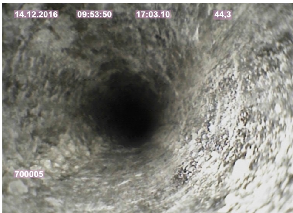
Foto 12d: Ausbruch bei 44,40 m
