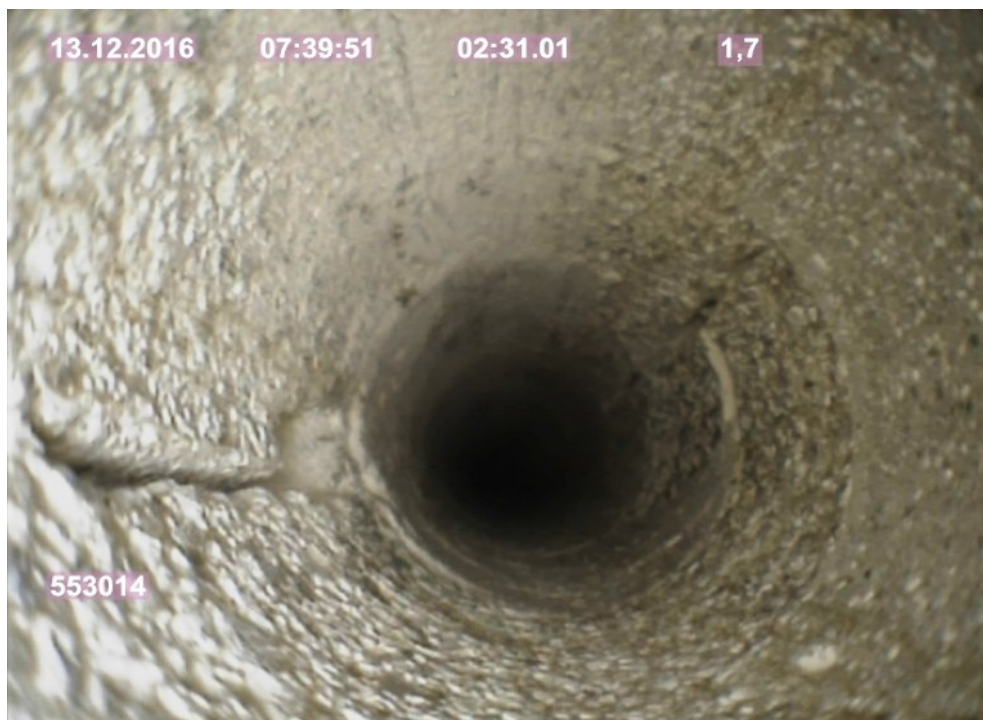
Foto 3a: Riss östliche und westliche Bohrlochwand bei 1,50 m
