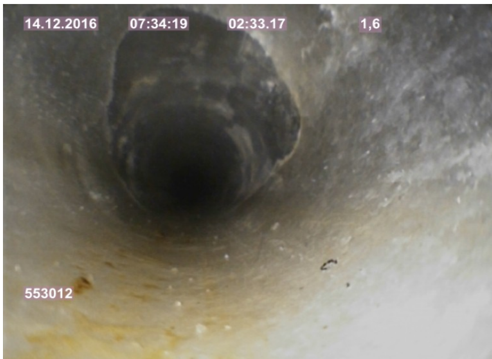
Foto 2d: Ausbruch oder Ausspülung bei 1,80 m, Bohrloch feucht
