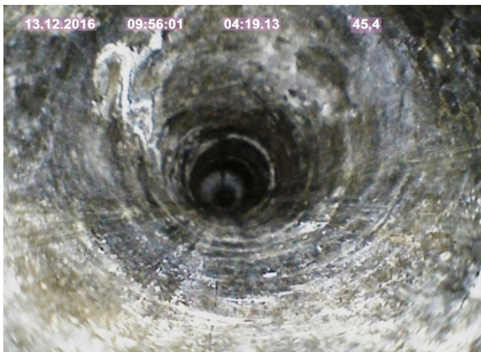
Foto 4m: Ausblühungen in der Firste bei 47,50 m, feucht
