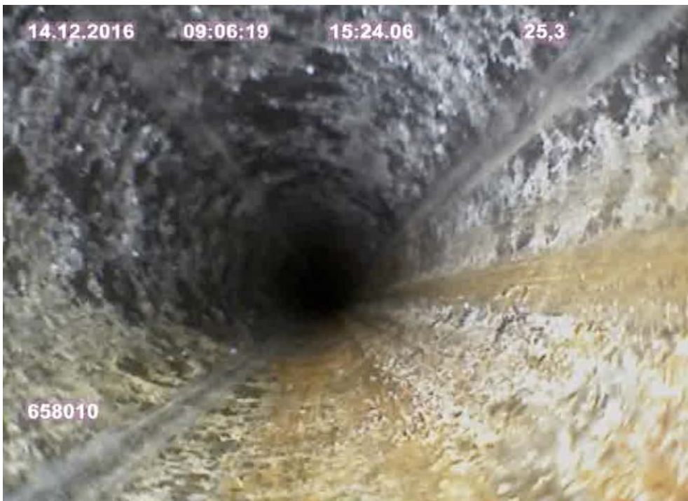
Foto 11l: Bohrloch feucht und braune Stellen bei 25,30 m
