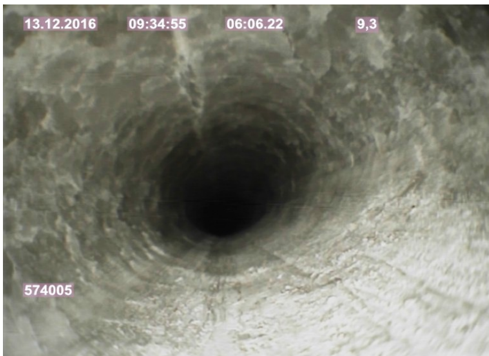
Foto 4f: Ende Riss in der Firste bei 10,44 m
