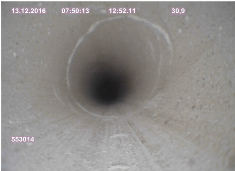
Foto 3f: Riss bei 30,60 m
