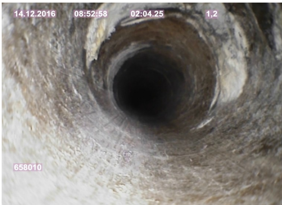
Foto 11b: Ausblühungen bei 1,20 m
