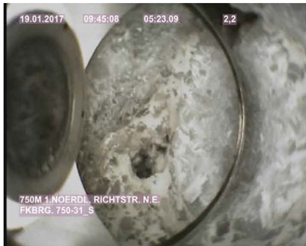
Bild 42: FKBrG. 750-31 – Position bei ca. 2,24 m Öffnungsweite ca. 4 mm
