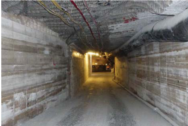
(a) NE-SW streichende Risse im Zugang der Streckenaufweitung zwischen firstbündig stabilisiertem Kleinpfeiler (links) und mit Stützbauwerken stabilisiertem Südstoß
