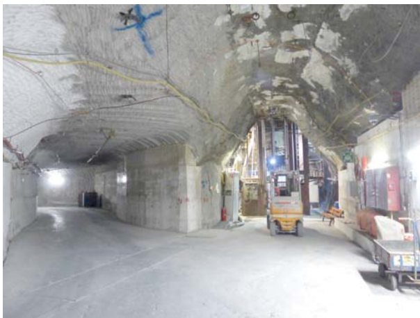
(a) Südöstlicher Pfeiler mit firstbündig erstellter Sorelbetonstützmauer am Südoststoß und entfestigtem Nordoststoß. Der Füllort-Nordstoß am Schacht ist ebenfalls entfestigt
