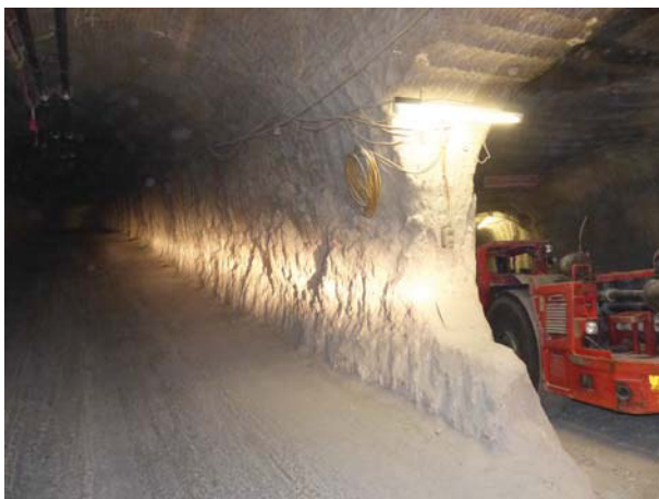
(a) Intensive Abschalungen am Südstoß der Wendelstrecke im Bereich des Pfeilers an der Zugangsstrecke zum Abbau 6/725 (Na2) auf der 725-m-Sohle
