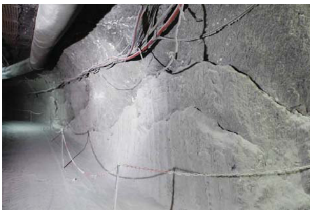
(a) Abgesperrter intensiv geschädigter Südstoß der Wendelstrecke zwischen entfestigter Spritzbetonsicherung und Nische
