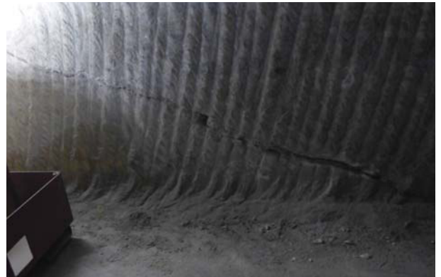
(b) Riss 7 mit Öffnungsweite größer 20 mm
