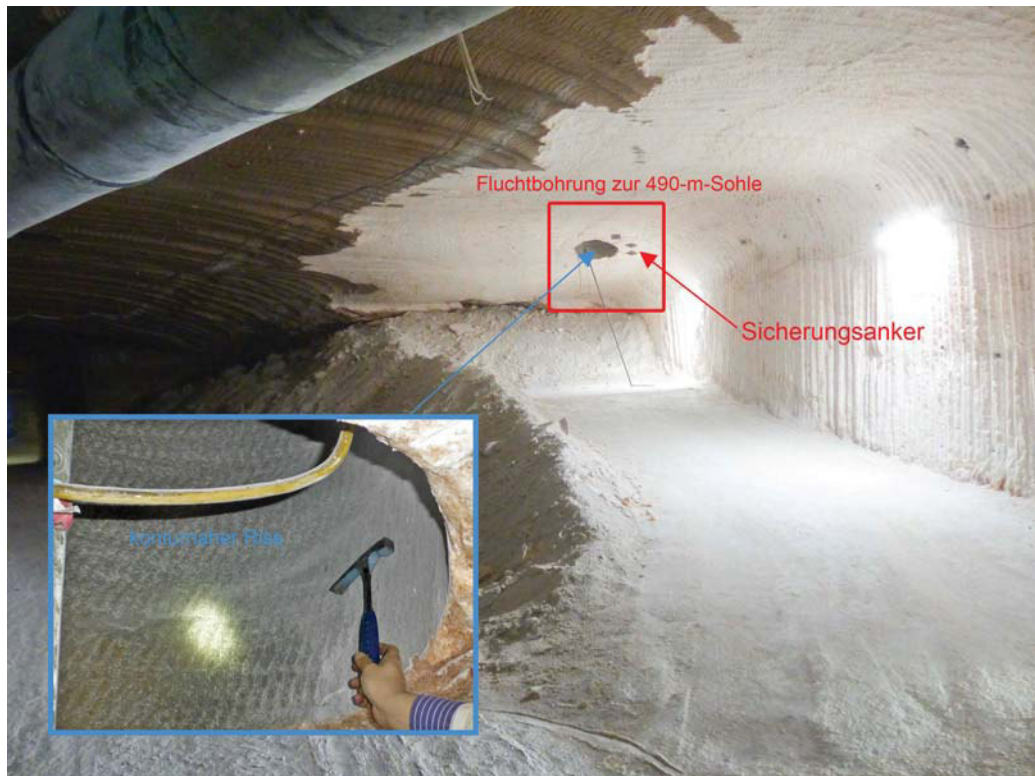
Abbildung 4.23: Abbau 8a/532, Fluchtbohrung zur 490-m-Sohle mit Sicherungsankern und konturnahem Riss, Blick nach Osten, Stand 08.03.2017
