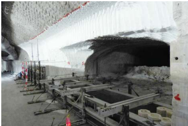
(a) Abschalen des Stützbauwerks am Südstoß im Bereich des Zugangs zu Abbau 5a(Na2)
