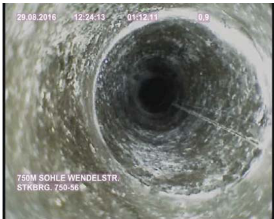
Bild 15: Riss mit Öffnungsweite von ca. 1 bis 4 mm (StKBrg.750-56, Teufe: 0,90 m)
