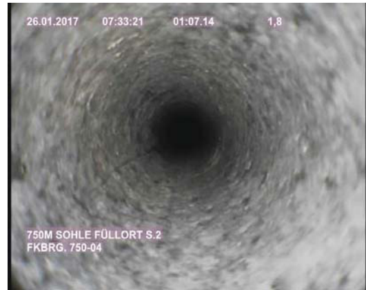
Bild 32: beginnende Ausblühungen in leicht feuchter Bohrlochkontur (FKBrg.750-04, Tiefe: 1,80 m)
