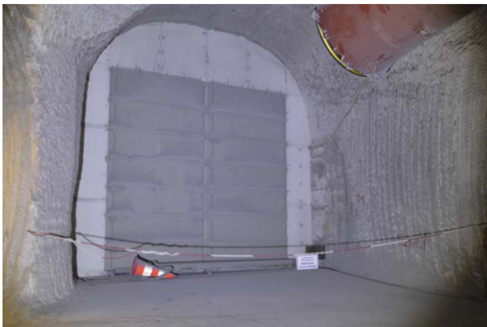
Abbildung 4.16: Fotoaufnahme der Schallschutzkulisse des Hauptgrubenlüfterstandortes auf der 490-m-Sohle vom 03.01.2017.
