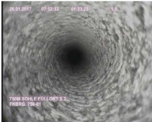
Bild 31: Spuren des Bohrvorgangs und anhaftendes Bohrmehl (FKBrg.750-01, Tiefe: 1,90 m)
