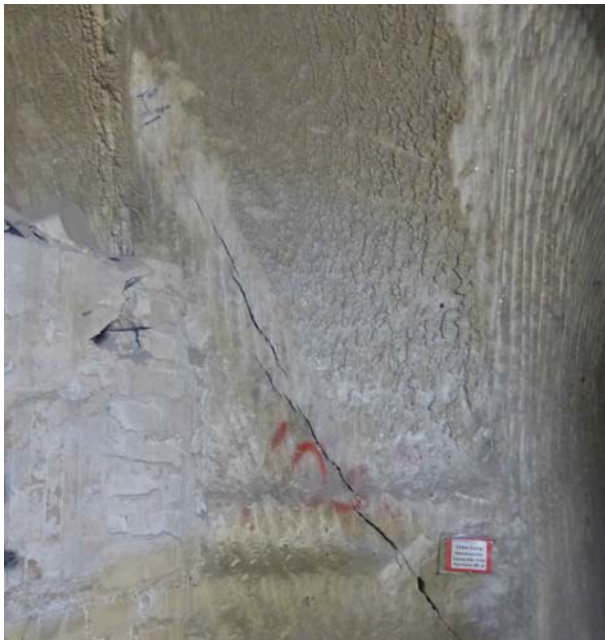
(a) Riss 3 im östlichen Zugangsbereich zu Abbau 4/553
