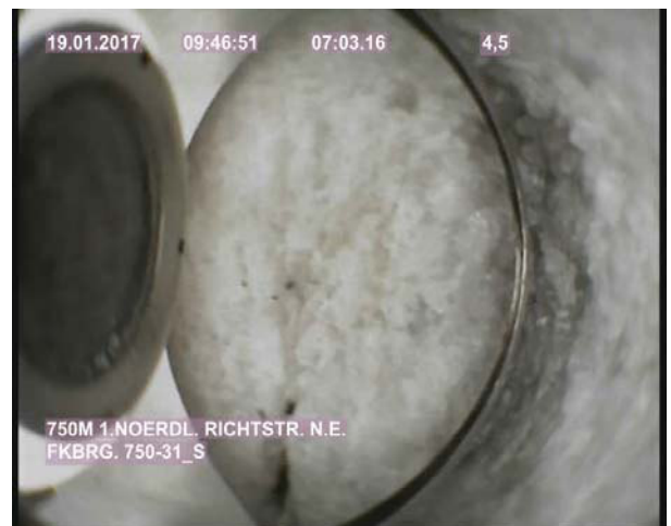
Bild 45: FKBrG. 750-31 – Position bei ca. 4,63 m Öffnungsweite ca. 1-2 mm
