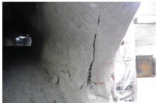
(b) Entfestigter schmaler Pfeiler zwischen Wendelstrecke und Diagonalstrecke zur 679-m-Sohle mit Rissen in bewehrter Spritzbetonsicherung
