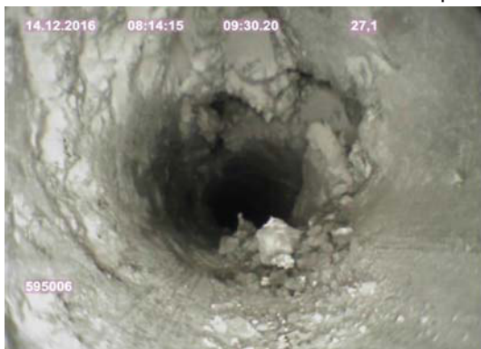
Bild 5: Bohrung 595006; Riss und Konturausbrüche bei 27,1 m Bohrlochteufe; Aufnahme vom 14.12.2016
