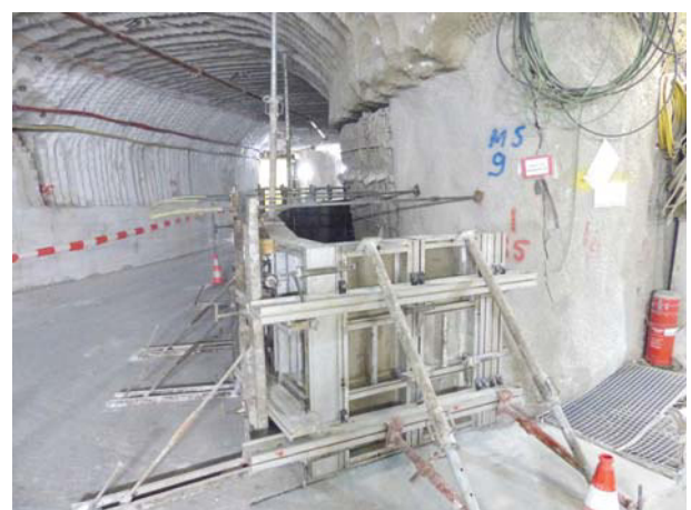
(b) Einhäuptige Schalung an der Sorelbetonstützma- uer vor dem Bereich der Bullflexsäulen am südöst- lichen Pfeiler
