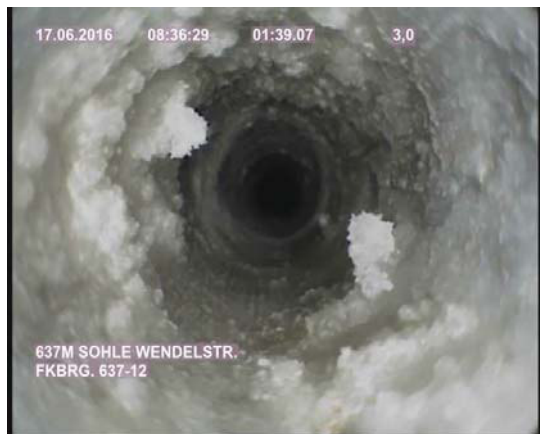
Bild 7: Ausgelöster Bischoffit und Salzausblüherungen (FKBrG.637-12, Teufe: 3,00 m)
