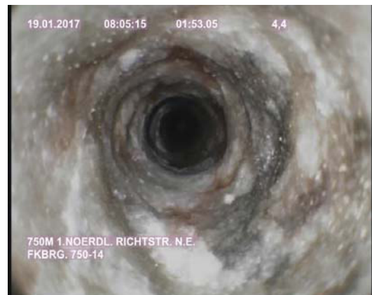
Bild 36: Salzausblühungen in feuchter Bohrlochkontur (FKBrg.750-14, Tiefe: 4,40 m)
