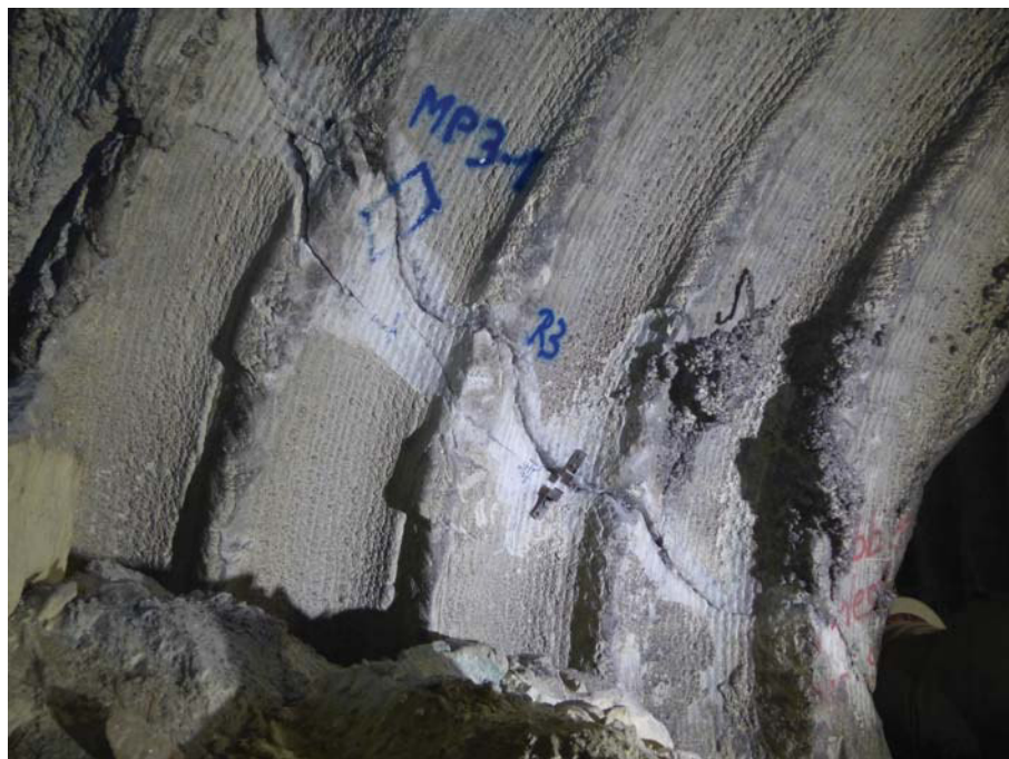
Abbildung 4.25: Riss 3/574 mit Markierung von Rissenden und verschiedenen Messpunkten zur Ermittlung der Öffnungsweite
