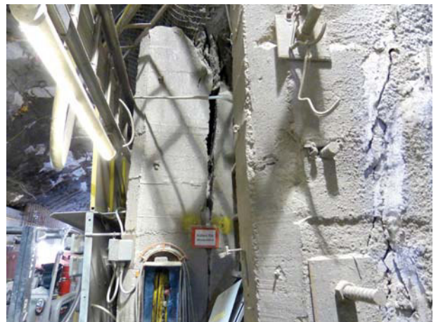
(b) Geschädigtes Sorelbetonmauerwerk mit Rissen am nordöstlichen Pfeilerstoß
