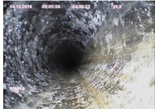
Bild 2: Bohrung 658010; Ausblühungen und Dunkelfärbung der Bohrlochkontur bei 24,8 m Bohrlochteufe deuten auf Feuchtigkeit hin; Aufnahme vom 14.12.2016
