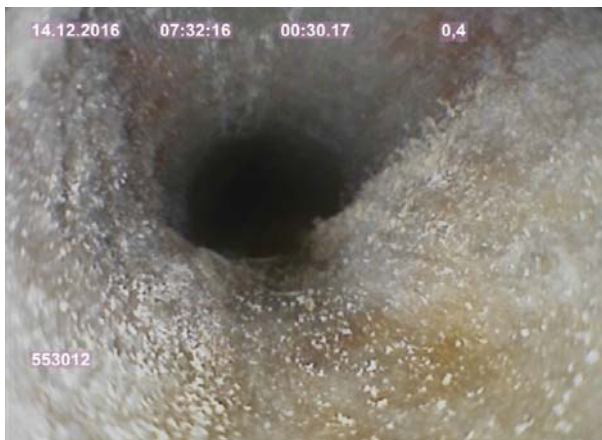
(a) Salzausblühungen als Hinweis auf Feuchtigkeit
