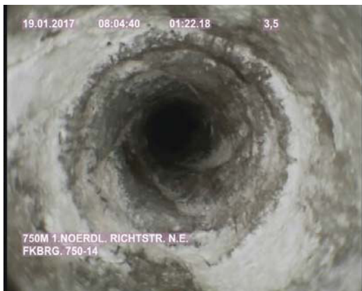
Bild 35: Spuren des Bohrvorgangs und anhaftendes Bohrmehl (FKBrg.750-14, Tiefe: 3,50 m)
