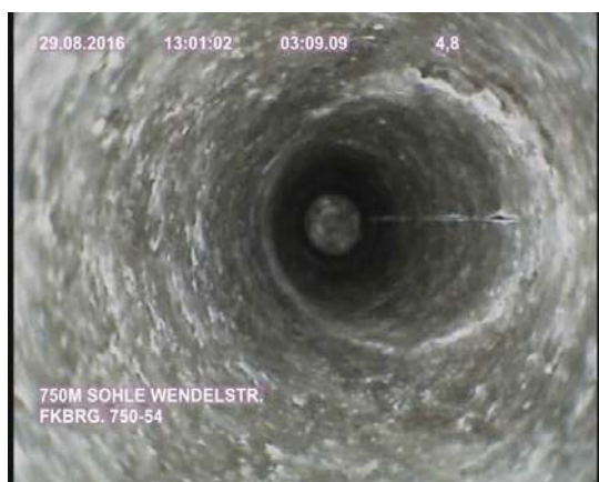
Bild 11: Geschlossener potentieller Riss (FKBrG.750-54, Teufe: 4,80 m)
