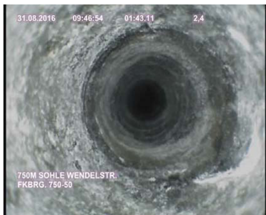
Bild 9: Rissähnlicher Konturausbruch (FKBrG.750-50, Teufe: 2,40 m)
