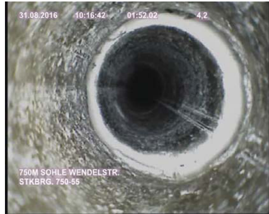
Bild 14: Riss mit Öffnungsweite von ca. 5 bis 6 mm (StKBrg.750-55, Teufe: 4,20 m)
