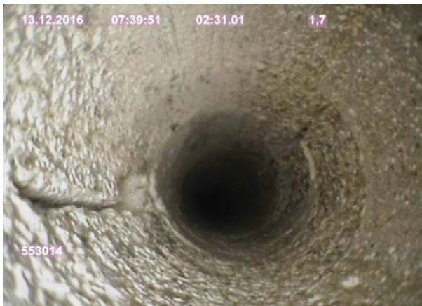
(a) Riss in der östlichen und westlichen Bohrlochwand
