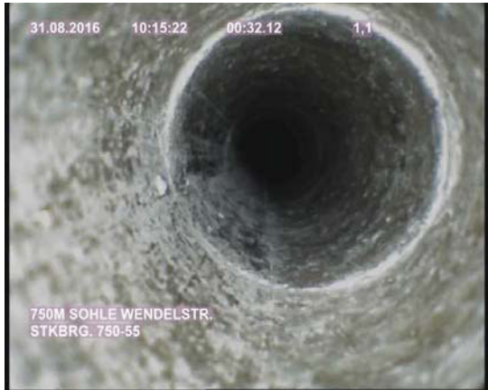
Bild 13: Riss mit geringer Öffnungsweite (StKBrg.750-55, Teufe: 1,10 m)
