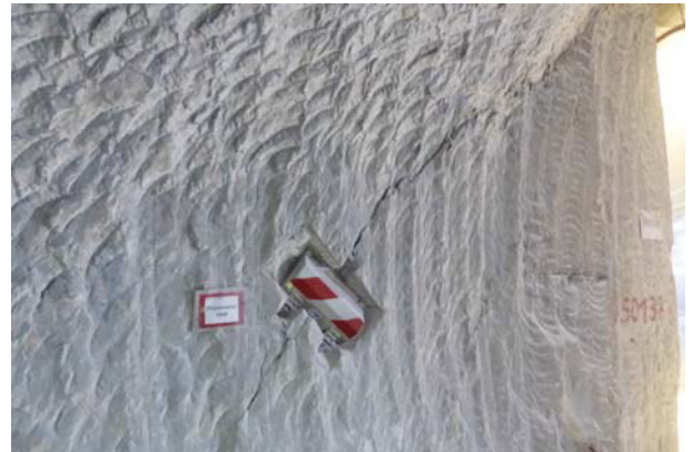
(b) Fissurometer 034F an einem in der Schichtung verlaufenden Riss am Nordoststoß im Einmündungsbereich der Wendelstreckenumfahrung zur 775-m-Sohle
