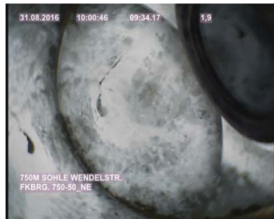
Bild 8: Seitenblick auf geöffneten Riss (FKBrG.750-50, Teufe: 1,90 m)
