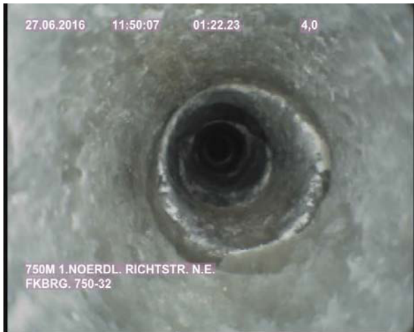
Bild 46: FKBrG. 750-32 – Position bei 4,1 m Aufgeloekterter Bereich bis 4,5 m
