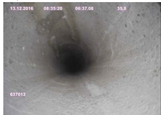
Bild 4: Bohrung 637013; Ausblühungen ein Hinweis auf Feuchtigkeit bei 36 m Bohrlochteufe; Aufnahme vom 13.12.2016
