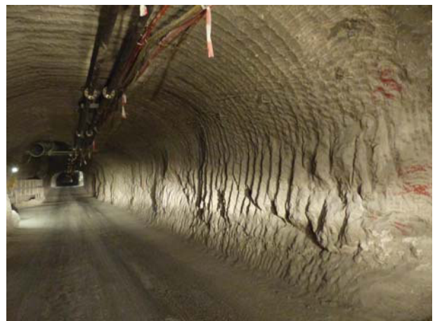
(b) Signifikant entfestigter Nordstoß der Wendelstrecke westlich einer Nische im Firstniveau der 725-m-Sohle
