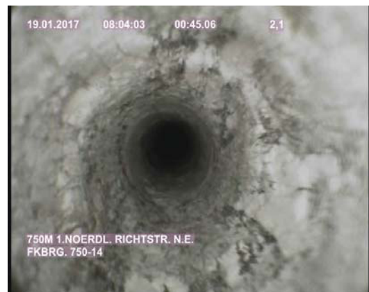
Bild 34: Konturausbruch mit Bohrmehlansammlungen (FKBrg.750-14, Tiefe: 2,10 m)
