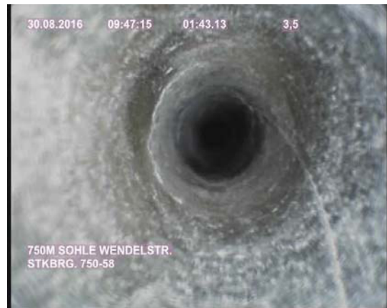
Bild 16: Geschlossener potentieller Riss (StKBrg.750-58, Teufe: 3,50 m)
