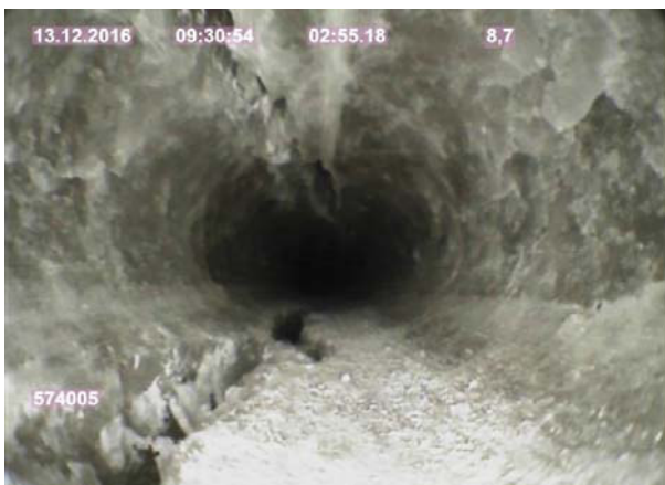
(a) Beginn der Rissstruktur
