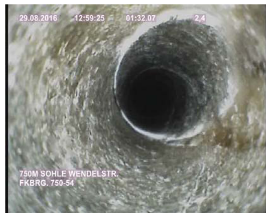
Bild 10: Riss mit geringer Öffnungsweite (FKBrG.750-54, Teufe: 2,40 m)
