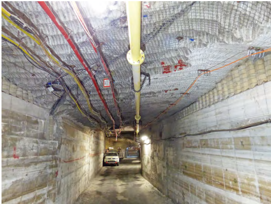
Abbildung 4.53: Zufahrtsbereich mit Stabilisierungsbauwerken an beiden Stößen, unvollständig mit Maschen- drahtverzug gesicherten Vertikalrissen sowie Bereich der unterfahrenen A-Sohle, Blick nach Südosten (22.01.2021)
