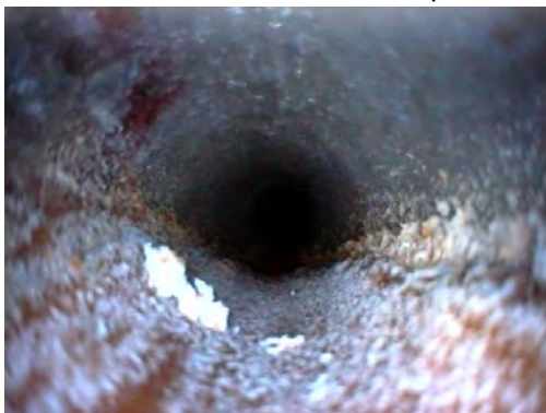
Bild 3: Bohrung 553012; Dunkelfärbung der Bohrlochsohle und Ausblühungen bei ca. 0,5 m Bohrlochteufe deuten auf Feuchtigkeit hin, Aufnahme vom 24.11.2020
