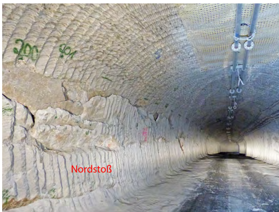
Abbildung 4.20: Östlicher Wendelstreckenabschnitt von der 725-m- zur 750-m-Sohle mit starken, bis in den Übergang zur Firste reichenden Abschalungen am Nord- und Südstoß, Blick nach Südosten (05.01.2021)
