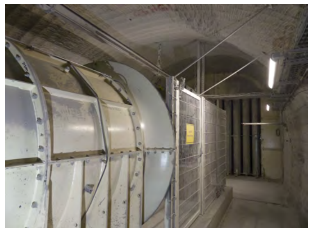
(d) Blick auf den Hauptgrubenlüfter Richtung Schallkulisse nach Südwesten, Stand: 06.01.2021
