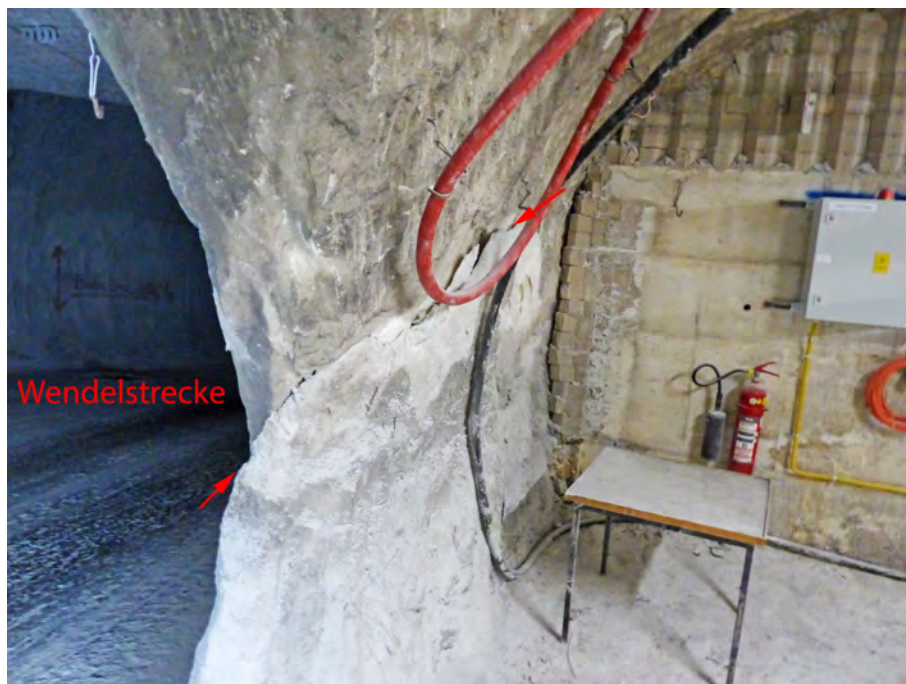
Abbildung 4.22: Von Scherfläche durchzogene Pfeilerspitze zwischen Wendelstrecke und Zugang zum Abbau 3a auf der 775-m-Sohle, Blick nach Osten (05.01.2021)
