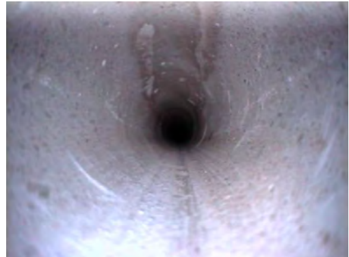
Bild 8: Bohrung 637013; Ausblühungen deuten auf Feuchtigkeit bei ca. 36 m Bohrlochteufe, Aufnahme vom 30.11.2020
