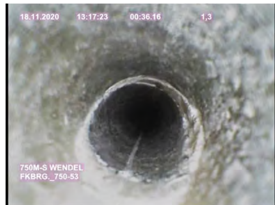
Bild 58: Riss mit Öffnungsweite von ca. 1 bis 2 mm (FKBrG.750-53, Teufe: 1,30 m)
