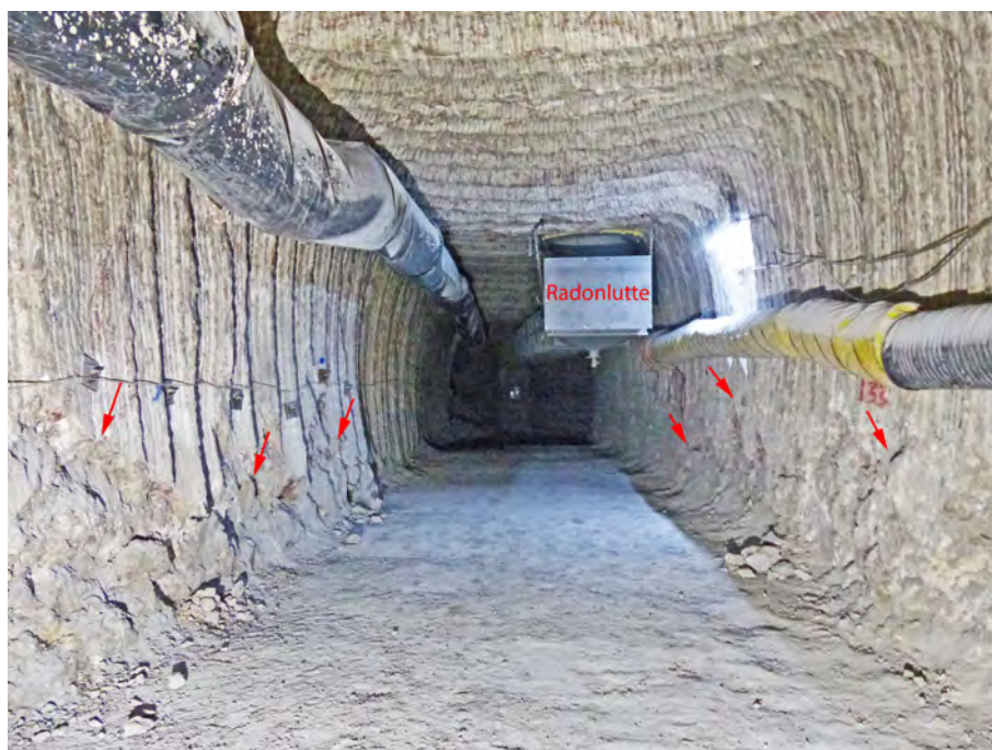
Abbildung 4.46: Nördlicher Abschnitt des Querschlags nach Norden mit der zur Fluchtbohrung verlaufenden Radonlutte und geschädigtem Weststoß, Blick nach Norden, 06.01.2021
