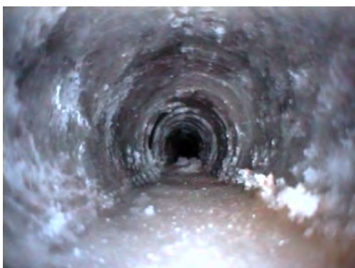
Bild 5: Bohrung 679006; Lauge auf der Sohle bei ca. 1 m Bohrlochteufe, Aufnahme vom 02.12.2020
