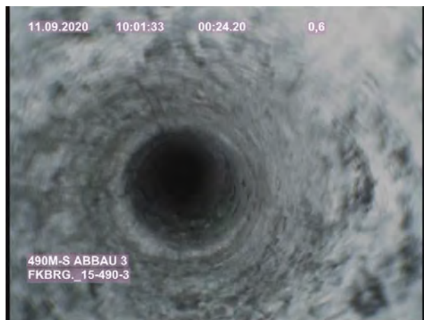
(a) Rissstruktur bei ca. 0,6 m bis 0,7 m Bohrlochteufe
