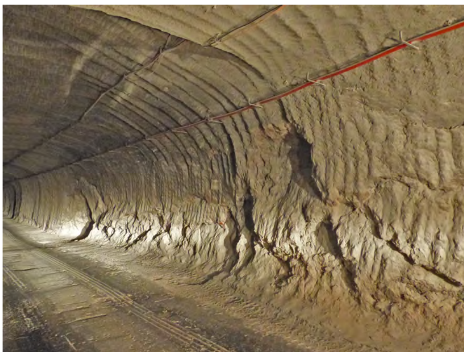
Abbildung 4.12: Signifikant entfestigter Nordstoß der Wendelstrecke auf Höhe zwischen Abbau 7 und Abbau 8 auf der 595-m-Sohle, Blick nach Westen (05.01.2021)
