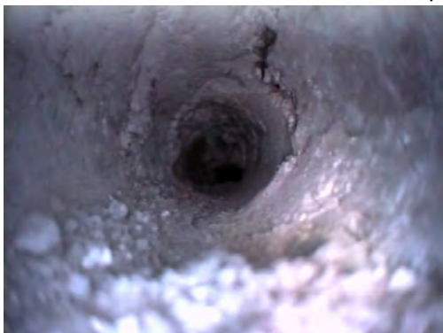
Bild 11: Bohrung 595006; Riss und Konturausbrüche sowie Haufwerk bei ca. 27 m Bohrlochteufe, Aufnahme vom 26.11.2020
