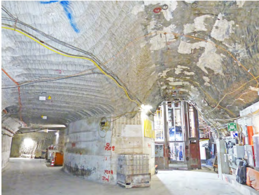
Abbildung 4.47: Füllort mit stabilisiertem südöstlichen Pfeiler sowie vereinzelt geraubten flachen Lösern im Firstbereich, Blick nach Westen (22.01.2021)
