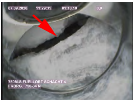
Bild 73: Geöffneter Riss, Öffnungsweite bis ca. 3 mm (FKBrg.750-34, Teufe: 0,10 m)
