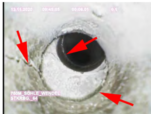
Bild 64: Risse mit Öffnungsweiten von ca. 2 bis 4 mm (StKBrg.750-64, Teufe: 0,10 m)
