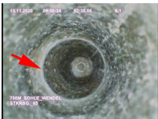
Bild 65: Riss mit geringer Öffnungsweite (StKBrg.750-65, Teufe: 6,00 m)
