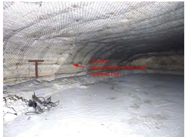
(b) Abgerissene Ankerplatte am südlichen Stoß von Lösungsbecken 1 im Abbau 3/490, Stand: 16.11.2020
