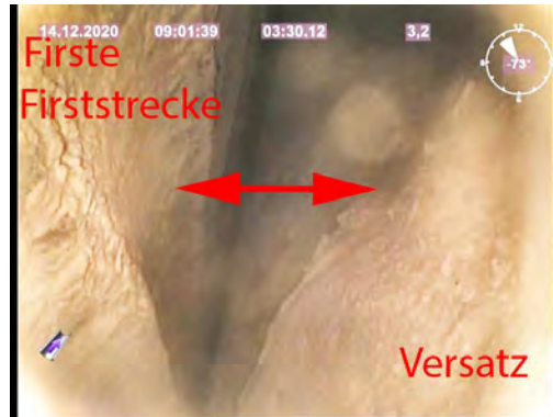
Bild 62: Übergang in Firststrecke n. W./616 mit Firstspalt, östl. Zugang Abb. 4/616 (SKBrg.553-02, Teufe: 79,80 m)
