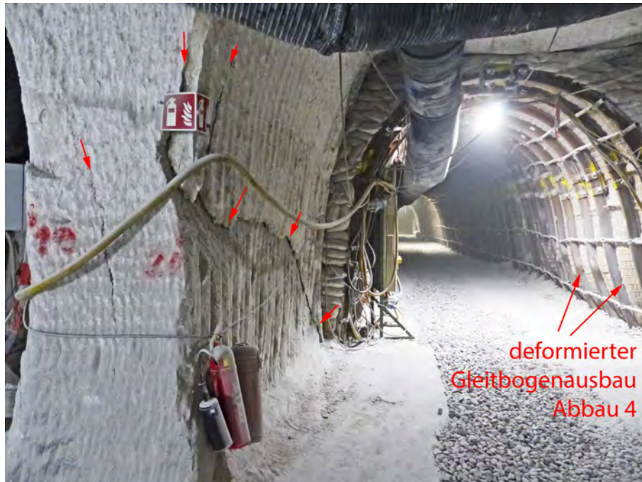
Abbildung 4.43: Im Pfeiler zwischen Nordstoß der Richtstrecke nach Westen und dem Querschlag nach Norden bilden sich im Übergang zum Abbau 4 zunehmend Risse und Scherflächen aus - der Gleitbogenausbau im Abbau 4 weist intensive Verformungen auf, Blick nach Osten, 06.01.2021
