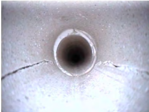
Bild 7: Bohrung 553014; Risse in der Bohrlochwand und Ausbruch bei ca. 44 m Bohrlochteufe, Aufnahme vom 23.11.2020
