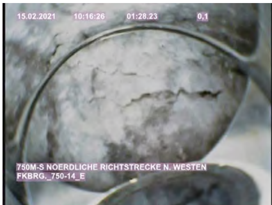
Bild 71: Zunehmend rundum verlaufende Haarrisse (FKBrg.750-14, Teufe: 0,20 m)
