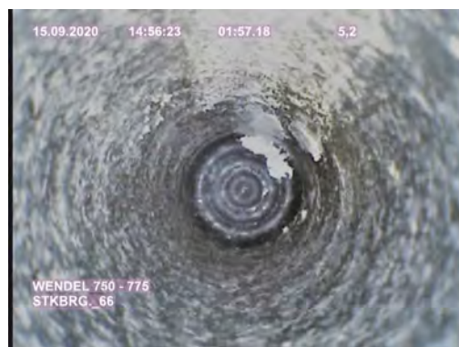
Bild 66: Salzausblühungen in feuchter Kontur (StKBrg.750-66, Teufe: 5,20 m)
