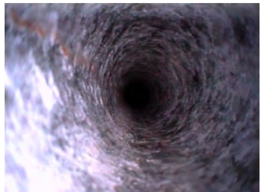
Bild 4: Bohrung 553012; elliptische Bohrlochkontur bei ca. 40 m Bohrlochteufe, Aufnahme vom 24.11.2020
