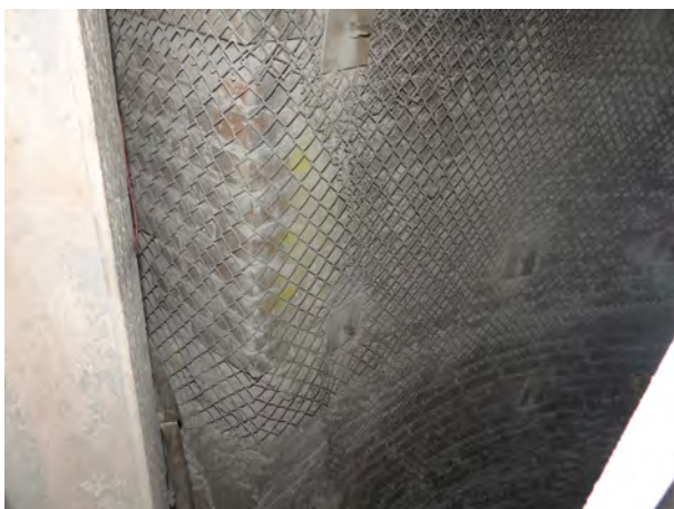
(c) Blick vom Schachtkorb auf den westlichen Stoß (Ziegelmauerwerk mit Stahlanker und Maschendrahtverzug) im Schacht 2 auf der 490-m-Sohle, Stand: 06.01.2021
