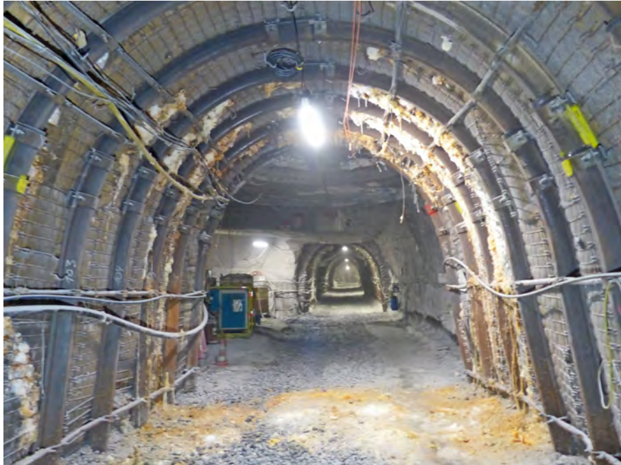
Abbildung 4.36: Gleitbogenausbau in Abbau 2 mit korallen- und stalaktitenförmigen Salzausfällungen sowie Kristallinat auf der Schottersohle im östlichen Übergang zum Pfeiler 2/3, Blick nach Osten, 06.01.2021
