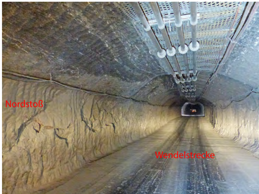
Abbildung 4.17: Wendelstrecke im Bereich der 679-m-Sohle im Bereich der Abbaureihe 2/3 mit zunehmend geschädigten Stößen, Blick nach Westen (05.01.2021)
