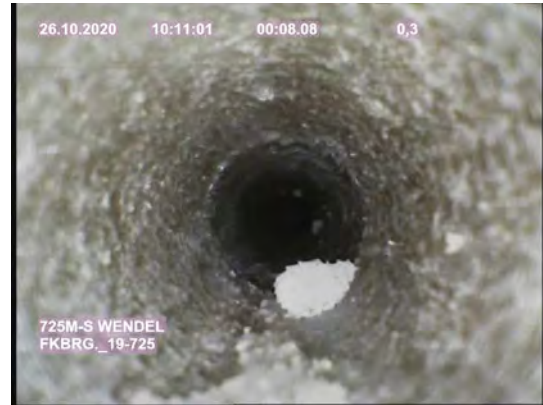
Bild 56: Salzausblühungen in feuchter Kontur (FKBrG.725-19, Teufe: 0,30 m)
