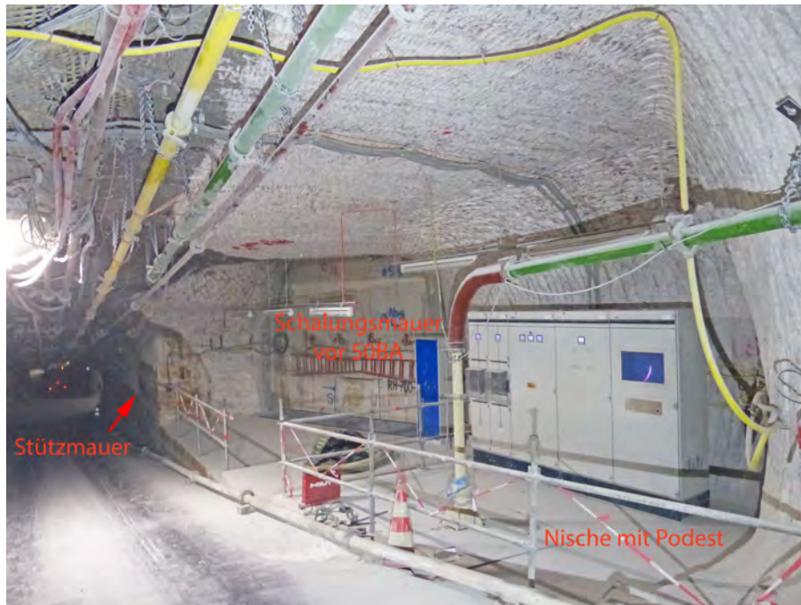
Abbildung 4.26: Abgemauerter Zugang zum ehemaligen Standort der Baustoffanlage 50BA mit Stützmauer am Wendelstreckenstoß im Norden und südlich aufgeweiteter Nische als Podest für Schaltschränke, Blick nach Norden (05.01.2021)
