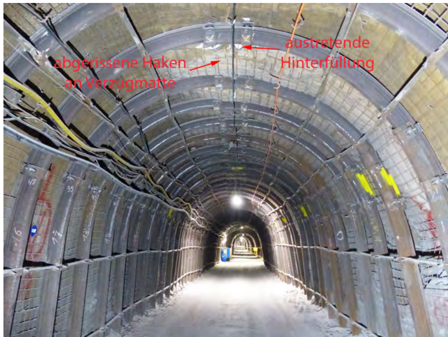
Abbildung 4.35: Gleitbogenausbau im Abbau 1/725 mit Schädigungen der Verzugsmatten sowie einhergehendem Austritt von Hinterfüllungsmaterial im Firstbereich der Gleitbögen 16 und 17, Blick nach Osten, 05.01.2021
