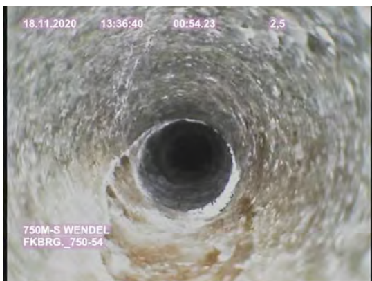
Bild 59: Riss mit geringer Öffnungsweite (FKBrG.750-54, Teufe: 2,40 m)
