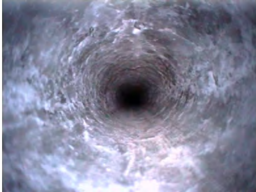
Bild 1: Bohrung 532015; elliptische Bohrlochkontur und kleinere Ausbrüche bei ca. 41 m Bohrlochteufe, Aufnahme vom 24.11.2020
