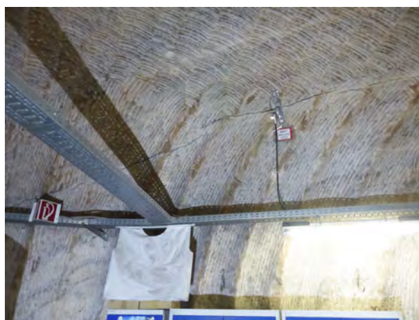
(b) Riss am Südstoß im Pausenraum der E-Werkstatt mit Fissurometer 020F, Stand: 06.01.2021
