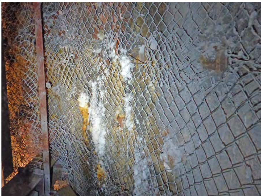
Abbildung 4.50: Schwach tropfende Katasterstelle P750157 mit stalaktitenförmigen Salzausfällungen, Blick nach Süden (03.02.2021)
