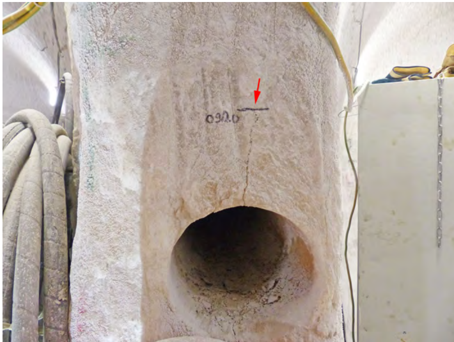
Abbildung 4.32: Riss von geringer Öffnungsweite oberhalb des Ansatzes von VorEBrg. 700-1a.1 - die September 2020 gesetzte Markierung wurde bislang nicht überschritten, Blick nach Osten (06.01.2021)
