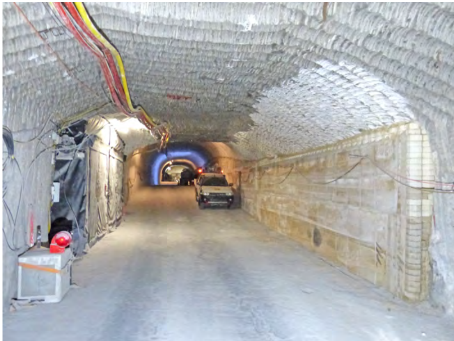
Abbildung 4.58: Nördliche Richtstrecke n. Osten östlich des Querschlags mit Grubenwehrraum mit nachgeschrittener Kontur und Stützmauer entlang des Südstoßes. Blick nach Südosten (05.01.2021)
