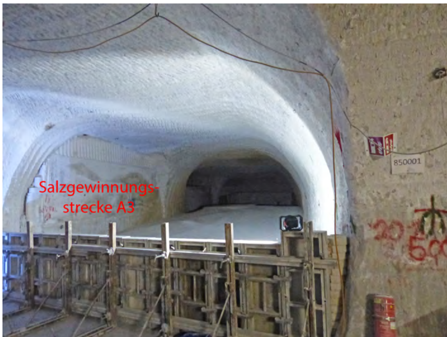
Abbildung 4.23: Sukzessive Verfüllung des östlich der Wendelstrecke auf der 850-m-Sohle abgehenden Streckenansatzes zu den Salzgewinnungsstrecken, Blick nach Osten (05.01.2021)
