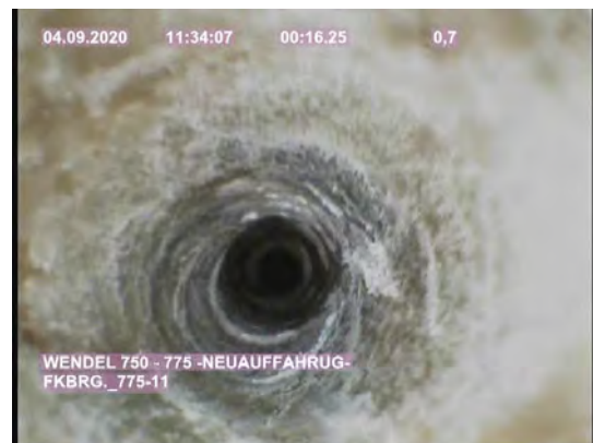
Bild 60: Ausblühungen an beanspruchter Kontur (FKBrG.775-11, Teufe: 0,70 m)
