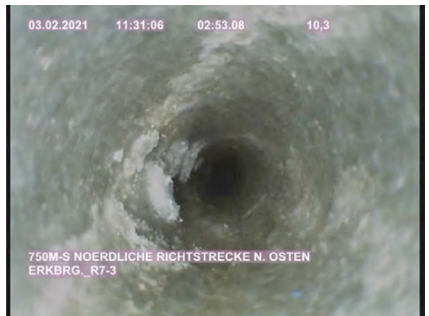
Bild 78: EBrG. R7.3 – Position bei ca. 10,0 m Salzausblühungen an potentieller Auflocke- rung
