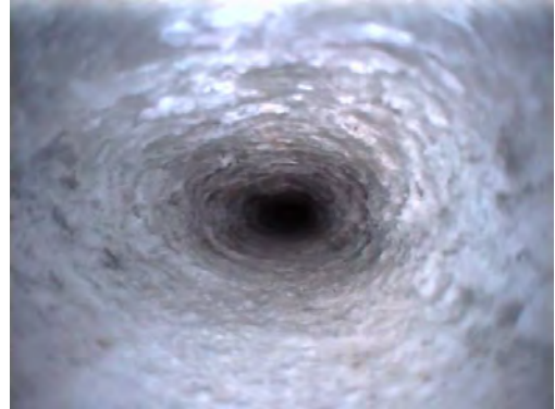
Bild 2: Bohrung 658010; elliptische Bohrlochkontur bei ca. 13 m Bohrlochteufe, Aufnahme vom 23.11.2020
