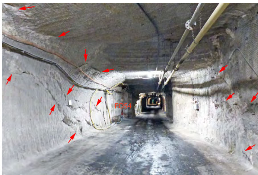
Abbildung 4.52: Nördliche Richtstrecke nach Westen zwischen westl. Umfahrung und Schacht 4/750 mit teilweise bis zum Übergang Stoß/Firste geschädigten Stößen, Blick nach Nordwesten (03.02.2021)
