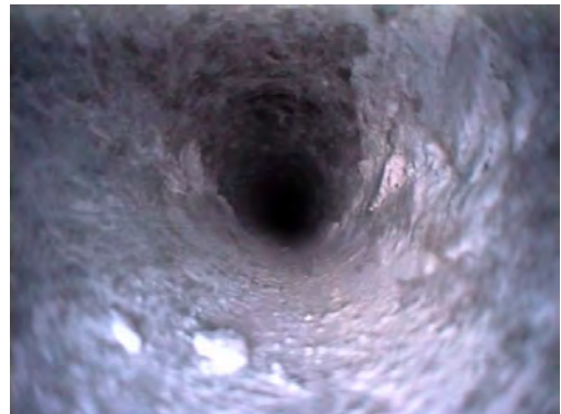
Bild 10: Bohrung 700005; Ausbruch in der westlichen Bohrlochwand bei ca. 38 m Bohrlochteufe, Aufnahme vom 26.11.2020
