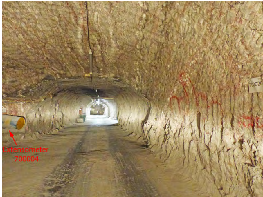
Abbildung 4.33: Intensive Abschaltungen am Nord- und Südstoß der Richtstrecke nach Osten im Firstniveau auf Höhe der Abbaue 12-13 mit Extensometer 700004 im Pfeiler 12/13, Blick nach Westen (22.01.2021)
