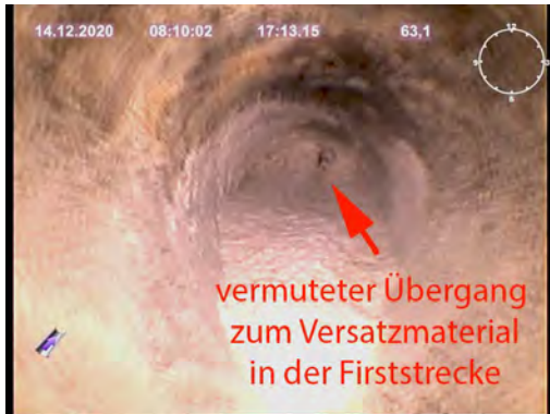
Bild 61: Übergang in Versatz der Firststrecke n. W./616, westl. Zugang Abb. 4/616 (SKBrg.553-01, Teufe: 63,20 m)
