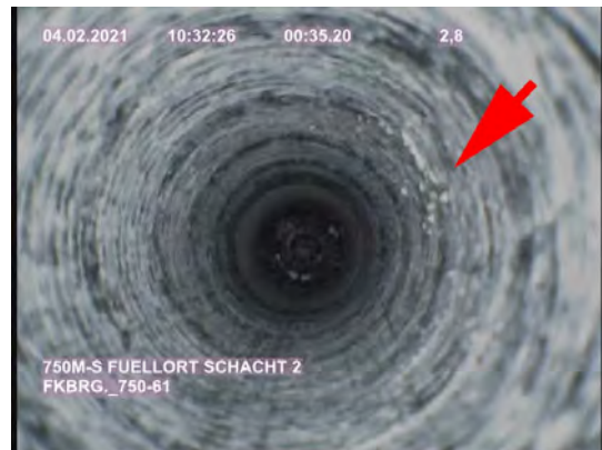
Bild 72: Beginnende Ausblühungen in leicht feuchter Bohrlochkontur (FKBrg.750-61, Teufe: 2,80 m)
