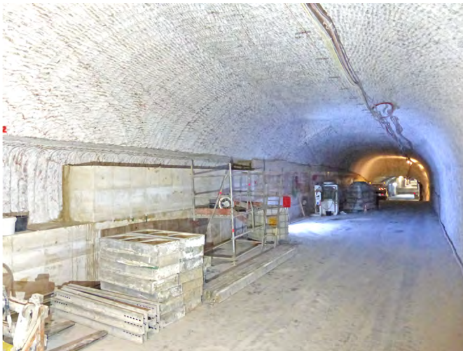
Abbildung 4.59: Schalungsarbeiten im Mittelteil der am Südstoß im östlichen Abschnitt der nördliche Richtstrecke n. Osten erstellten Stützmauer. Blick nach Südosten (05.01.2021)
