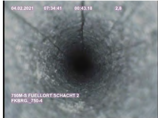
Bild 70: Beginnende Ausblühungen in leicht feuchter Bohrlochkontur (FKBrg.750-04, Teufe: 2,70 m)
