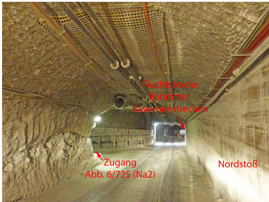
Abbildung 4.18: Intensiv entfestigter Südstoß östlich des Zugangs von Abbau 6/725 (Na2) im Wendelstreckenabschnitt von der 700- zur 725-m-Sohle, der Nordstoß wurde bis unterhalb des Querschlags zum Hauptgesenk I westl. mit einer Stützmauer saniert, Blick nach Nordwesten (05.01.2021)
