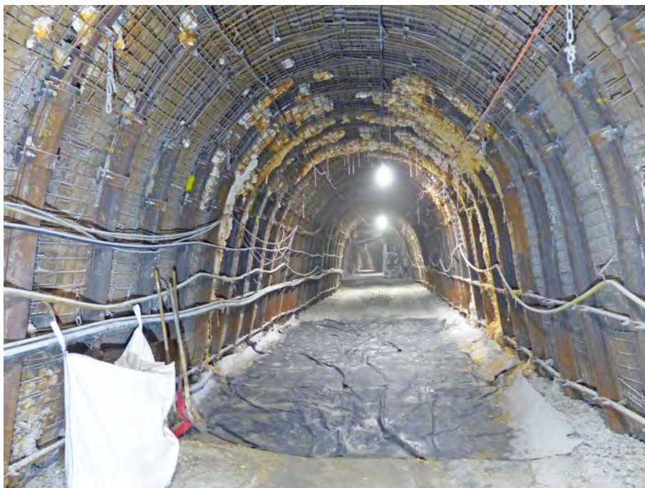
Abbildung 4.38: Planen auf der Sohle zum Auffangen von Lösung im zentralen Bereich des Gleitbogenausbaus in Abbau 3 mit aktiven korallen- und stalaktitenförmigen Salzausfällungen, Blick nach Osten, 06.01.2021
