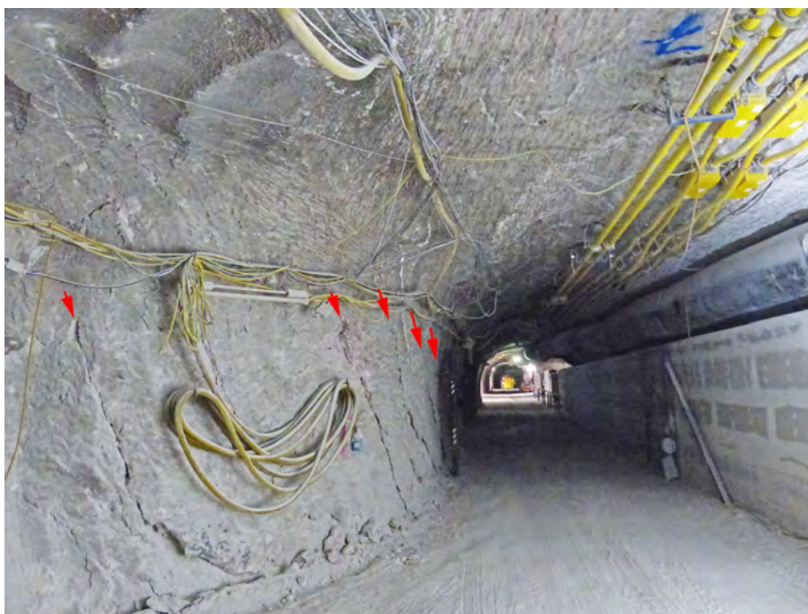
Abbildung 4.30: Vahlberger Strecke mit entfestigtem Südstoß unmittelbar westlich der Einmündung des Querschlags zum Blindschacht 3 sowie abgetrenntem Fahrtrum am Nordstoß, Blick nach Westen (06.01.2021)
