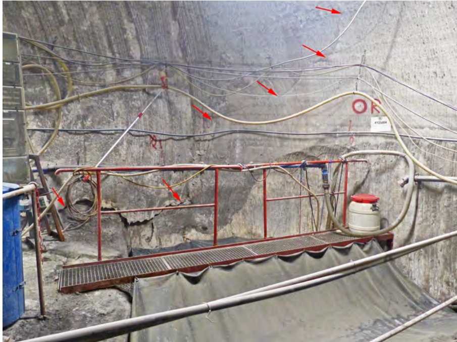
Abbildung 4.37: Katasterstelle P725004 in Pfeiler 2/3 mit Abschalungen am Nordstoß, Blick nach Norden, 06.01.2021
