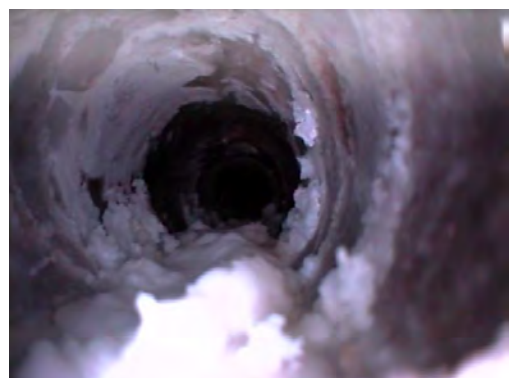
Bild 6: Bohrung 679006; Ausbruch in der Firste und feuchtes Hautwerk in der Sohle bei ca. 4 m Bohrlochteufe, Aufnahme vom 02.12.2020
