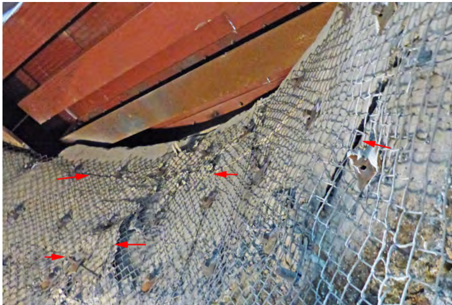
Abbildung 4.49: Intensiv geschädigter Betonring mit zunehmender Rissbildung und Abplatzungen im östlichen Auflagebereich der Füllortbühne - einzelne Anker sind nicht mehr intakt, Blick nach Nordosten (03.02.2021)
