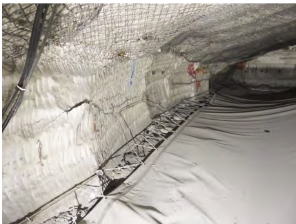
(c) Abschalungen am südlichen Stoß von Lösungsbecken 2 im Abbau 3/490, Stand: 06.01.2021
