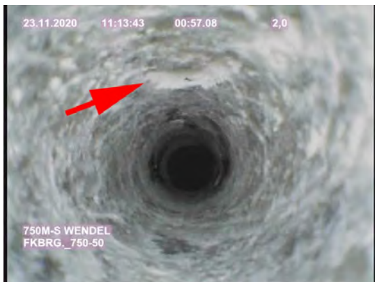
Bild 57: Riss mit Öffnungsweite von ca. 1 bis 2 mm (FKBrG.750-50, Teufe: 1,90 m)
