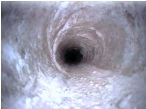
Bild 9: Bohrung 574007; Ausbruch der Bohrlochwand bei ca. 26 m Bohrlochteufe, Aufnahme vom 25.11.2020
