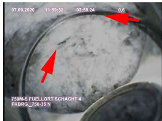
Bild 74: Rissförmiger Konturausbruch (FKBrg.750-35, Teufe: 0,60 m)
