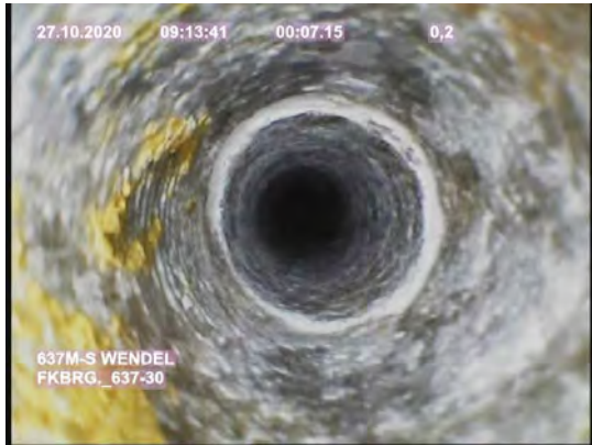
Bild 55: Riss mit geringer Öffnungsweite von ca. 1 mm (FKBrG.637-30, Teufe: 0,20 m)
