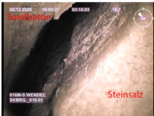
Bild 63: Firstspalt im Übergang Salz/Sorelbeton, Firstniveau 637-m-S (SKBrg.616-01, Teufe: 16,70 m)
