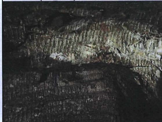
Photo 33: keine Probenahme möglich, da möglicher Lösefall (MP RS-c)
