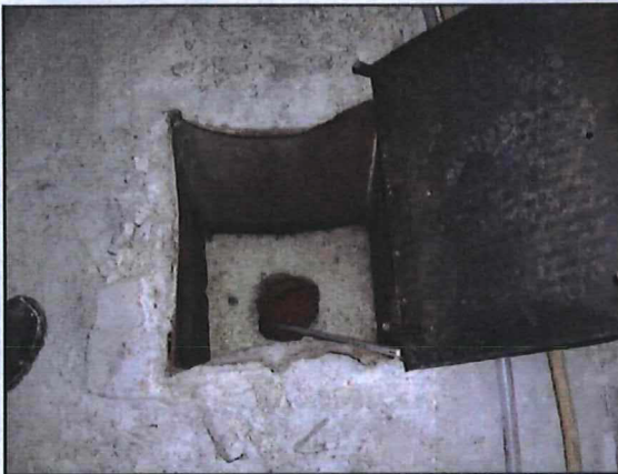
Photo 43: Laugenmessstelle MP_L2, 750-m Sohle
