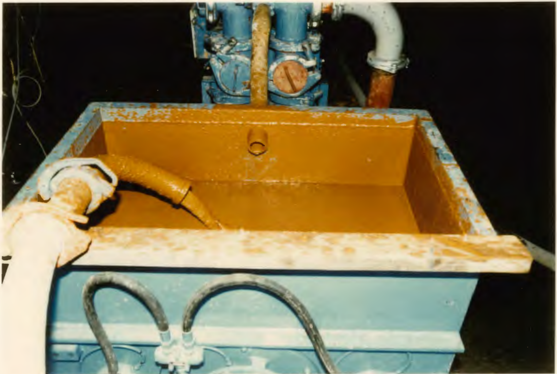
29. Rohraustrag in der Pumpenvorlage - Erz
