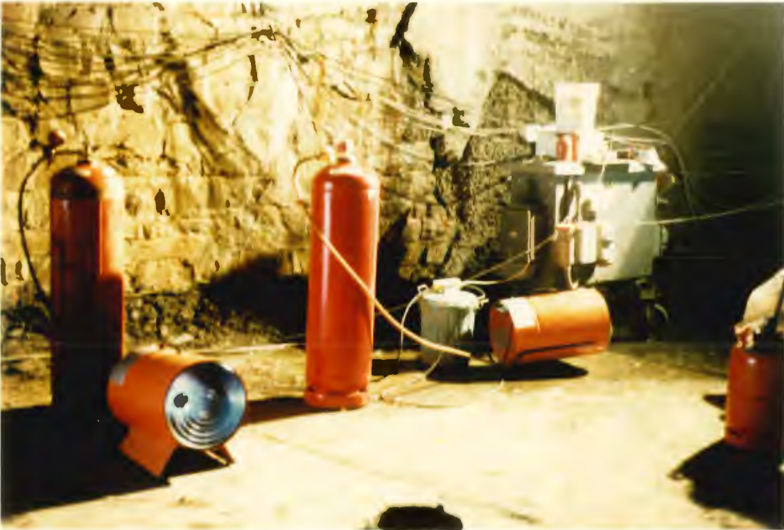
53. Beheizung der Misch- und Pumpstation
