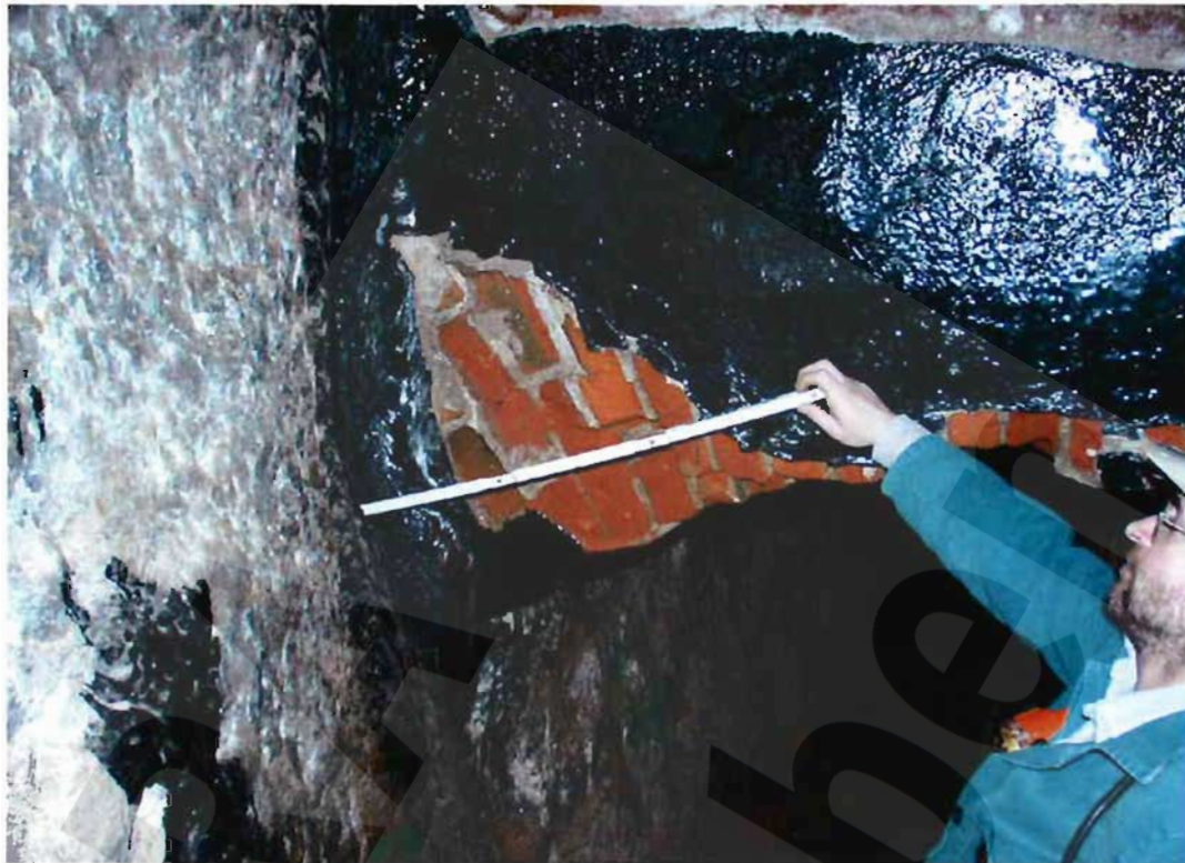
Bild 5: Gewölbesegment 20 bei ca. -187 mNN; ältere Abplattung an der Stirnfläche Stand: 23.01.2002
