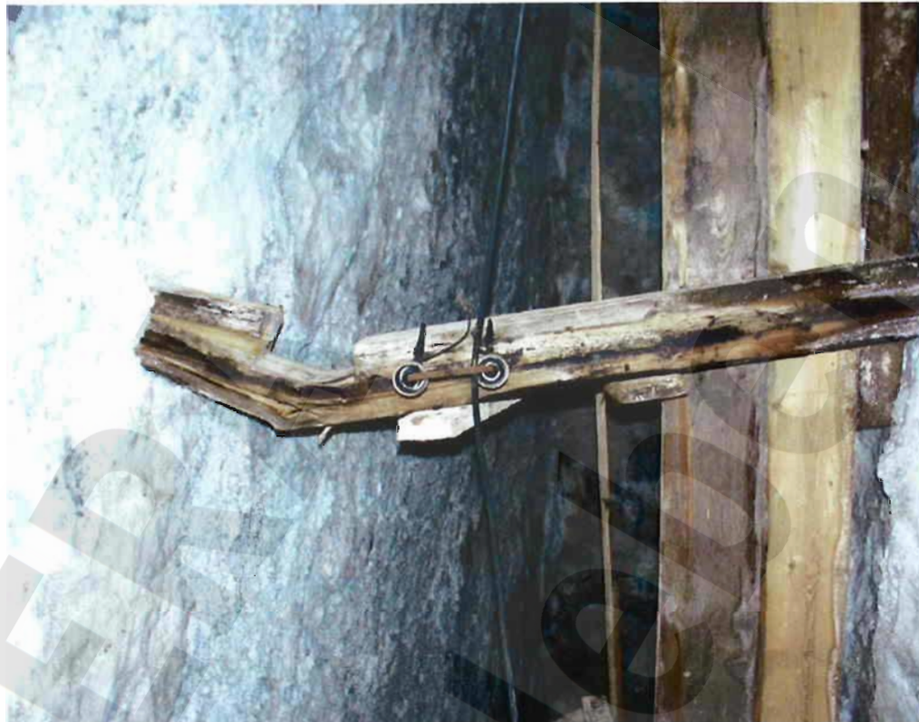
Bild 10: Lager H – gebrochener horizontal querschlägig eingebauter Bühnenträger bei -188 mNN Stand 23.01.2002
