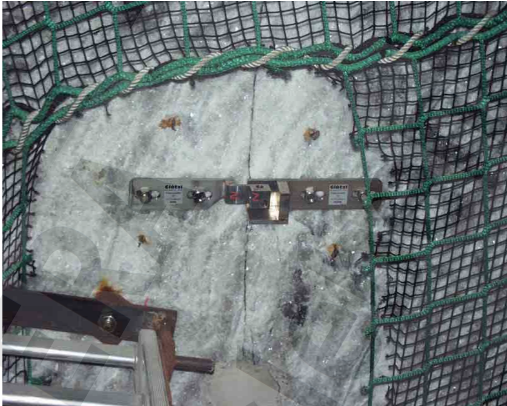
Abbildung 1: Firste des Durchhiebs 17YEA63/R007 (Durchrieb 4, 4. Sohle) zum Abbau 16YEA61/R003 (Abbau 2, 4a Sohle). Rissfläche an der Firste mit Fissurometer CG188F. Stand: 26.01.06
