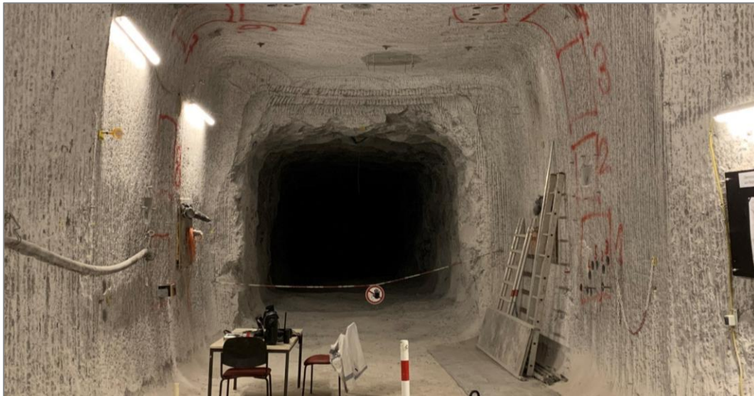
Standort des Demonstrationsbauwerk für eine Streckenabdichtung im Anhydrit auf der 3. Sohle Schacht Bartensleben
