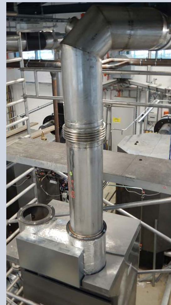
Blick auf Holzpelletkessel
