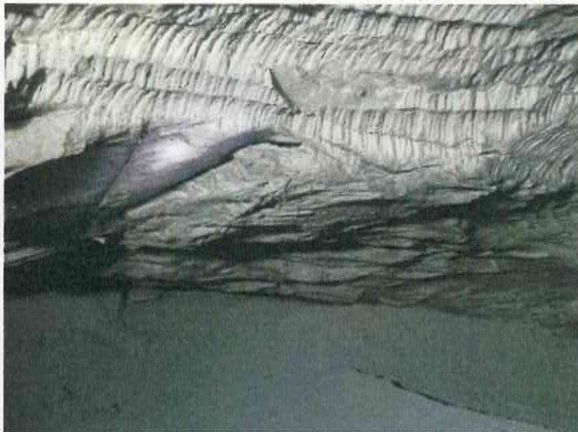
Abbildung 23: ELK 7/725 Abschalungen a. d. Firste oberhalb der Gebinde Archiv-Nr.: 20090427_01, Aufnahme vom April 2009
