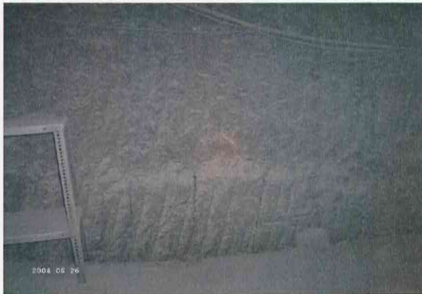
Abbildung 7: Nordstoß ELK 4/750, Risse im Pfeiler Blick von der 2. südlichen Richtstrecke nach Westen in Richtung Süden Archiv-Nr.: 20050422-19.jpg, Aufnahme vom 22.04.2005
