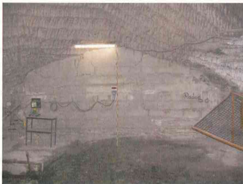
Abbildung 47: Westlicher Zugang zur ELK 12/750
