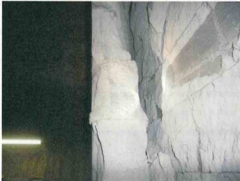
Abbildung 50: Schädigung der Abschlussmauer zur sdl. Richtstrecke nach Osten Nahaufnahme der Verformung Archiv-Nr.: 20090324-2.jpg; Aufnahme vom 24.03.2009
