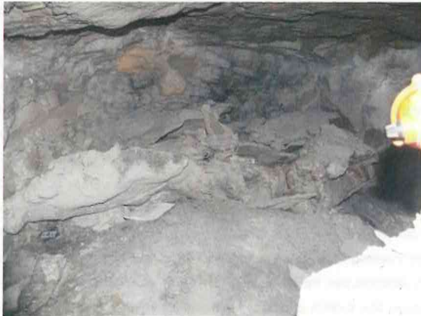
Abbildung 32: Östlicher Zugang zur ELK 8/750 – hinter der geschädigten Abschlussmauer Blick von der 2. südlichen Richtstrecke nach Westen Archiv Nr.: L 1050628; Aufnahme vom: 03.03.2009
