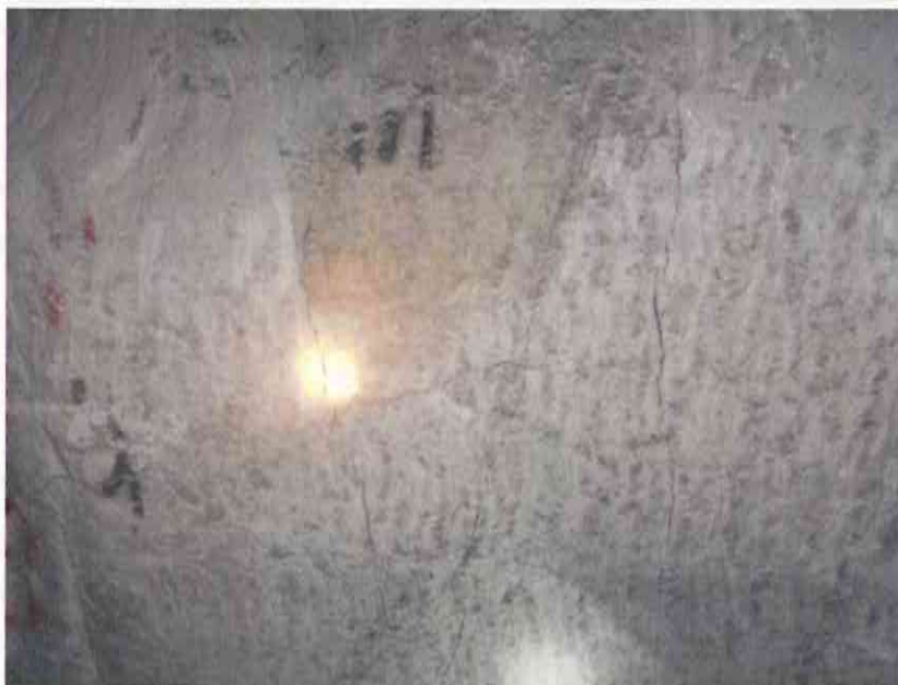
Abbildung 41: Risse im Pfeiler zwischen ELK 4/750 und Abbau 3/750 Blick vom Abbau 3/750 nach Westen Archiv Nr.: 20080115-2; Aufnahme vom: 15.01.2008
