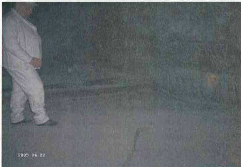
Abbildung 8: Querschl. Riss zw. ELK 4/750 und dem Zugang zum Blindschacht 2 (Sohle)
