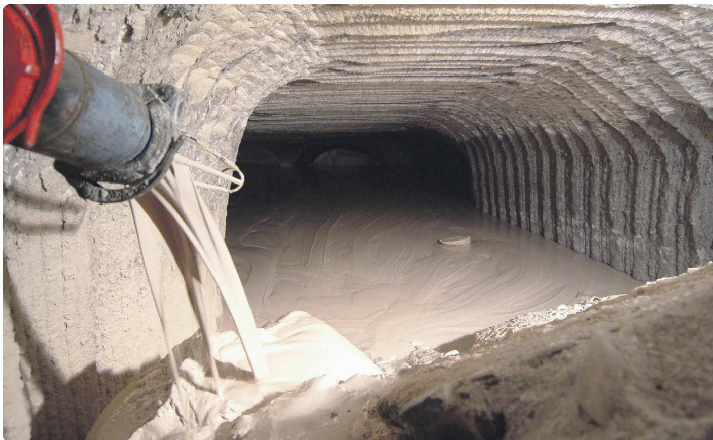
Hier wird ein ehemaliger Salzabbau mit Sorelbeton verfüllt. Sorelbeton ist ein spezieller Bergbau- beziehungsweise Salzbeton, der aus Magnesiumoxid, einer Magnesiumchloridlösung und Steinsalz besteht. Dieser Beton wird für die Verfüllung von Grubenräumen im Salz verwendet.
