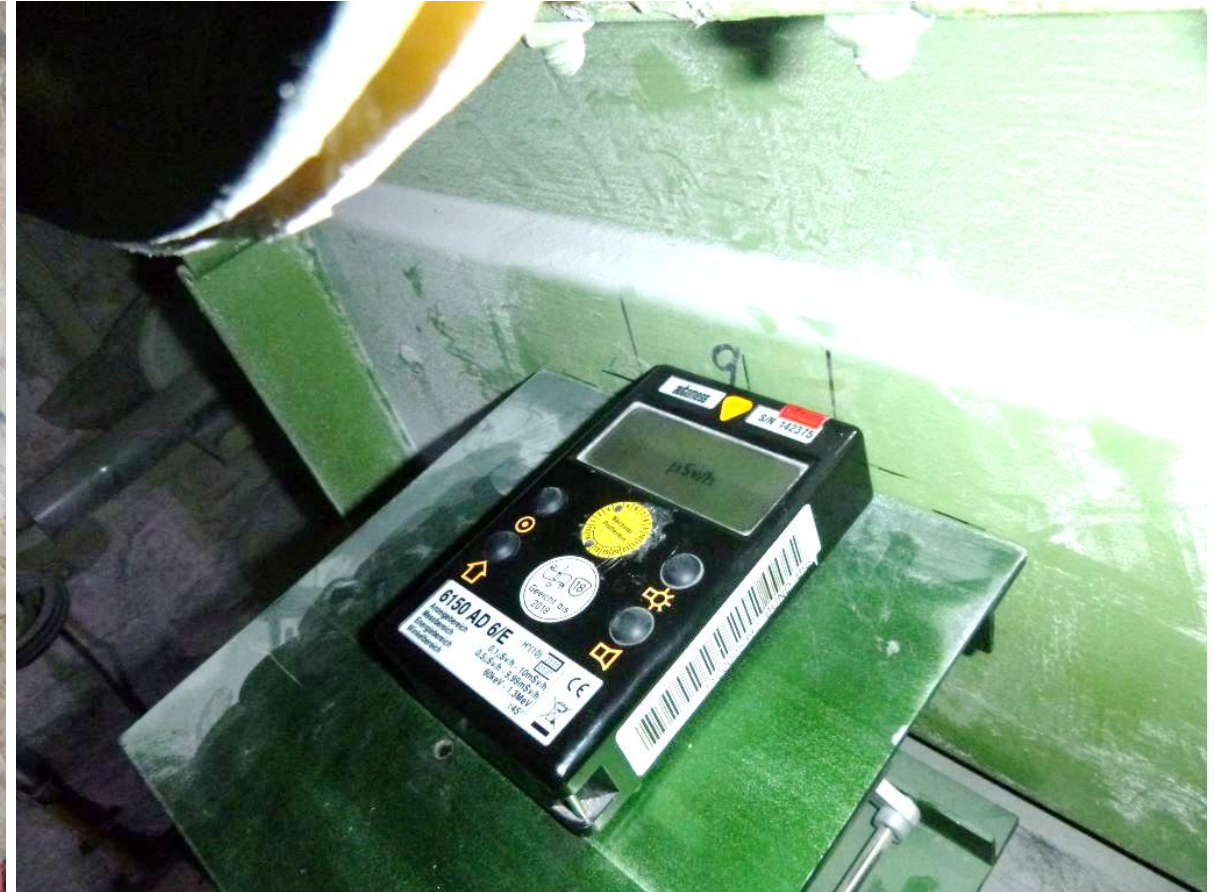
Messung der Ortsdosisleistung am Filtergehäuse
