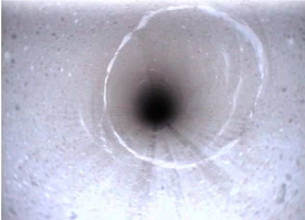
Foto 3e: Riss bei 30,60 m, neu
