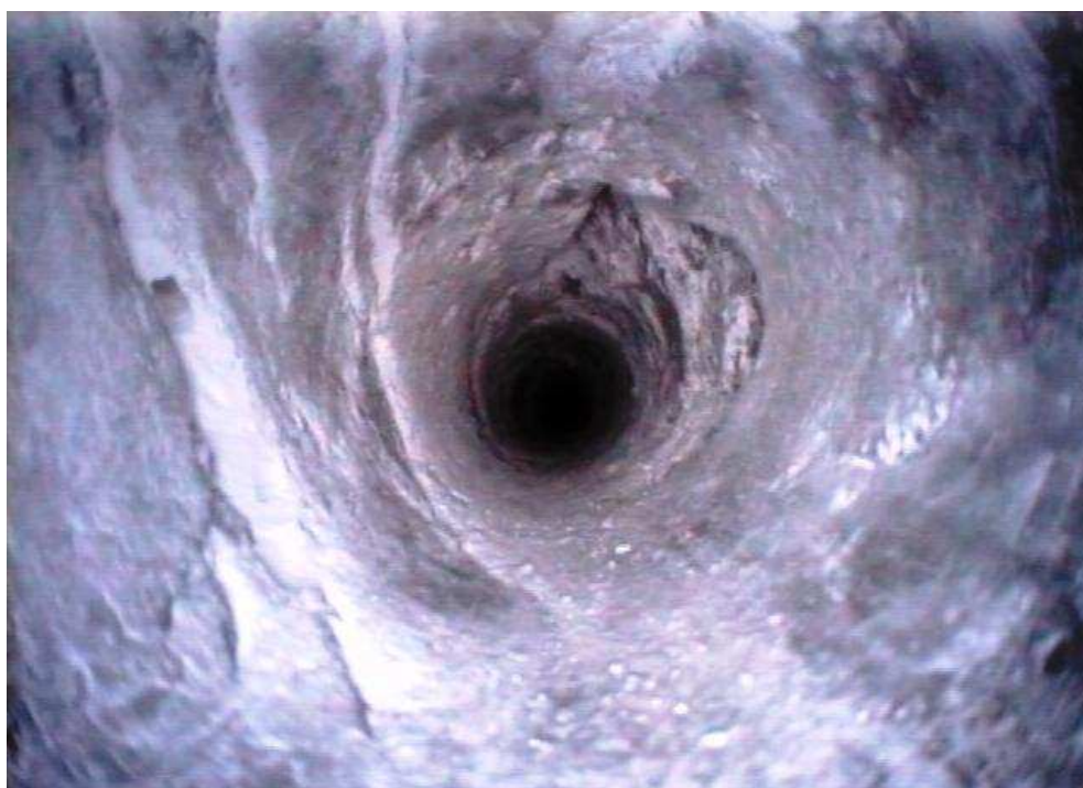
Foto 6b: Ausbruch/Riss im Westen bei 26,45 m
