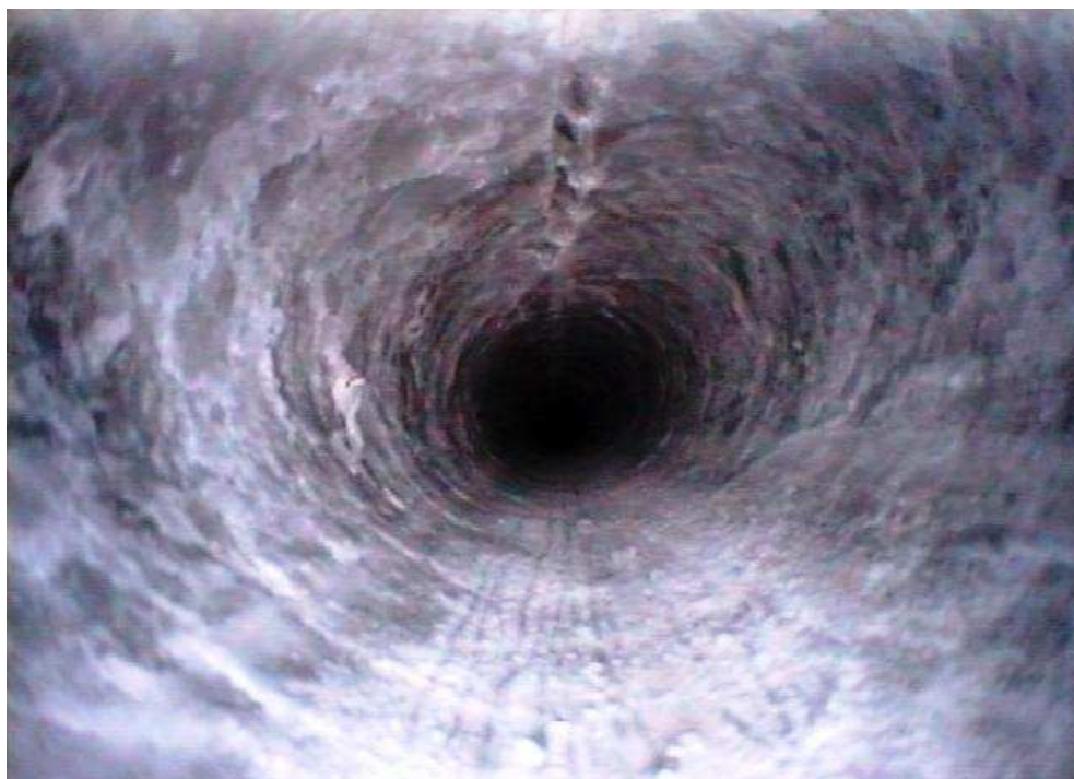
Foto 4g: Riss in der Firste bei 13,60 m
