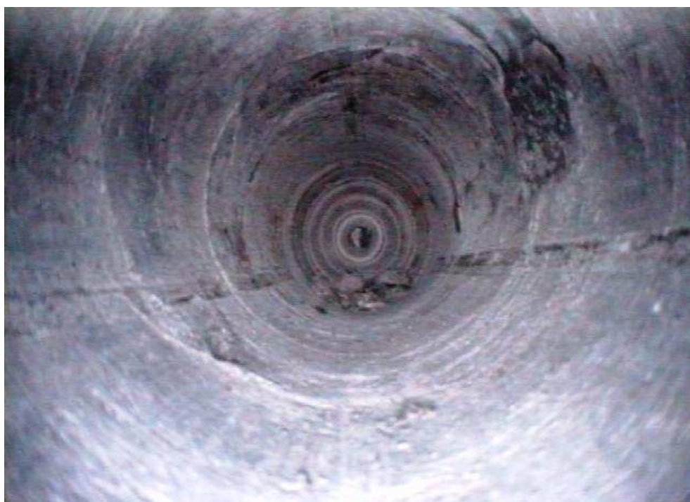
Foto 4l: Ausbrüche bei 48,40 m und Bohrlochende bei 48,59 m
