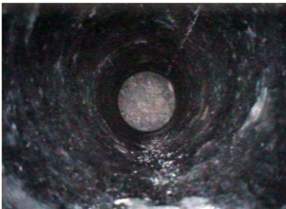
Foto 8b: Bohrlochende bei 44,62 m leicht feucht
