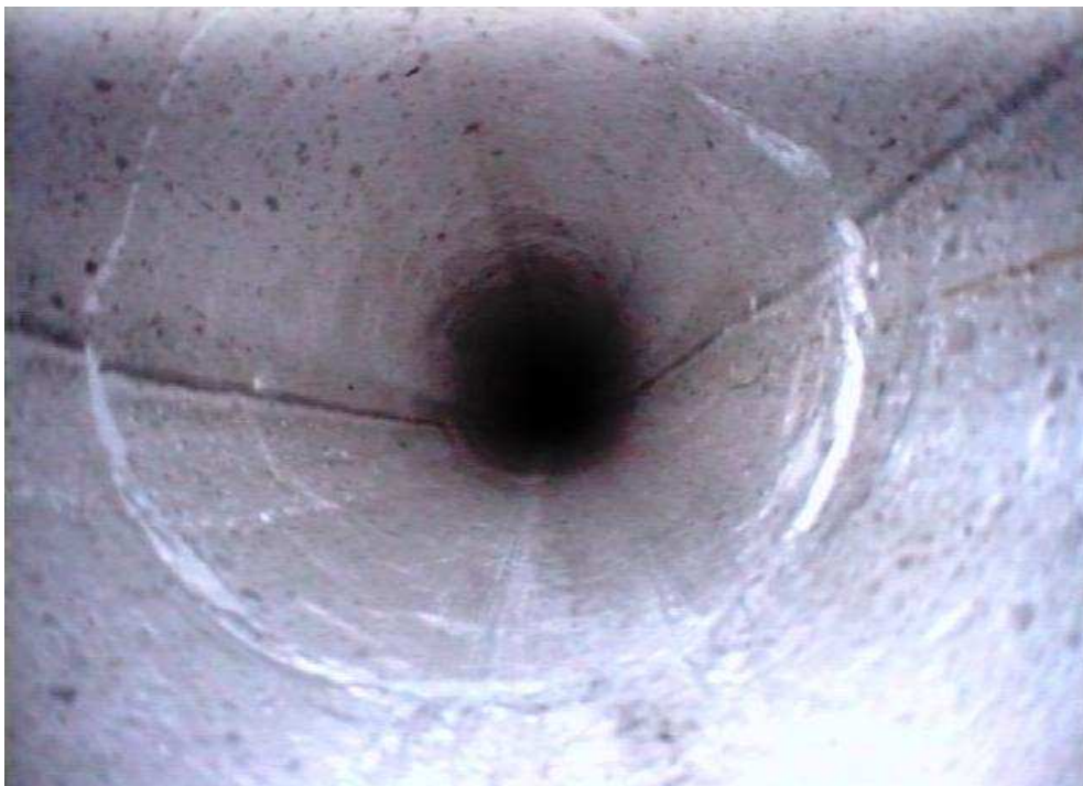
Foto 9b: Leichter Riss/Ausbruch bei 21,27 m
