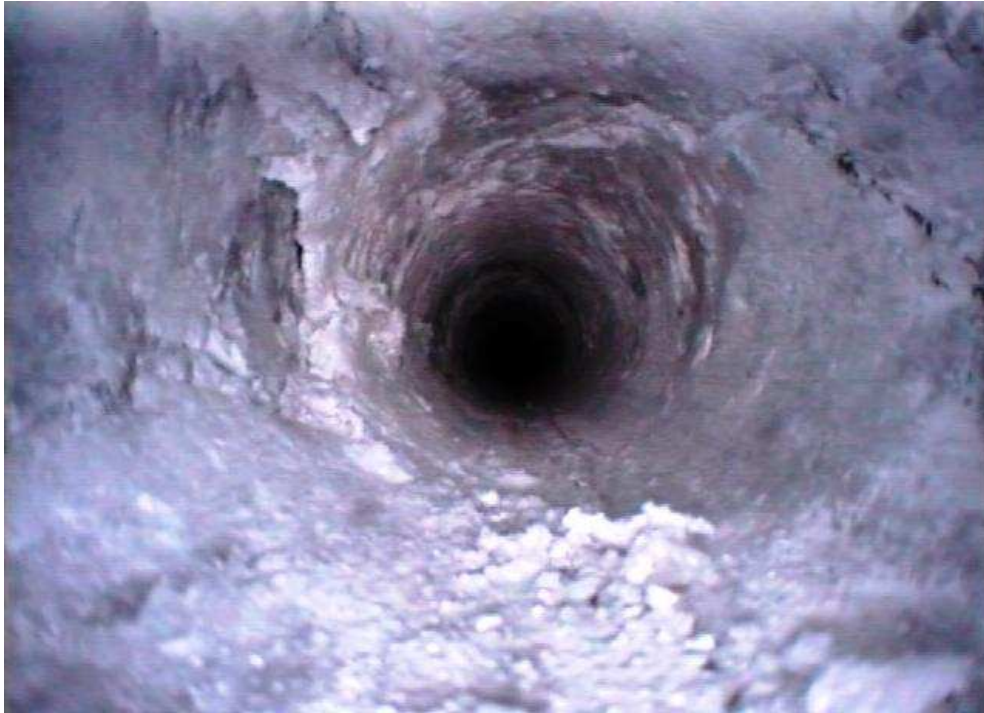
Foto 6e: Ausbruch und Risse bei 27,25 m
