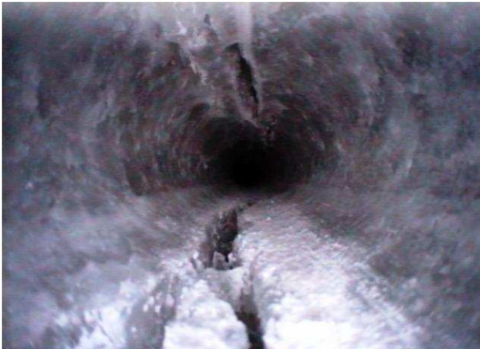
Foto 4c: Riss in der Sohle und Firste bei 9,90 m
