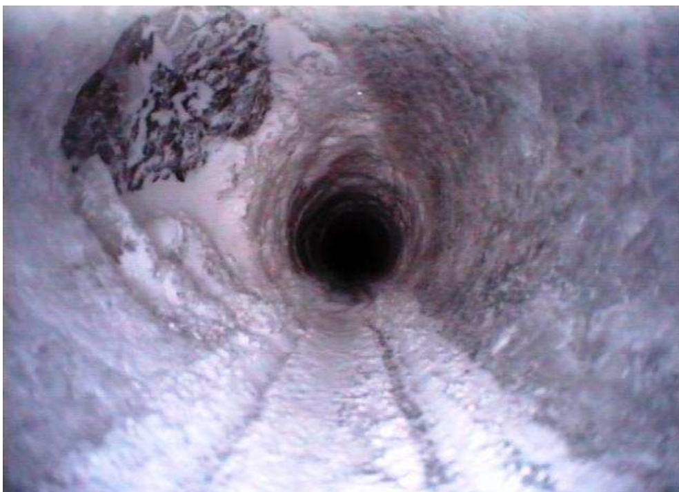
Foto 5b: Ausbruch östliche Bohrlochwand bei 25,0 m
