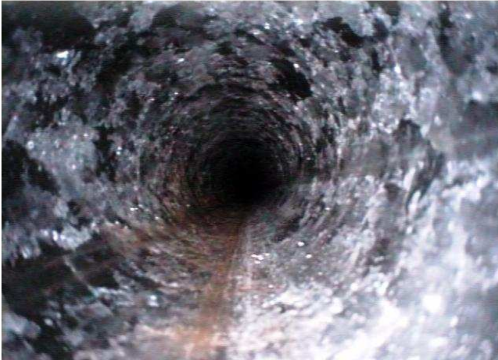
Foto 11c: Bohrloch feucht und braune Stellen bei 22,40 m
