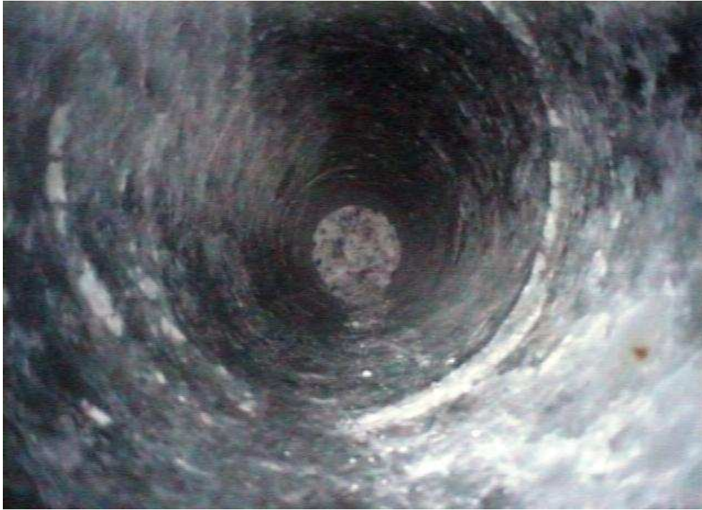
Foto 1c: Ausblühungen, kleiner brauner Fleck im Westen 57,85 m
