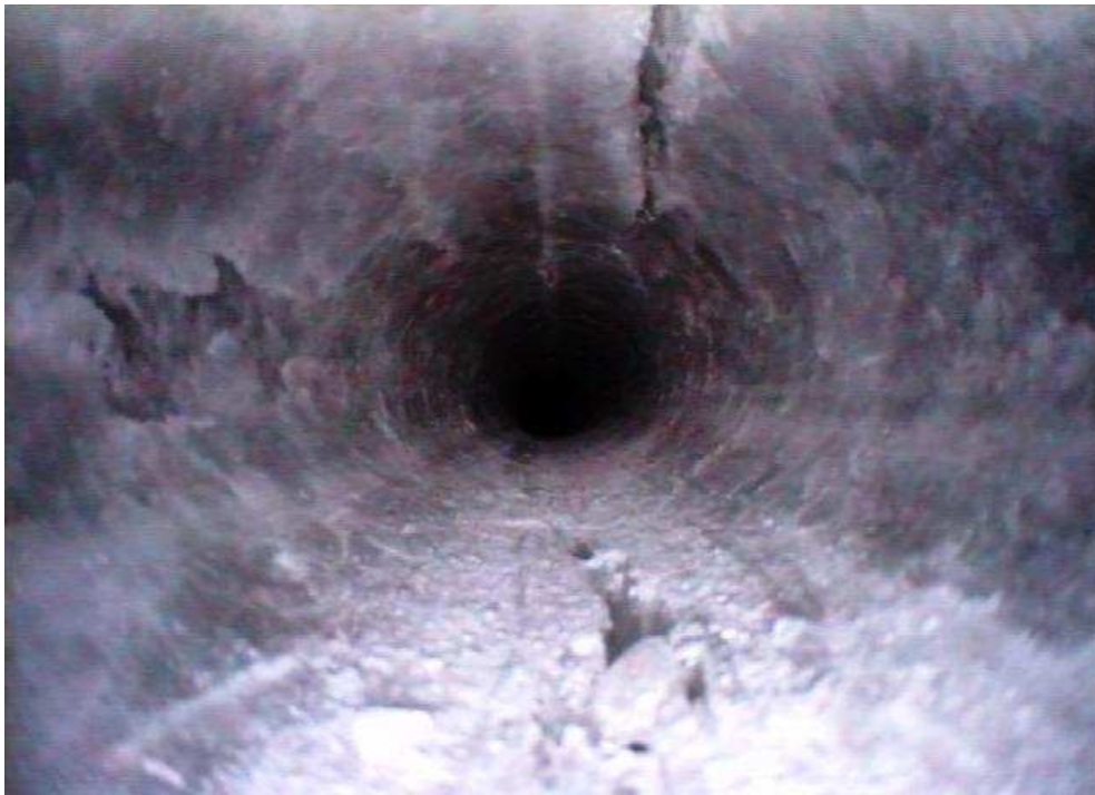
Foto 4e: Riss in der Sohle und Firste bei 10,10 m
