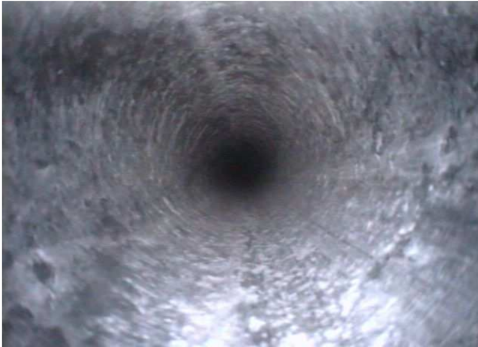
Foto 1a: Kleiner Riss im Westen bei 14,30 m
