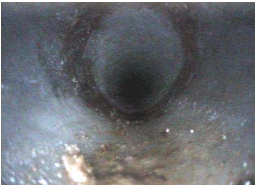
Foto 2b: Grenze K2C/Na 3 bei 1,00 m, Bohrloch feucht
