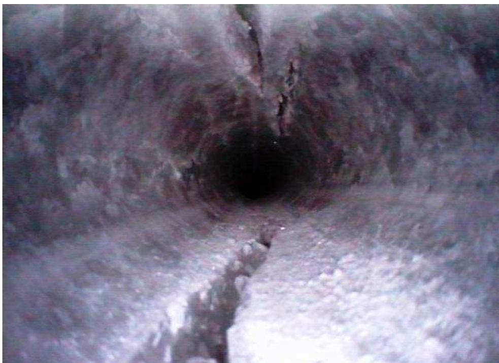
Foto 4d: Riss in der Sohle und Firste bei 10,00 m
