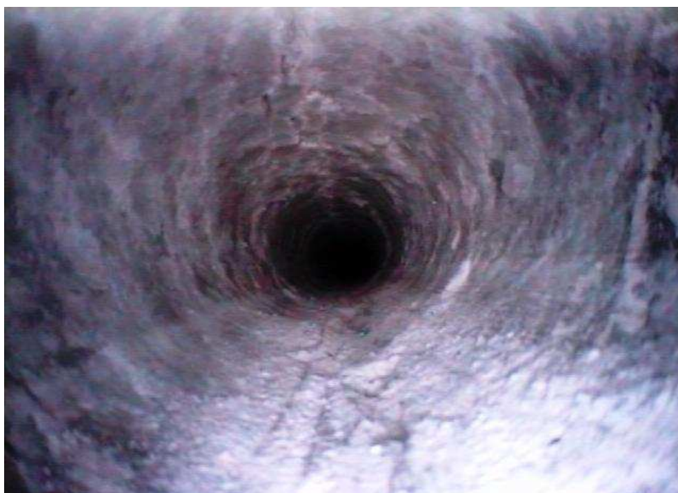
Foto 4h: Riss in der Firste und Sohle bei 14,00 m
