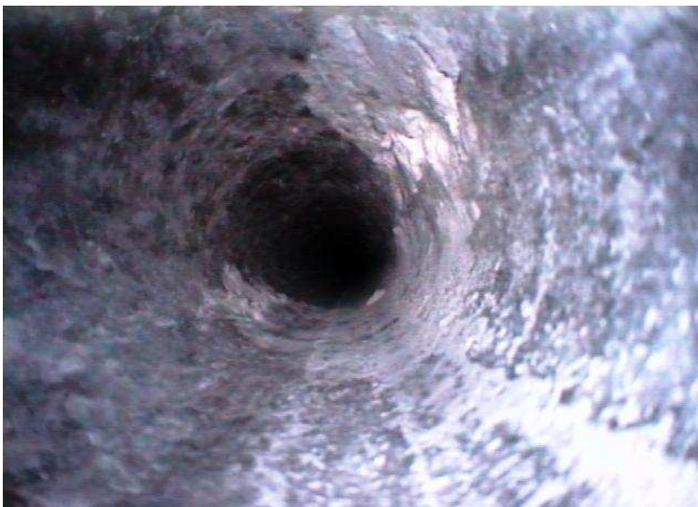
Foto 12b: Ausbruch bei 38,55 m
