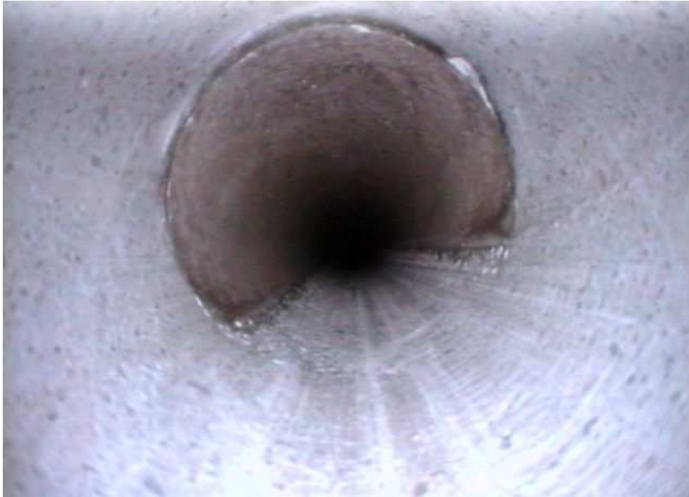
Foto 3c: Anfang Mauer bei 10,75 m
