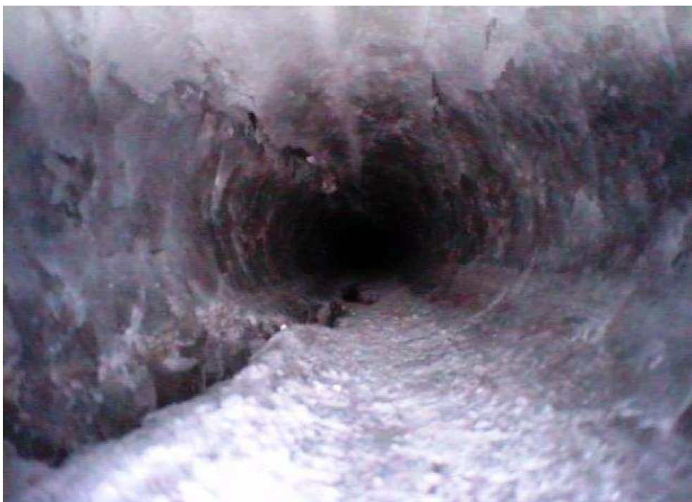
Foto 4b: Riss im Osten bei 9,70 m
