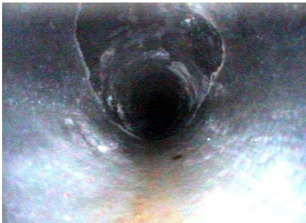
Foto 2c: Ausbruch oder Ausspülung bei 1,80 m, Bohrloch feucht
