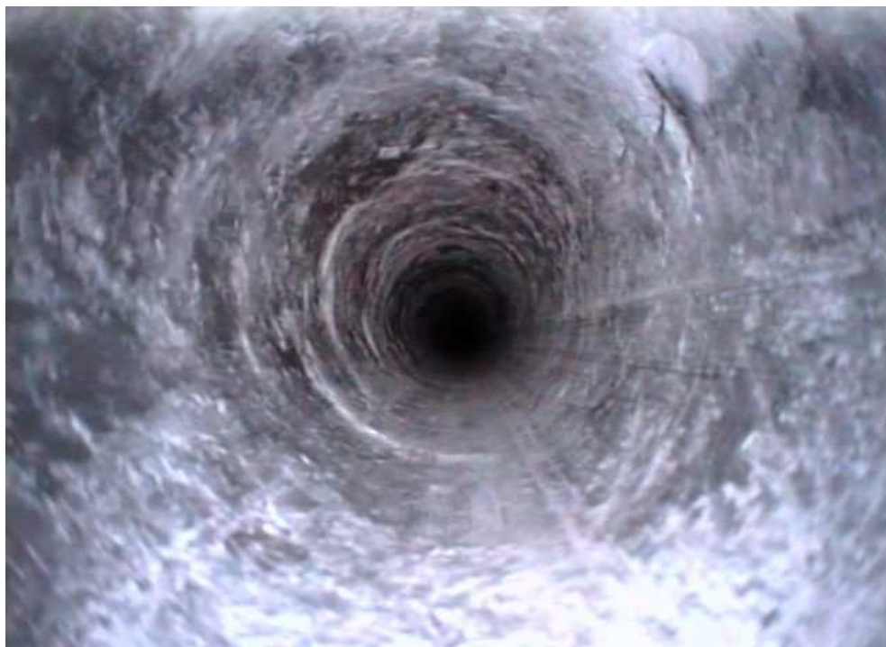
Foto 6a: Kleiner Ausbruch im Westen bei 21,40 m
