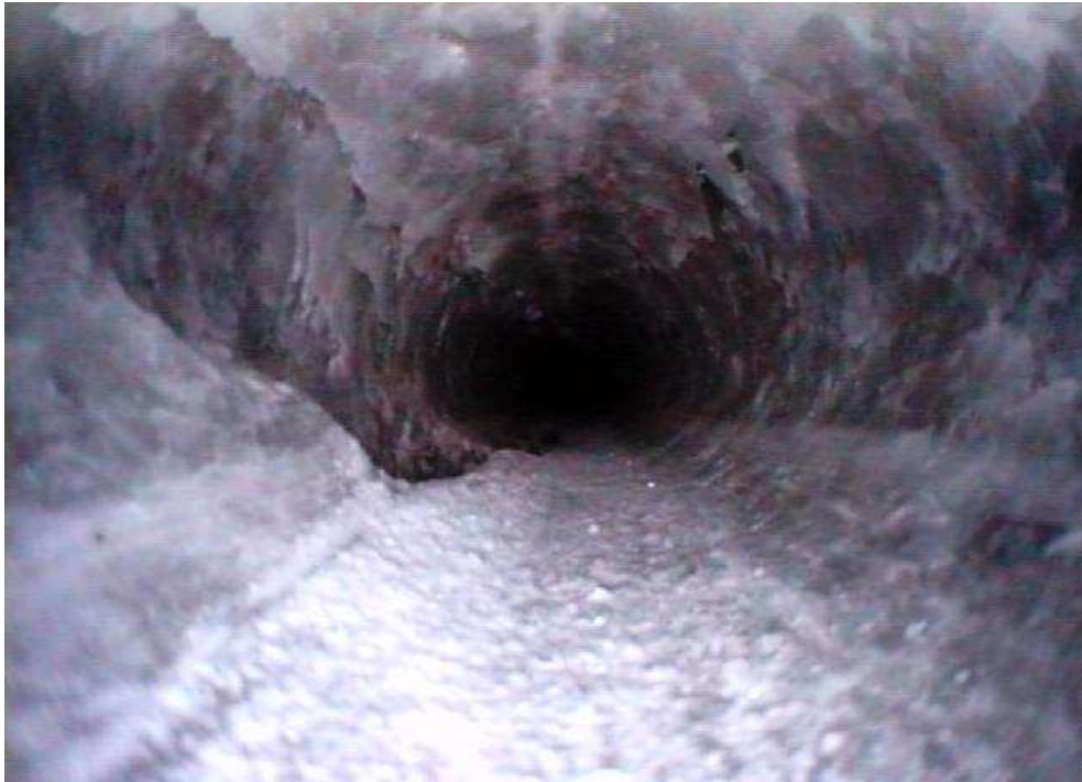
Foto 4a: Riss, Ausbruch bei 9,60 m
