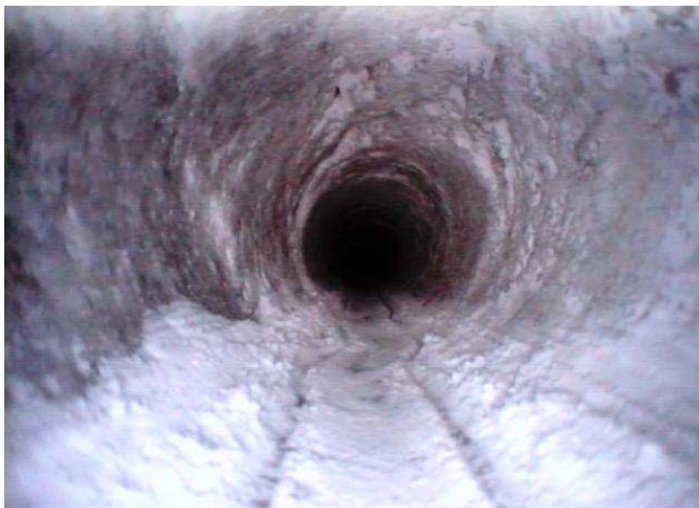
Foto 5c: Ausbrüche in der Sohle und Firste bei 25,25 m
