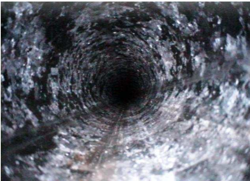
Foto 11d: Bohrloch feucht bei 23,30 m
