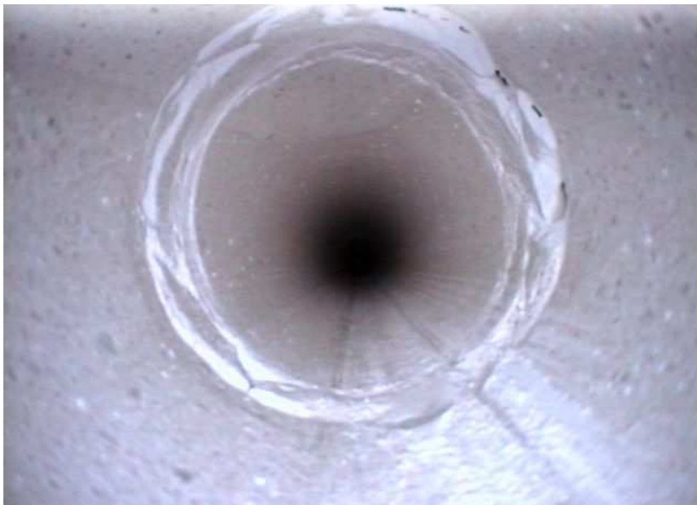
Foto 3f: Kluft bei 41,24 m
