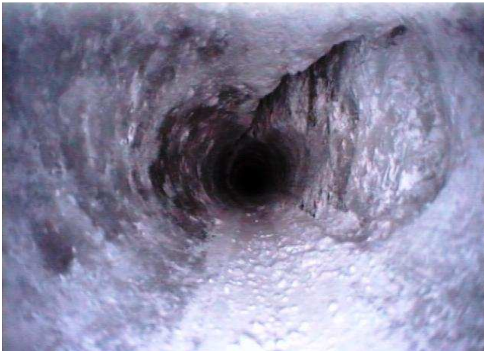
Foto 6f: Riss von Westen nach Osten bei 29,00 m
