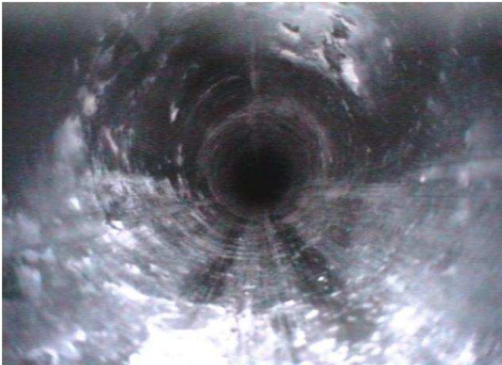
Foto 4i: Ausblühungen und Ausbrüche bei 29,55 m
