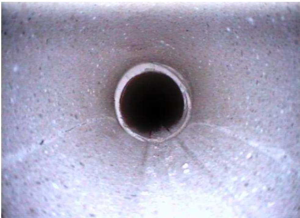
Foto 3h: Riss östliche und westliche Bohrlochwand bei 43,90 m
