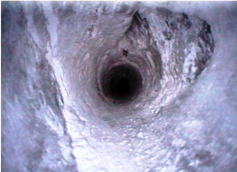
Foto 6c: Ausbruch/Riss im Westen bei 26,55 m
