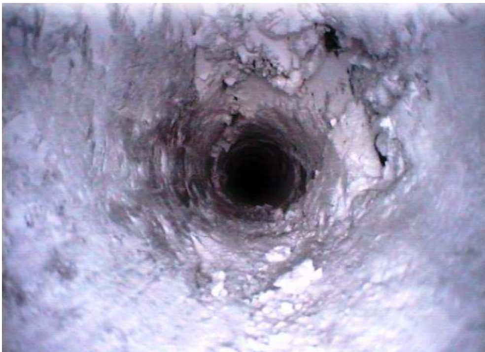
Foto 6d: Ausbruch und Risse bei 26,90 m
