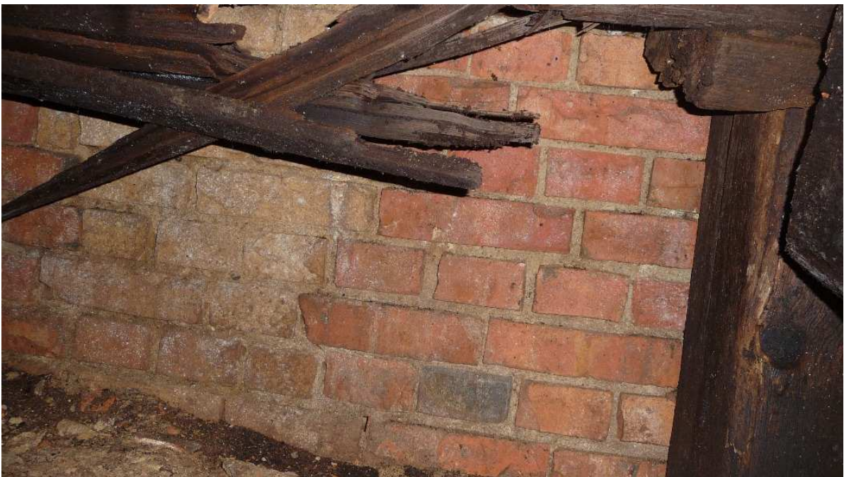
Abbildung 30: Blick in den süd-östlich freigelegten Hohlraum (siehe Pos. 2 Bild 29) mit Ziegelmauer (ca. 0,5 m Höhe) mit Blickrichtung W-O
