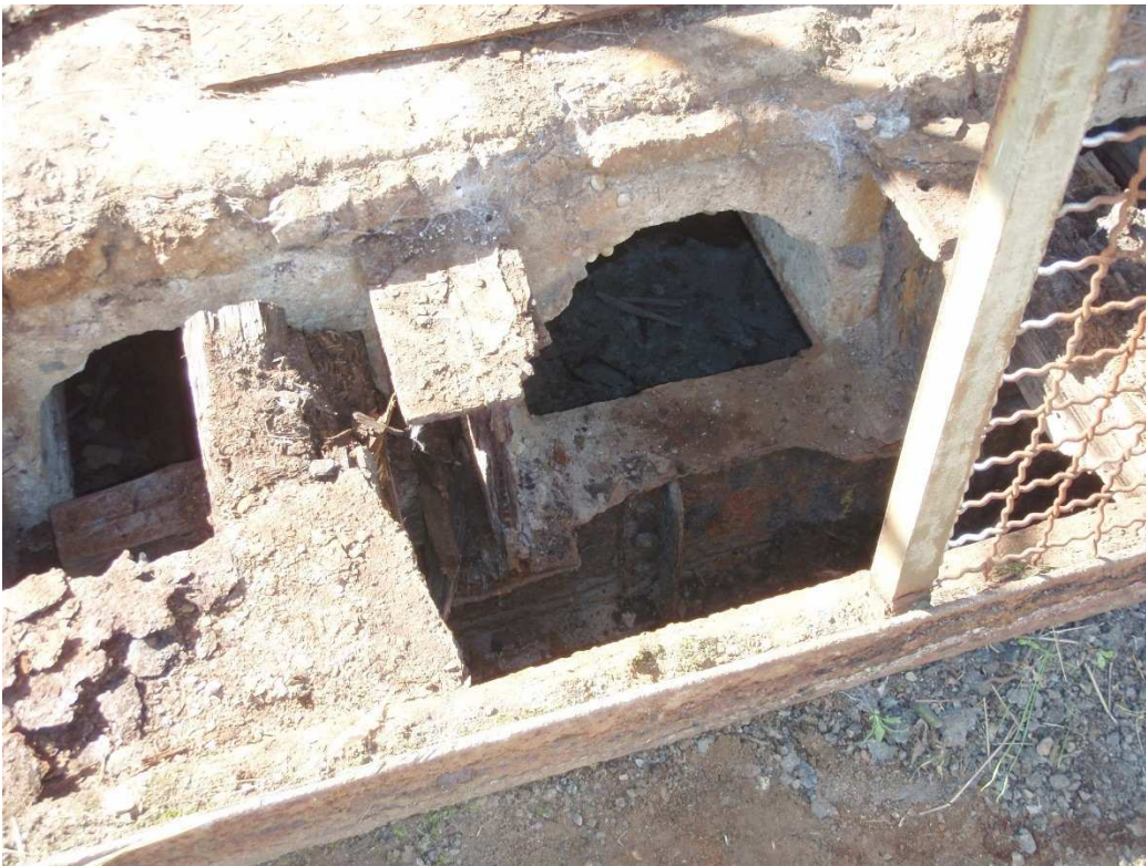
Abbildung 3: Blick auf die korrodierten Haupt- und Endträger der Schachtabdeckung (nördl. Teil)
