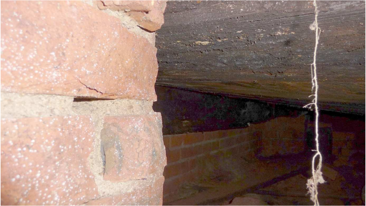
Abbildung 38: Blick in den Hohlraum von Pos. 2 im südöstlichen Bereich von Schacht Asse 1 (Blickrichtung SO-NW)
