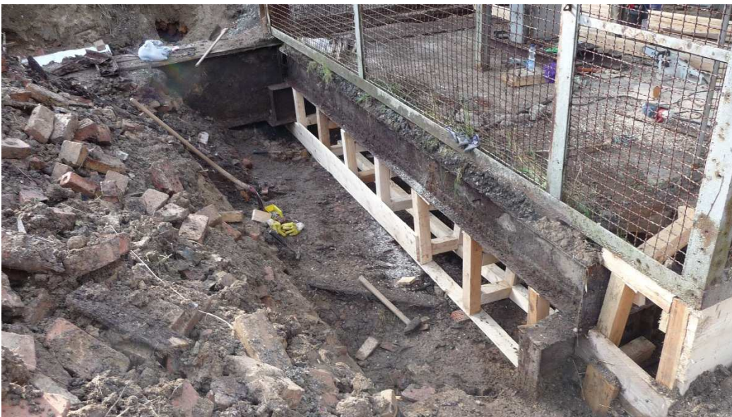
Abbildung 20: Blick auf die Holzkonstruktion unterhalb des östlichen Hauptträgers der Schachtabdeckung (Blickrichtung NO-SW)
