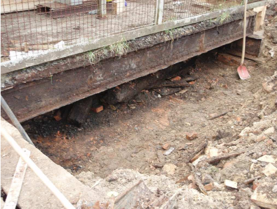
Abbildung 17: Blick auf den freigelegten äußersten Hauptträger der Schachtabdeckung im östlichen Bereich von Schacht Asse 1 (Blickrichtung SO-NW)
