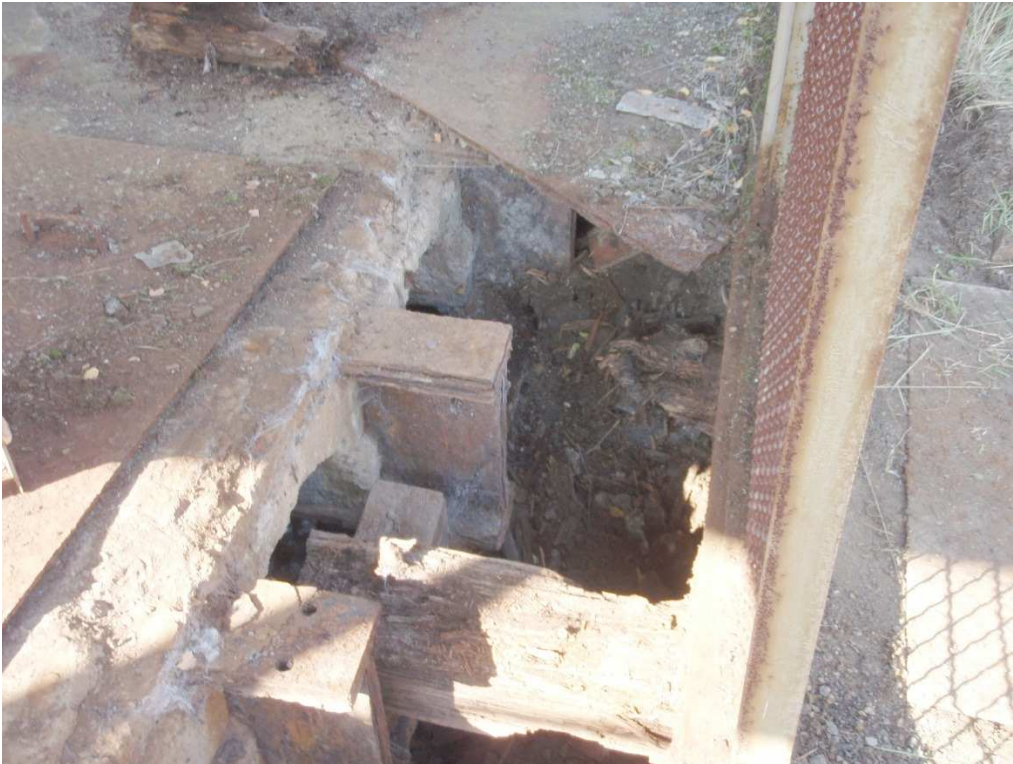
Abbildung 2: Blick auf die korrodierten Hauptträger und verrotteten Holzabstützungen der Schachtabdeckung im nördlichen Bereich von Schacht Asse 1
