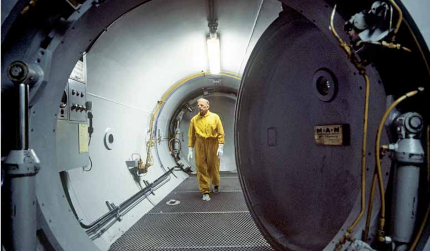
Die Tür in eine Welt ohne Stromzähler schien weit offenzustehen: ein Mitarbeiter in der Personenschleuse zum Reaktorraum des Kraftwerks Lingen in Niedersachsen (1978)
