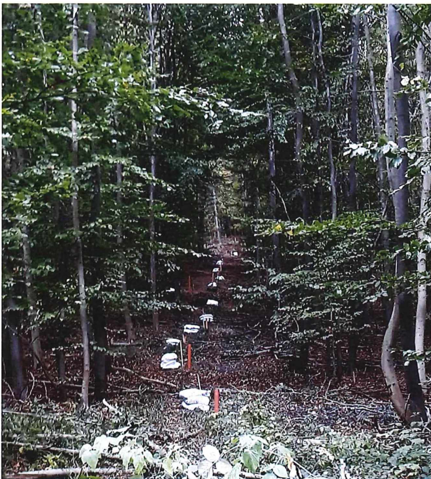
Abbildung 16: Anregungslinie entlang einer Rückegasse im Asse-Wald mit für die Sprengseismik vorbereiteten Bohrungen. Die Bohrungen sind verrohrt (orangenes Kunststoffrohr), Säcke mit Bentonit liegen zur späteren Verfüllung der Bohrungen bereit.
