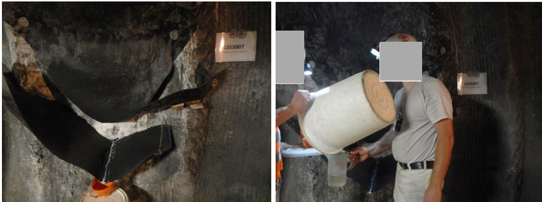
Bild 55 und 56: S-Stoß an der Begleitstrecke auf der 553-m-Sohle, L553007.
