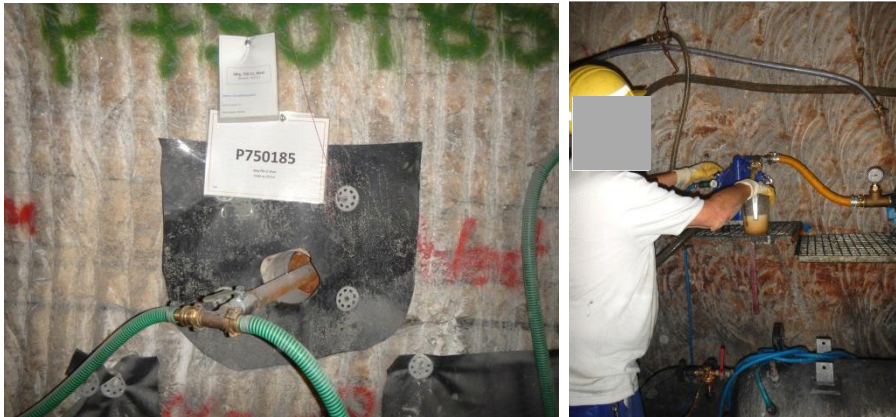
Bild 44 und 45: Lösungsaustritt in der Erkundungsbohrung 750-11 West auf der 750-m-Sohle, P750185.
