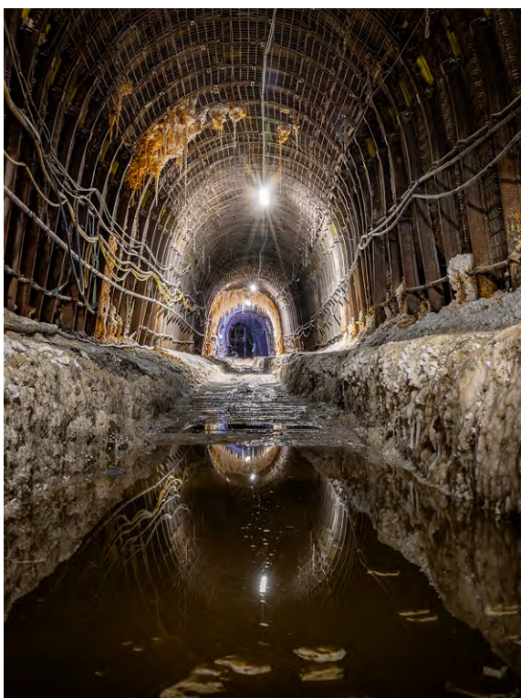
Salzwasseraustritt in der Gleitbogen- ausbaustrecke in 725 Meter Tiefe
