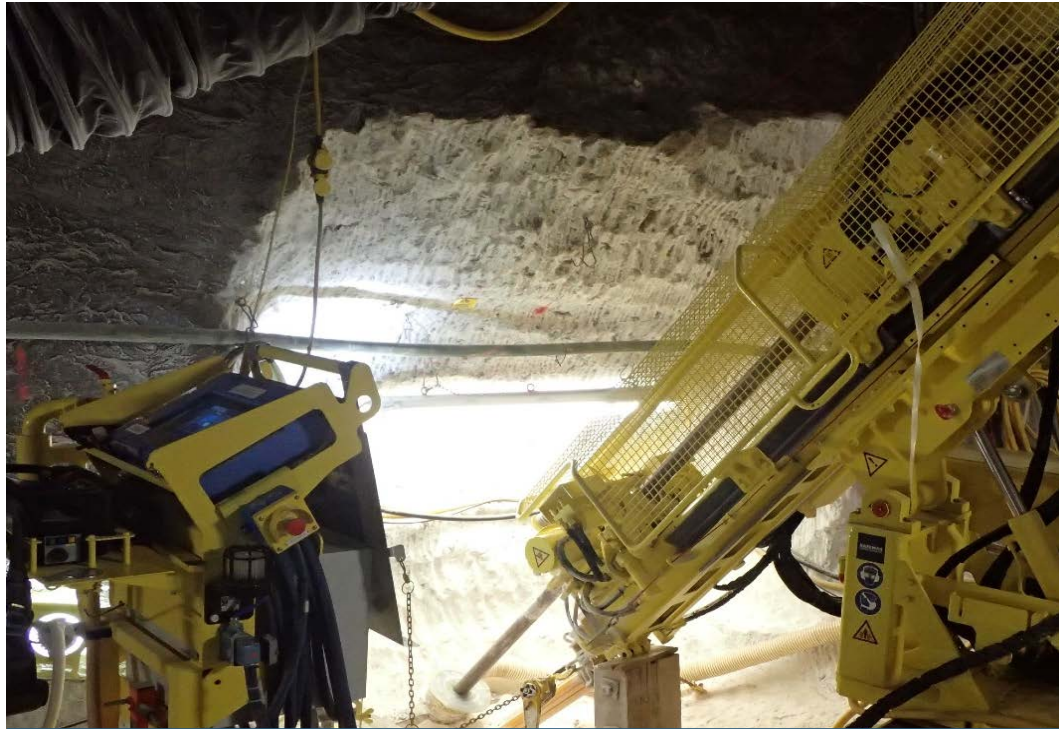
Lieferung, Montage und Inbetriebnahme der explosionsgeschützten Bohranlage vom Typ HAZEMAG
