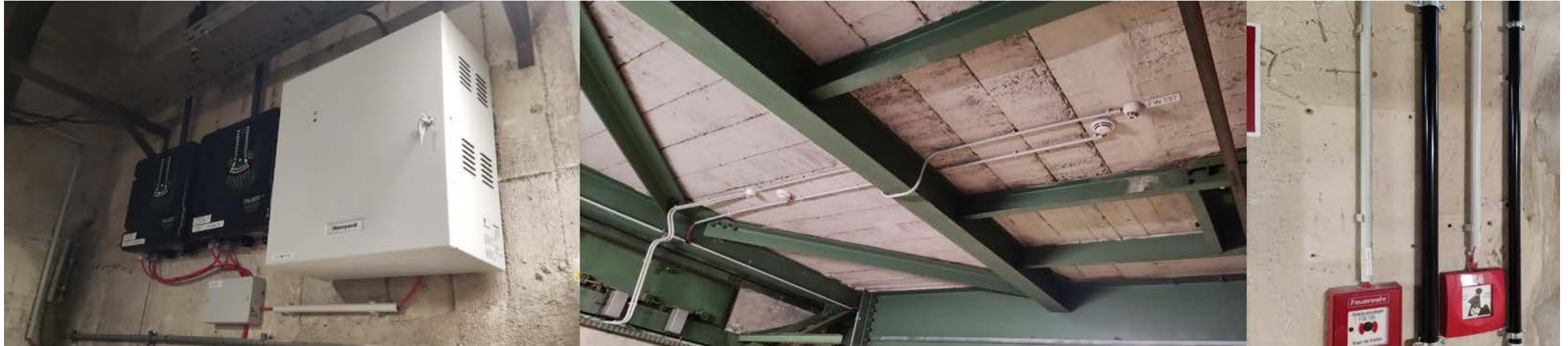
Paralleler Aufbau neuen Anlage zur bestehenden Brandmeldeanlage zur Absicherung der durchgängigen Überwachung
