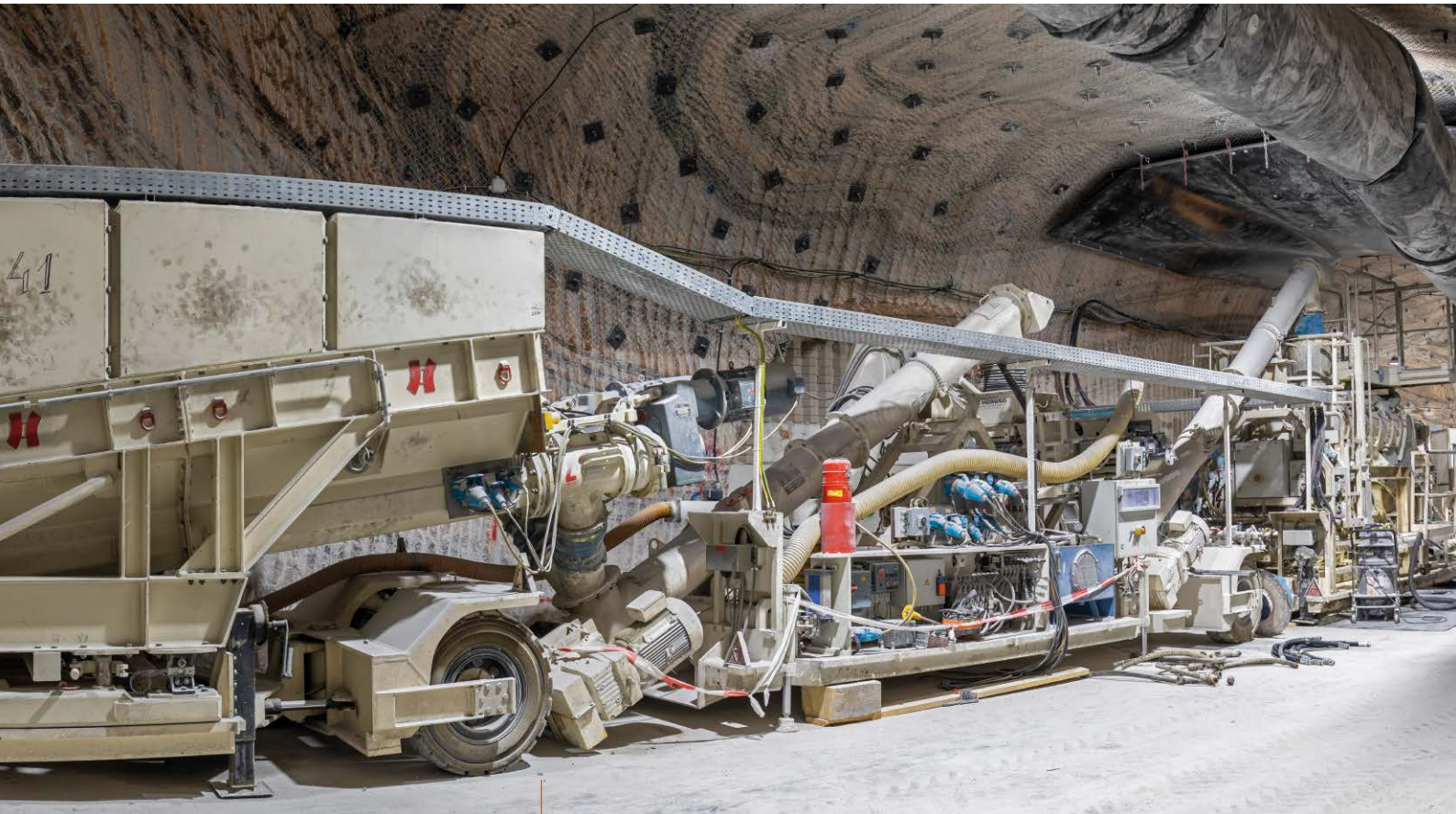
Schachtanlage Asse: Semimobile Baustoffanlage auf der 750-m-Sohle
