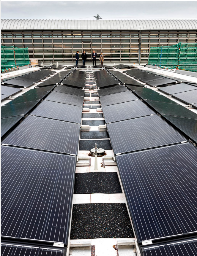
Photovoltaikanlage auf dem Dach am Standort Peine
